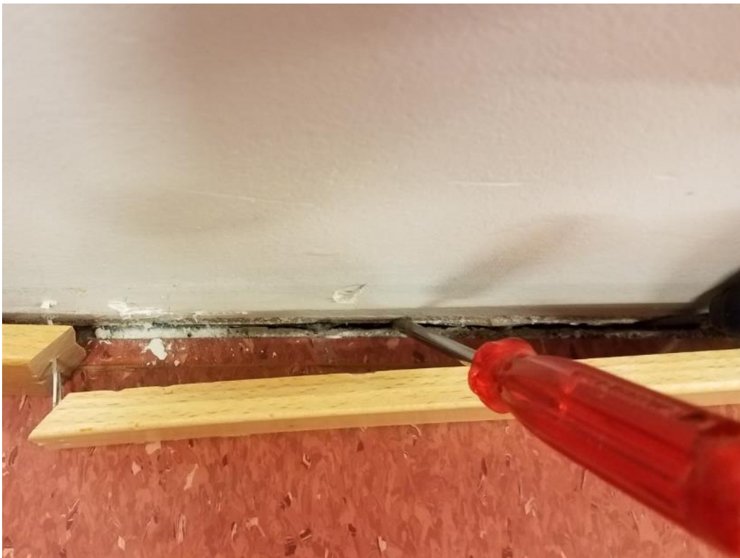
Kuva 18. Lattialaatan ja seinän väliset raot on jätetty saumaamatta elastisella saumamassalla.
