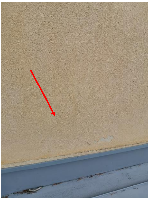
Kuva 16. Seurakuntasalin vesikaton vastaisessa seinässä havaittiin halkeilua.
