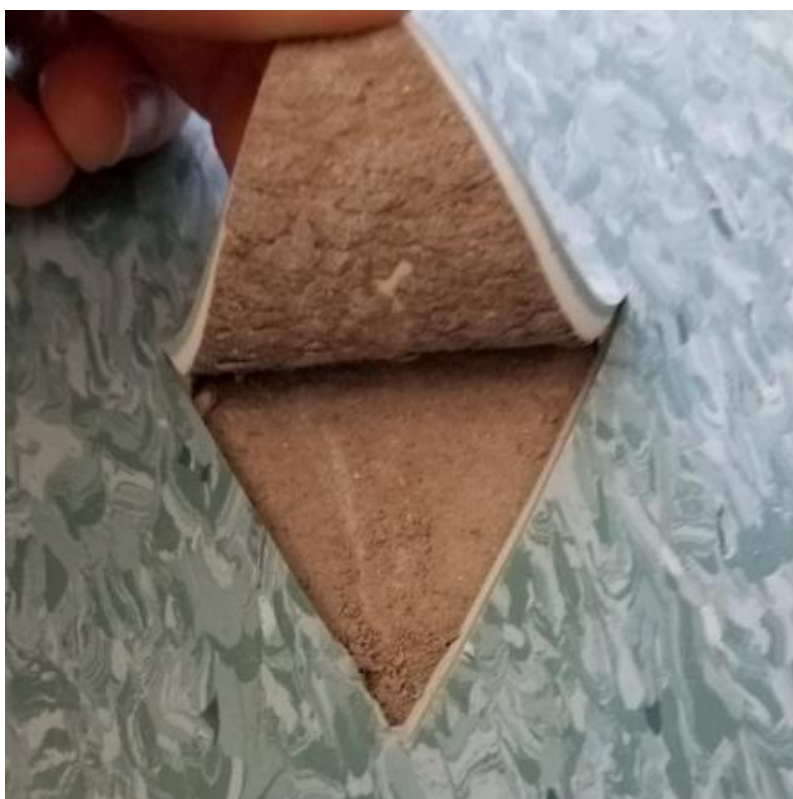
Kuva 22. Muovimaton alapuoleinen tasoite on vaurioitunut.
