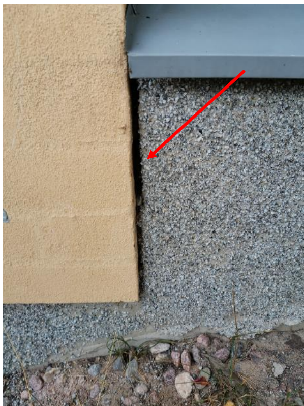
Kuva 13. Nuorisotalon länsisivulla havaittiin avoin sauma.
