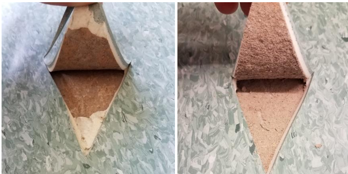
Kuvat 37 ja 38. Vasemmalla Maanmenninkäisten pikkuhuoneen viiltomittaus. (VM11) Tasoite on murentunut. Oikealla Metsänhaltijoiden lepohuoneen viiltomittaus (VM12). Tasoite on murentunut.
