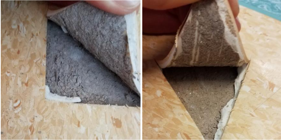
Kuvat 33 ja 34. Vasemmalla Joenjättien lepohuoneen viiltomittaus (VM7). Tasoite on murentunut. Oikealla Joenjättien ison tilan viiltomittaus (VM8). Tasoite on murentunut.
