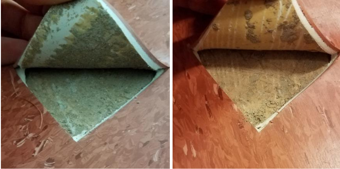
Kuvat 39 ja 40. Vasemmalla seurakunnan päiväkerhon tilan viiltomittaus (VM14). Tasoite on murentunut. Oikealla seurakunnan tiloissa toimivan varhaisnuorten kerhon tilan viiltomittaus (VM15). Tasoite on lievästi murentunut.
