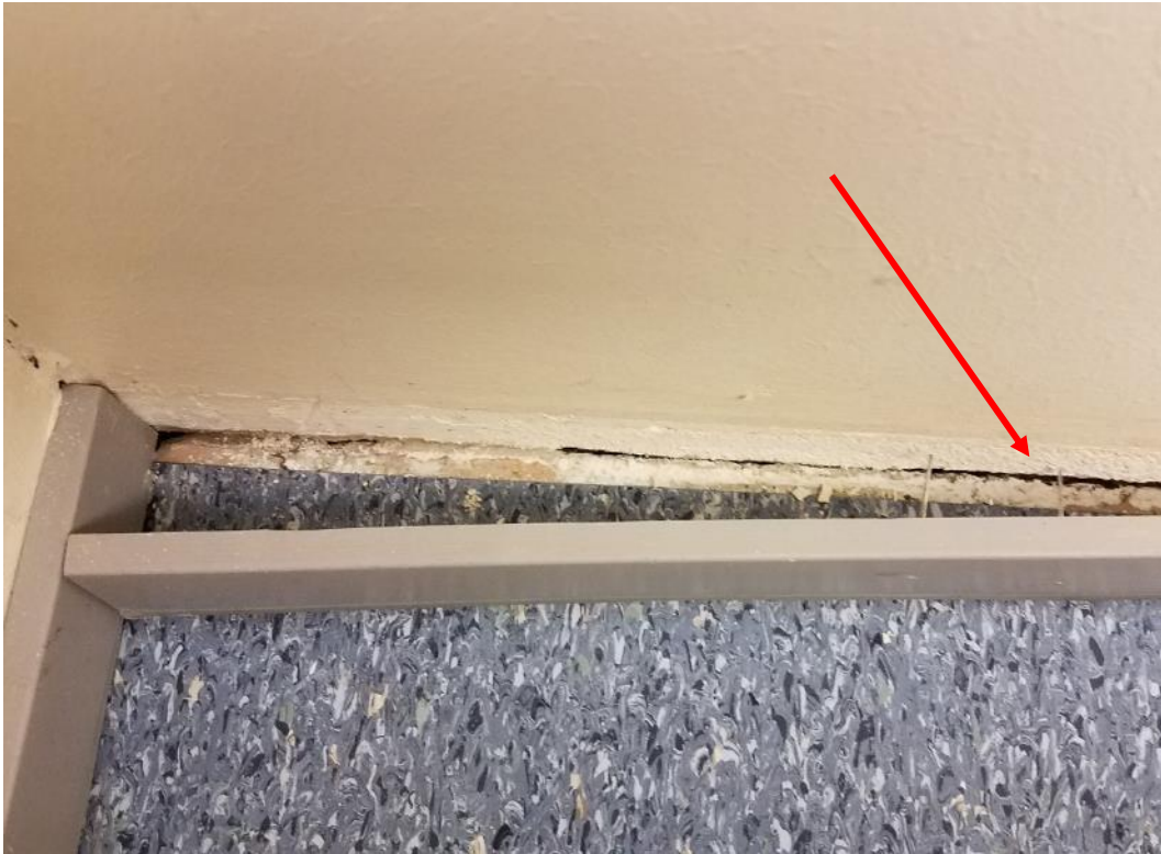
Kuva 17. Lattialaatan ja seinän väliset raot on jätetty saumaamatta elastisella saumamassalla.
