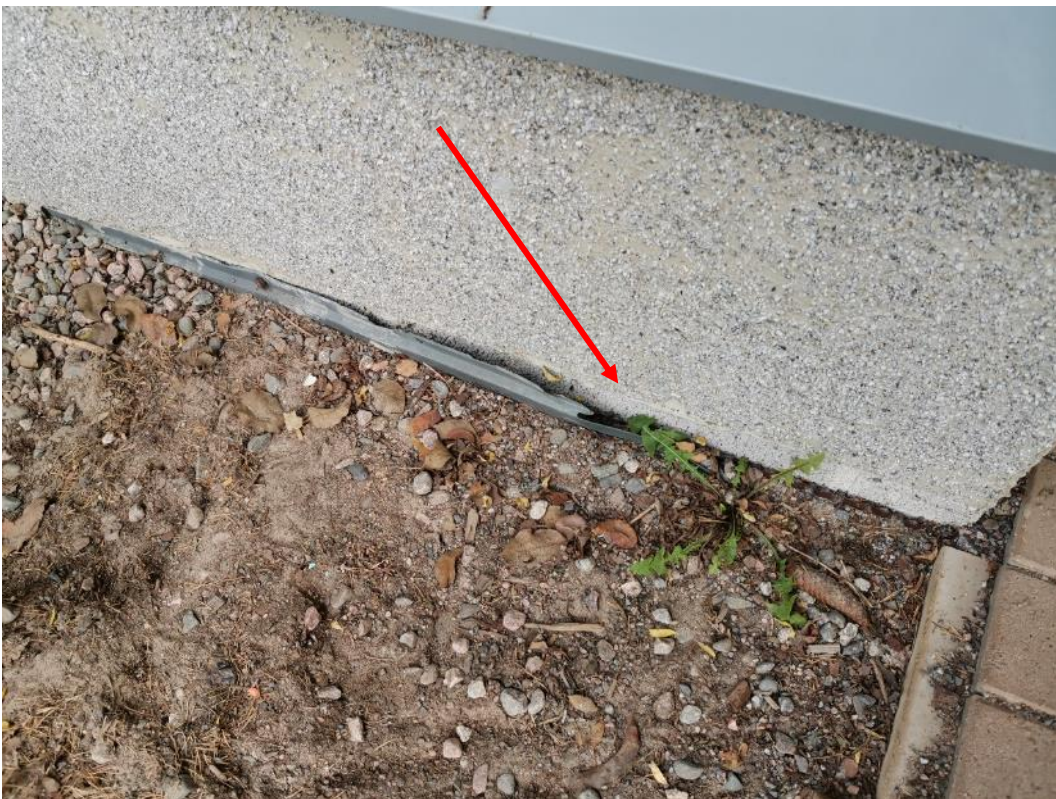
Kuva 12. Perusmuurilevytyksen ylälistä on paikoin irronnut kiinnityksestään.
