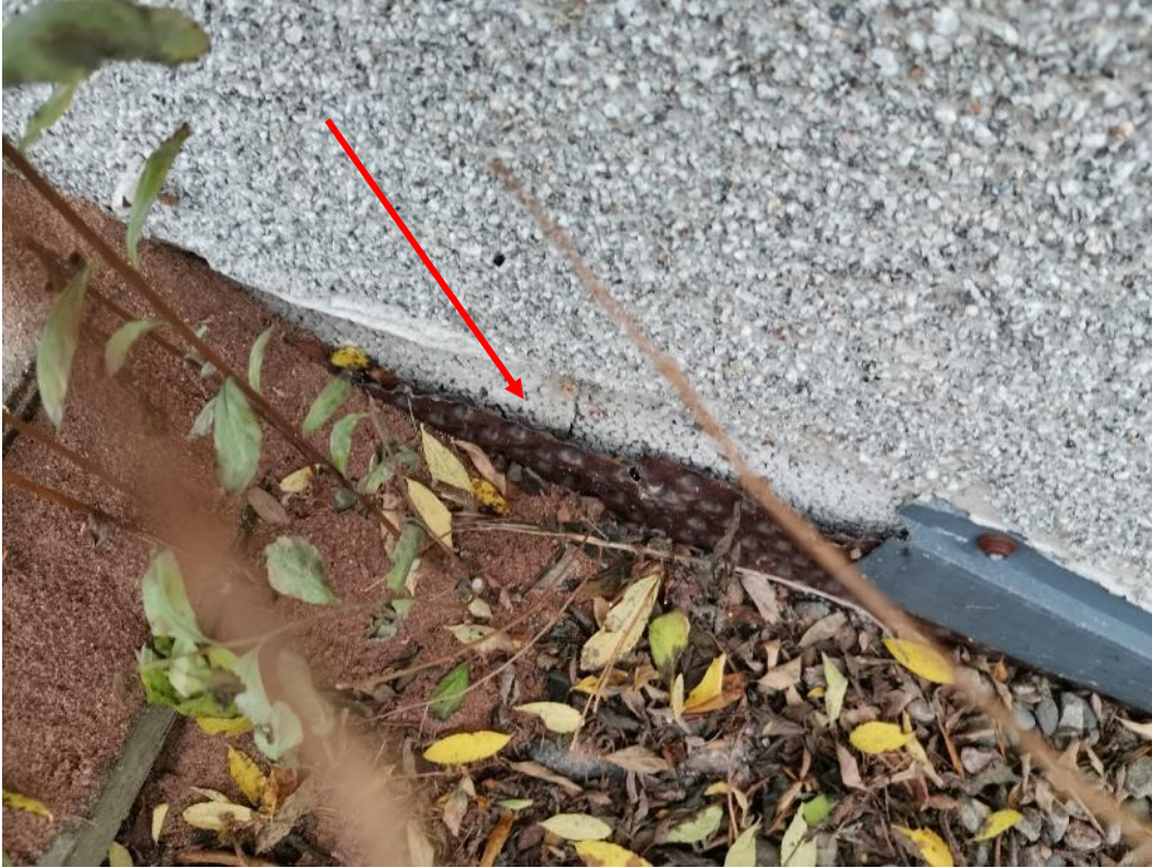
Kuva 11. Perusmuurilevytyksen ylälistä on paikoin vaurioitunut.
