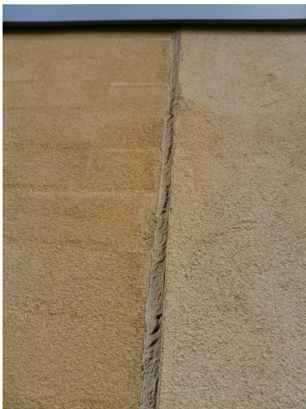
Kuva 14. Elastiset saumamassat ovat paikoin ikääntyneet ja vaurioituneet.
