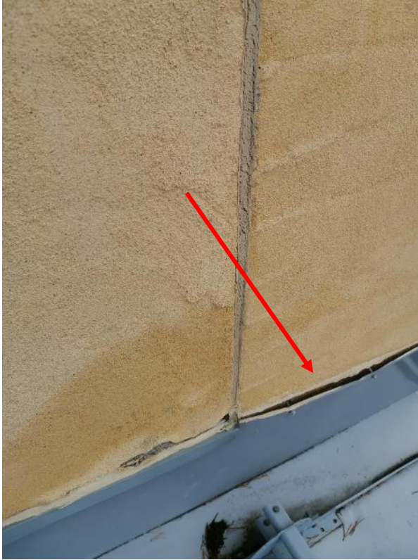
Kuva 23. Vesikattojen pellitysten ylösnostot ovat irronneet kiinnityksestään.
