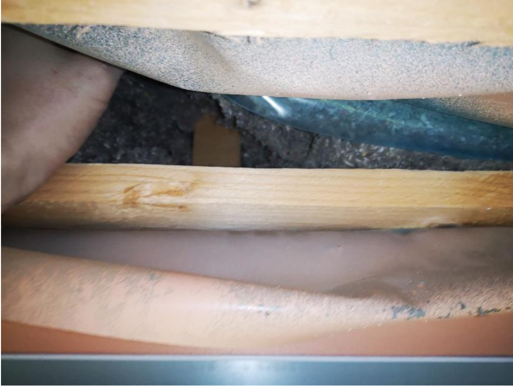
Kuva 9. Yläpohjan höyrynsulkumuovia ei ole asennettu tiiviisti ulkoseinärakenteen höyrynsulkumuoviin.
