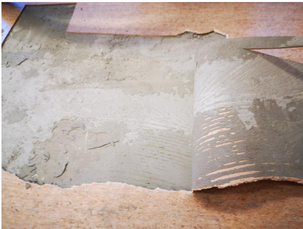
Kuva 11. Lattian muovimaton kiinnitys alustaan oli heikko ja muovimattojen alapuoleinen taasoite oli vaurioitunut.
