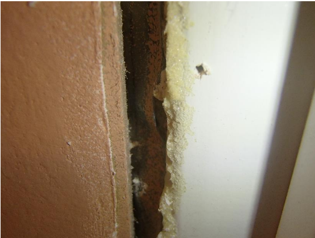
Kuva 10. Ikkunarakenteiden liitos höyrynsulkumuoviin ei ole tiivis.
