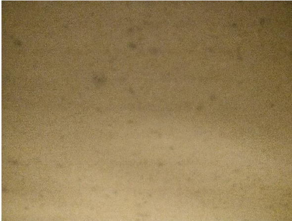
Kuva 14: Yläpohjan tuuletus paikoin puutteellinen, aluskatteessa mikrobikasvustoa.
