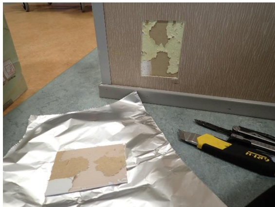
Kuva 6: Käytävän 145 ja wc:n välinen seinä. Käytävällä ja wc:ssä tunkkaista hajua. Seinän muovimattossa havaittiin samaa hajua.
