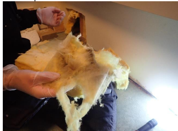
Kuva 11: Ulkoseinä, ikkunan alla olevassa eristeessä ilmavuodosta aiheutunutta tummentumaa.
