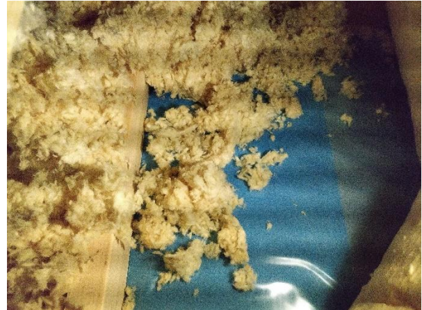
Kuva 15: Yläpohjan höyrynsulkumuovit limitetty hyvin.
