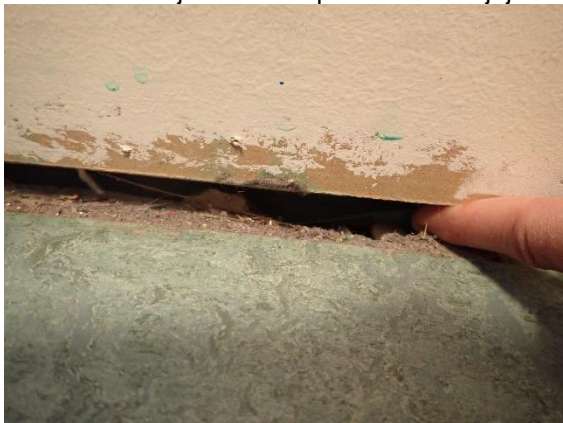
Kuva 10: Ulkoseinän alaosa. Jalkalistan takana rakoa kipsilevyn ja lattian välissä.
