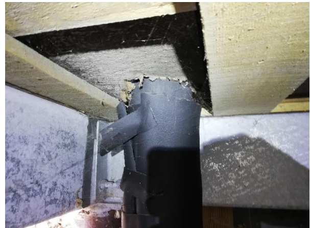
Kuva 17: Tuulettuvassa ryömintätilassa läpivientien tiivistykset paikoin puutteellisia.
