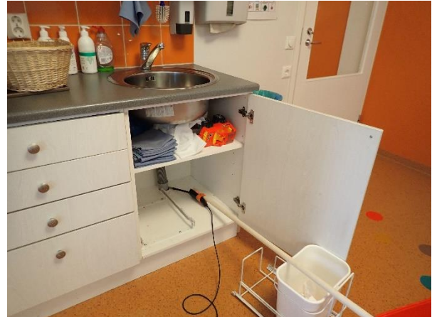
Kuva 15: Ilmavuotokohtia havaittiin läpivientien kohdalla.
