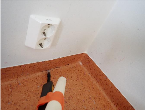
Kuva 14: Pistemäisiä ilmavuotokohtia havaittiin muovimattohalkeamista.
