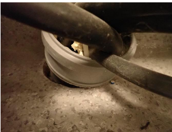
Kuva 18: Läpivienti sähköpääkeskuksesta alapohjaan ei ole tiivis (käytävä 108).
