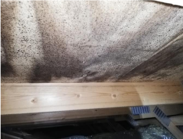
Kuva 24: Yläpohjan tuuletus puutteellinen, kermin alla olevissa kattolevyissä mikrobikasvustoa.
