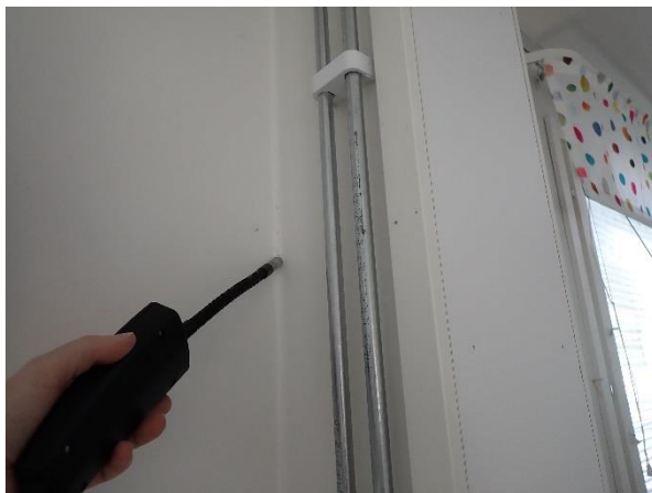
Kuva 21: Tila 134, ulkoseinien elementtisaumojen kohdilla havaittiin runsasta ilmapuotoa.
