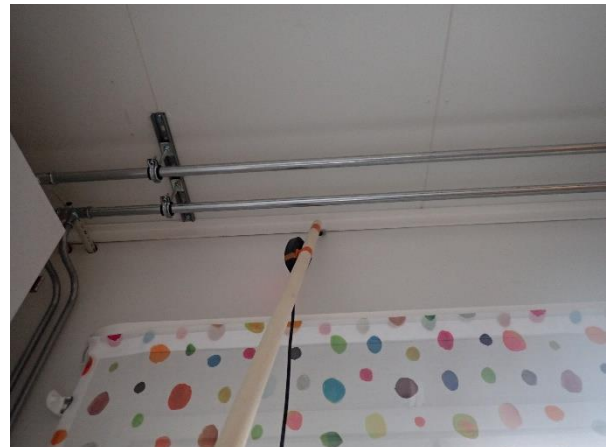
Kuva 29: Tila 117, yläpohjan eristetilasta havaittiin ilmapuotoa katto- ja seinäliittymistä.
