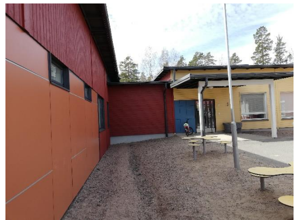
Kuva 4: Maanpinta viettää paikoin rakennukseen päin.
