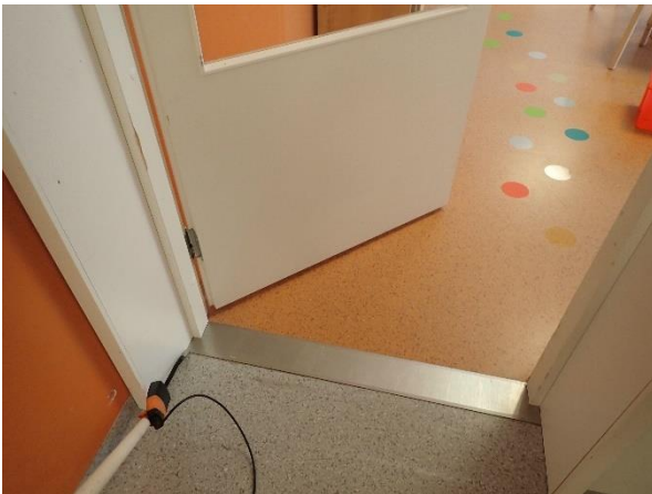
Kuva 16: Ilmavuotoa havaittiin elementtiliittymien kohdilta.
