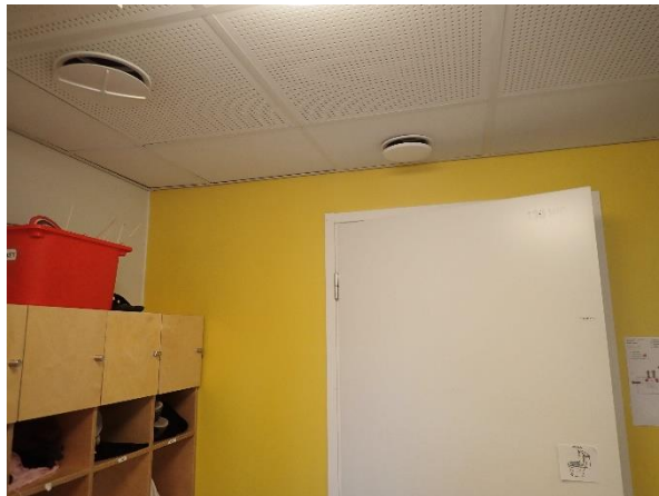
Kuva 40: WC 130 edessä havaittu mikrobiperäistä hajua. Kohdalla lähekkäin poistoilmapäätelaitteet.
