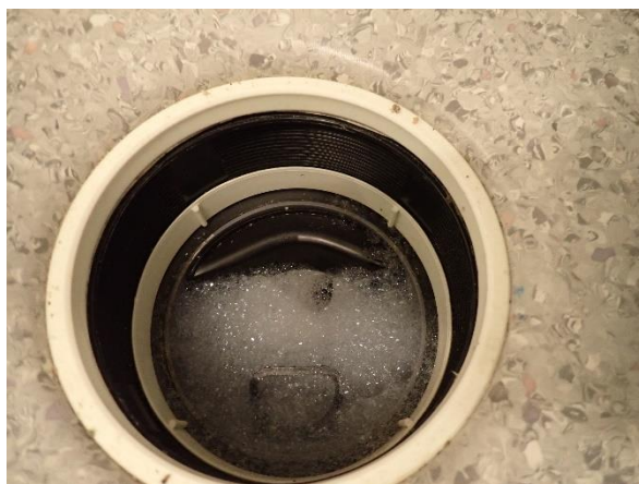
Kuva 42: WC 130, hajua aiheutui myös lattiakaivosta, vaikka kaivo oli puhdas.
