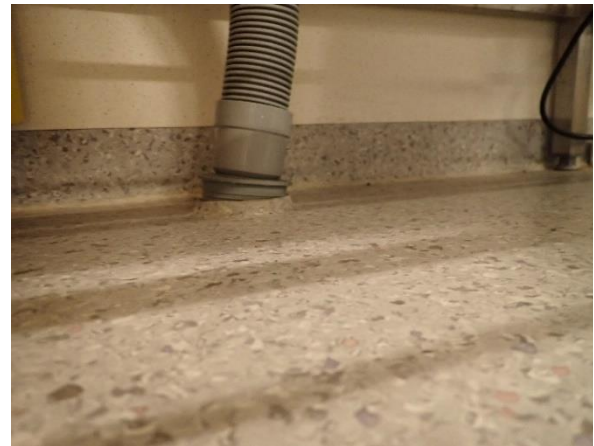
Kuva 41: WC 130, hajua aiheutui todennäköisesti huonosti kiinni olevasta viemäriputkesta.
