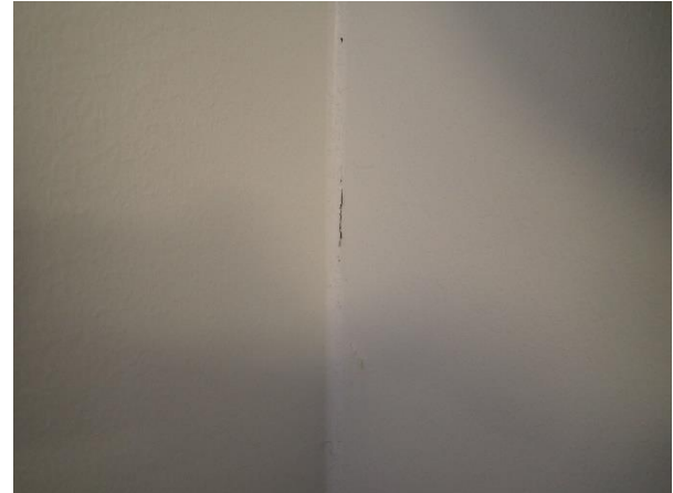
Kuva 20: Paikoin ulkoseinäliittymissä on halkeamaa.
