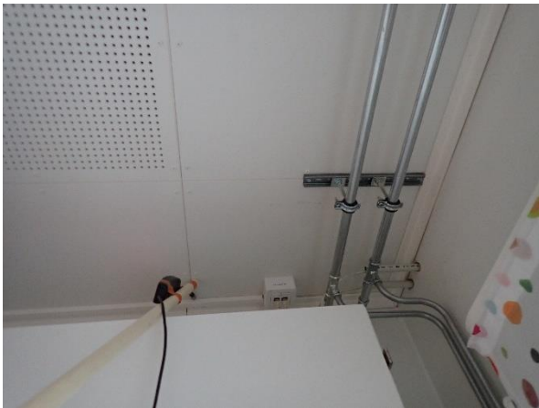
Kuva 28: Tila 117, yläpohjan eristetilasta havaittiin ilmapuotoa kattolevyjen saumoista.
