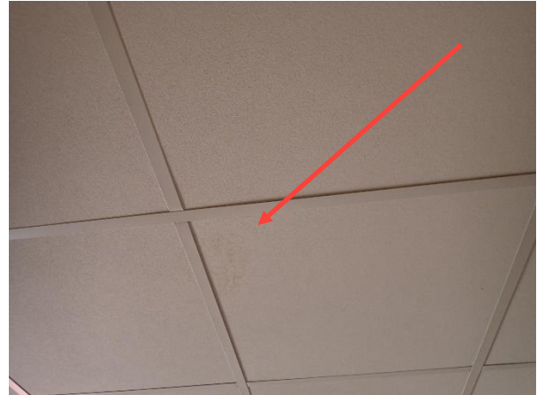
Kuva 39: Taukotilassa 109 vanhoja vuotojälkiä kattolevyissä.
