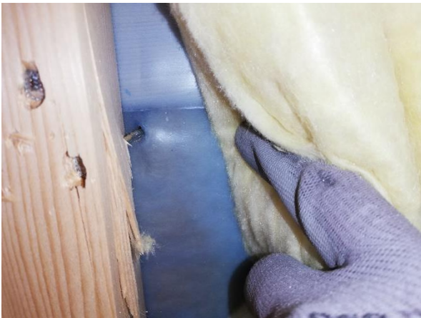
Kuva 26: Yläpohjan höyrynsulkumuovissa on epätiiviyttä (naulat lävistäneet muovin).
