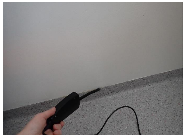
Kuva 22: Tila 135, ulkoseinän eristetilasta havaittiin ilmapuotoa paikoin lattia- ja seinäliittymän muovimaton takaa.
