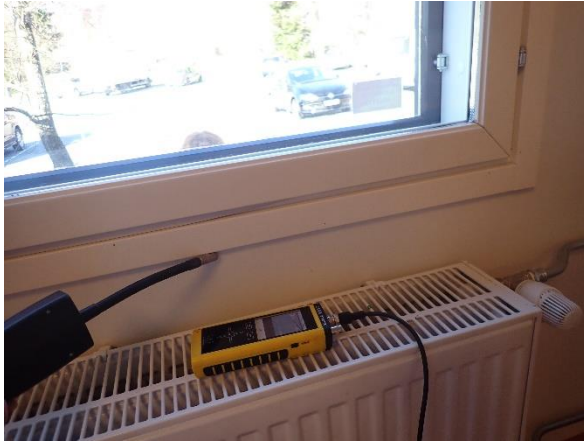
Kuva 23: Tila 118, ulkoseinien ja ikkunoiden liittymistä runsasta ilmavuotoa.
