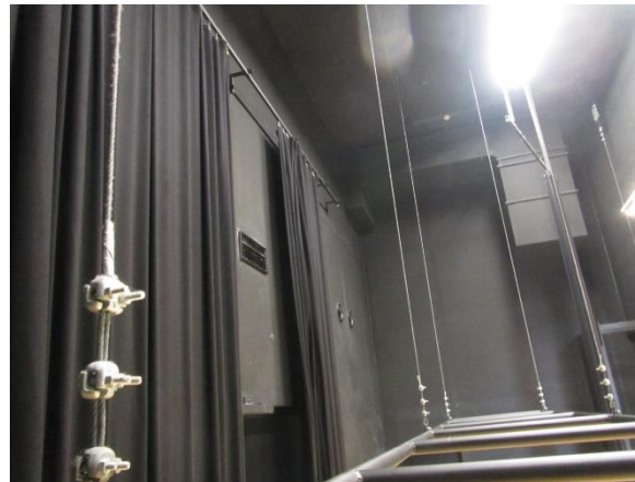
Kuva 5. Yleiskuva verhoista ja tulo/poistoilmakanavista. Kuvassa tutkija on siirtänyt verhot pois kanavien edestä.
