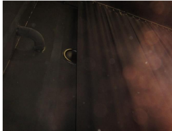
Kuva 3. Näyttämöverho peittää puolet poistoilmakanavista.
