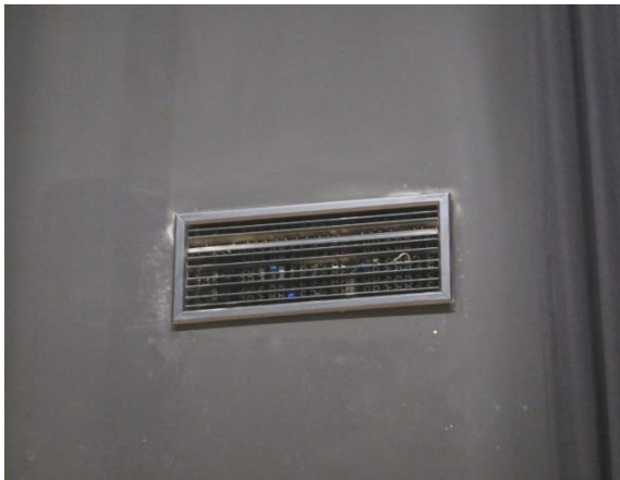
Kuva 4. Tuloilmakanavan ympärillä pölyä.
