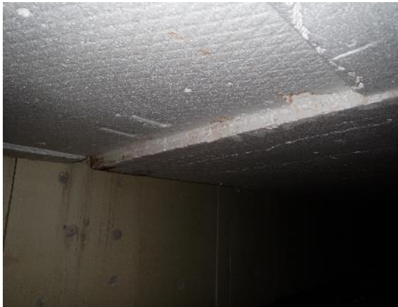
Kuva 3. Päiväkodin ryömintätilan EPS-eriste irronnut ontelolaataston alapinnasta.
