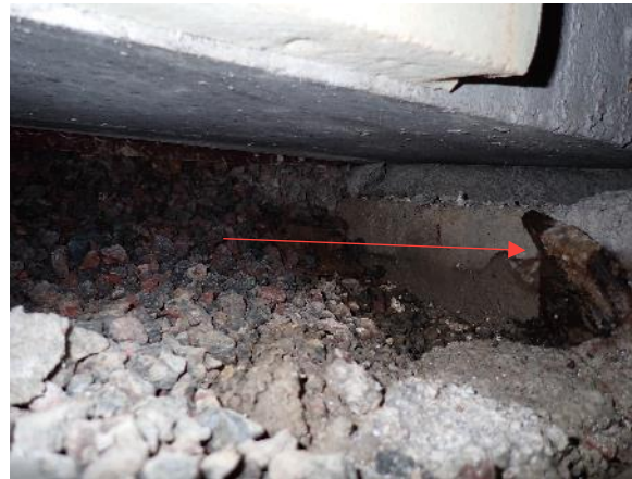
Kuva 4. Päiväkodin ryömintätilan yksittäisissä kohdissa havaittiin lahovaurioituneita muottilautoja.
