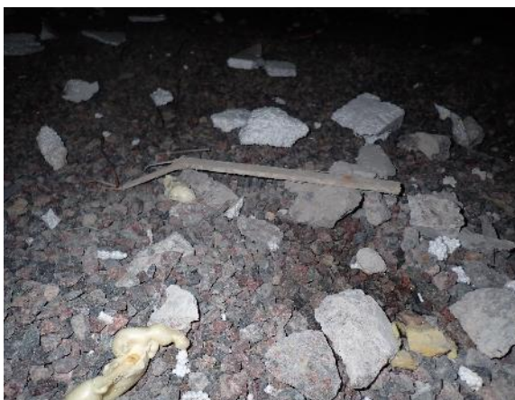
Kuva 5. Päiväkodin ryömintätilassa rakennusjätettä.
