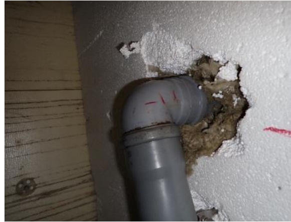
Kuva 2. Päiväkodin ryömintätilan läpiviennit olivat paikoittain epätiivisiin näköisiä. Lisäksi osassa läpivientejä havaittiin tummunutta mineraalivillaa.
