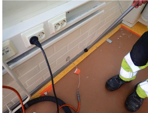
Kuva 20. Alipaineistettuna ulkoseinän ja alapohjan liittymän alueella ilmavuotoa.
