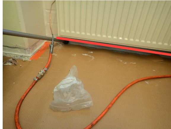
Kuva 4. Normaalitilassa ja alipaineistettuna alapohjan ja ulkoseinän liittymän alueella havaittiin merkittävää ilmapuotoa.
