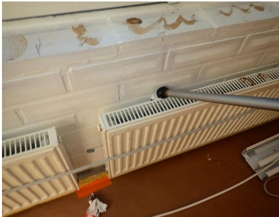
Kuva 12. Alipaineistettuna patterikannakkeen kiinnityksestä havaittiin pistemäinen ilmavuoto.
