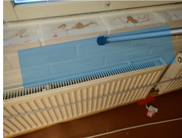
Kuva 11. Alipaineistettuna ikkunan alla seinärakenteen yläosassa havaittiin ilmavuotoa useasta kohdasta.
