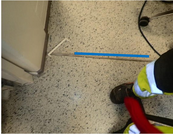
Kuva 3. Normaalitilassa ja alipaineistettuna havaittiin ilmapuotoa alapohjan liikuntasaumassa (/maton saumassa).
