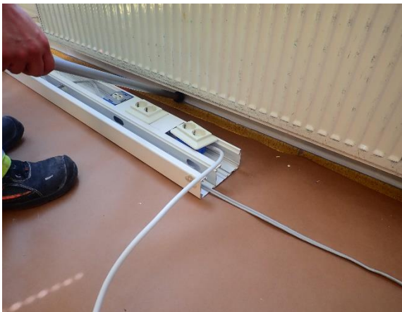
Kuva 21. Alipaineistettuna ulkoseinän ja alapohjan liittymän alueella ilmavuotoa.
