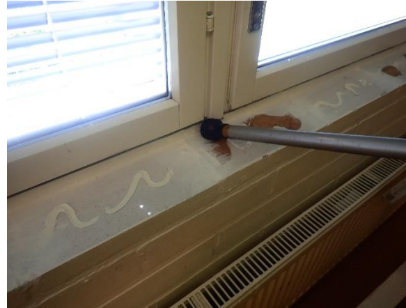
Kuva 15. Alipaineistetussa tilassa ikkunaliittymässä havaittiin vähäistä vuotoa.
