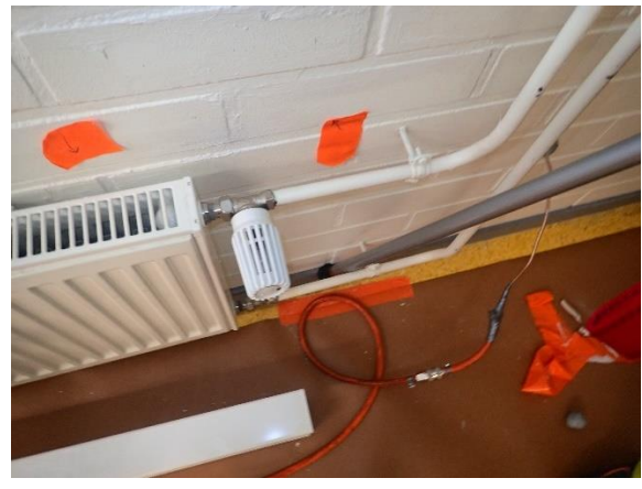
Kuva 17. Normaalissa / alipaineistetussa tilassa ulkoseinän ja alapohjan liittymän alueella havaittiin toistuvia ilmavuotoja.
