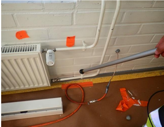
Kuva 14. Alipaineistetussa tilassa, patterin kannattimissa havaittiin pistemäisiä ilmavuotoja.
