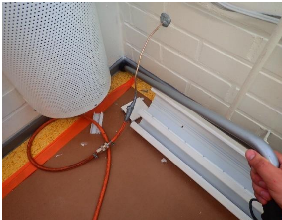
Kuva 16. Normaalissa / alipaineistetussa tilassa, pilarin ja seinän liitoskohdassa vähäistä ilmavuotoa.
