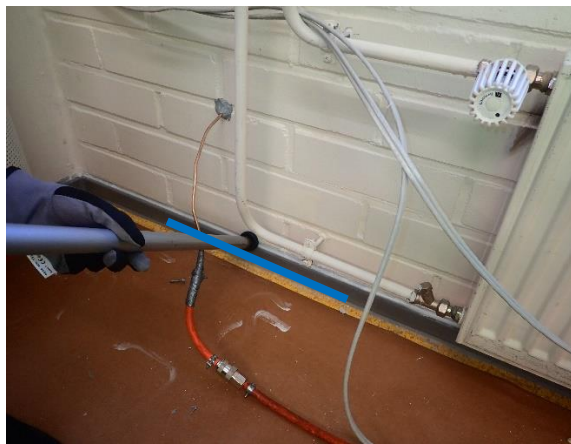
Kuva 7. Alipaineistetussa tilassa havaittiin vähäistä ilmavuotoa alapohjarakenteen ja ulkoseinän liittymässä.
