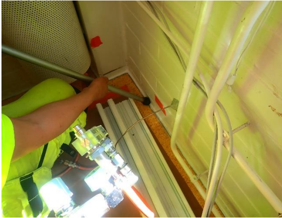
Kuva 19. Alipaineistettuna ulkoseinän ja alapohjan liittymän alueella ilmavuotoa.
