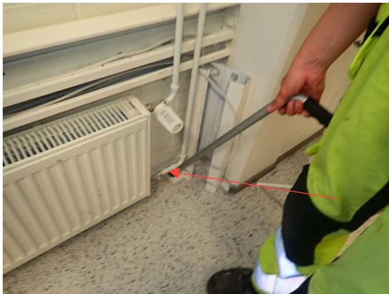
Kuva 5. Alipaineistettuna havaittiin vähäistä ilmapuotoa sähköjohtojen läpiviennissä.
