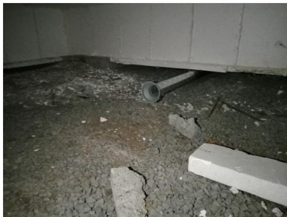
Kuva 2. Ryömintätilassa koneellinen poisto. Rakennusjätteitä olivat pääosin styroxit ja harjateräkset.
