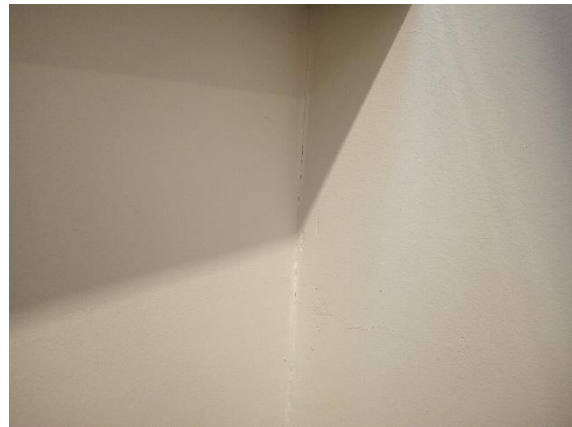
Kuva 5. Elastinen saumamassa halkeilee väliseinän ja ulkoseinän liittymässä.
