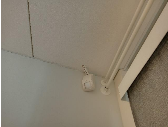
Kuva 7. Liiketunnistimen sähköjohtojen läpivienni ei näytä tiiviiltä.
