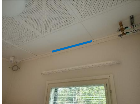
Kuva 9. Vähäistä ilmapuotoa yläpohjan ja ulkoseinän liittymässä, huoneen keskiosassa.
