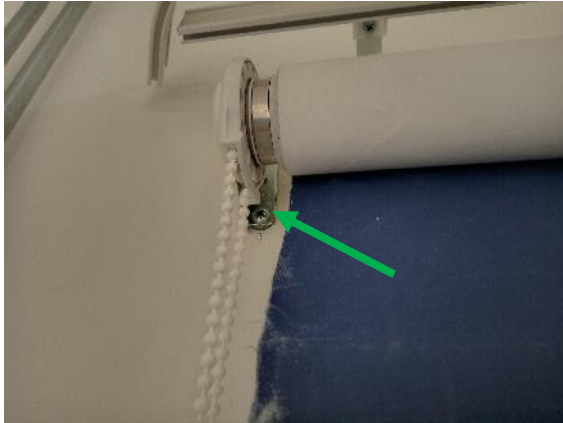
Kuva 17. Rullaverhon kiinnitysruuvien kohdalta pistemäistä ilmavuotoa.
