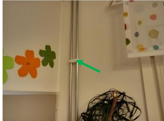
Kuva 3. Pistemäistä ilmvuotoa patterinkannakkeiden kohdalla.
