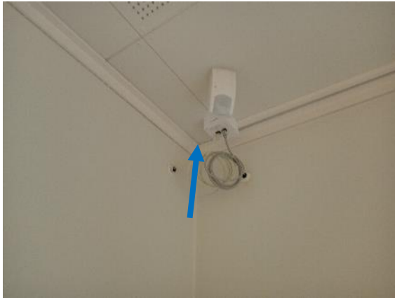
Kuva 10. Ulkoseinien ja yläpohjan välisessä liittymässä vähäistä ilmapuotoa seinän yläosassa.
