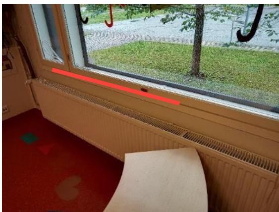
Kuva 6. Merkittävää ilmvuotoa ikkunan alaosan ja ulkoseinän liittymän kohdalta.
