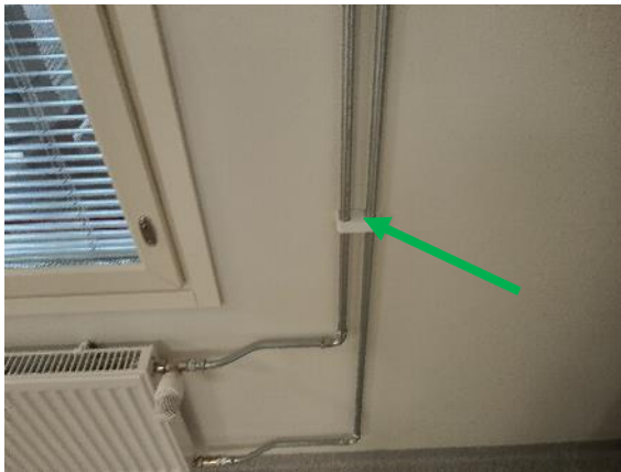
Kuva 19. Patterin vesiputkien kannakkeiden kohdalla pistemäistä ilmavuotoa.
