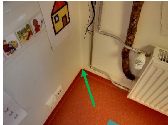
Kuva 5. Pistemäistä ilmvuotoa alapohjan ja ulkoseinän liittymästä.
