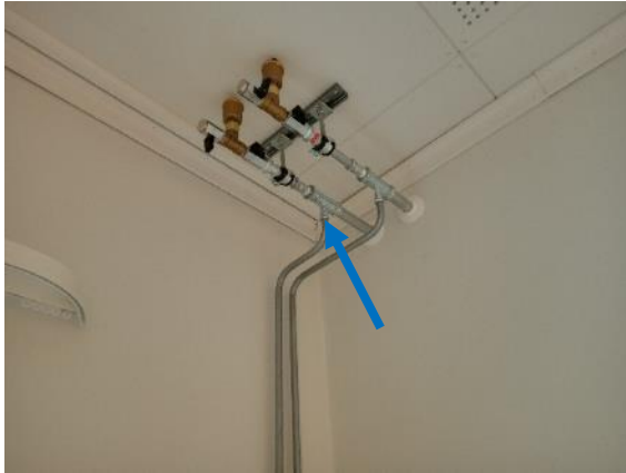
Kuva 8. Elementinliittymän kohdalla vähäistä ilmapuotoa seinän yläosassa.
