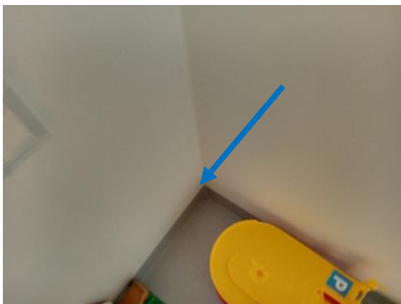
Kuva 12. Ulkoseinien välisessä liittymässä, lattian rajassa vähäistä ilmapuotoa.
