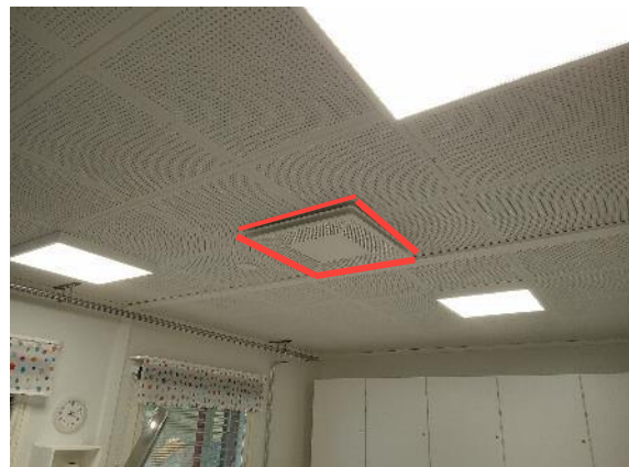
Kuva 22. Tuloilmakanavan ympäriltä merkittävää ilmavuotoa.
