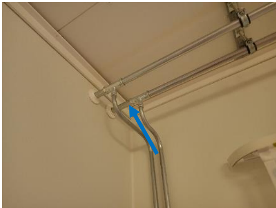
Kuva 4. Elementin liittymässä väliseinän yläosassa vähäistä ilmvuotoa.
