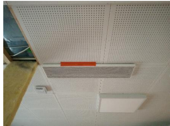
Kuva 15. Poistoilmakanavan kohdalta merkittävää ilmavuotoa.
