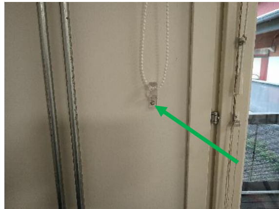
Kuva 20. Rullaverhon pallonauhan kiinnityskoukun kohdalta pistemäistä ilmavuotoa ruuvien kohdalta.
