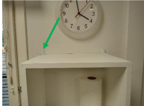
Kuva 18. Hyllyn kiinnitysruuvien kohdalta pistemäistä ilmavuotoa.
