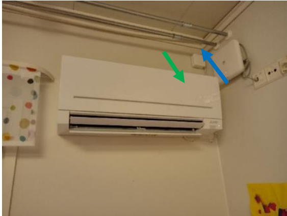
Kuva 2. Ilmalämpöpumpun läpiviennistä pistemäistä ilmvuotoa. Väliseinän ja ulkoseinän elementtiliittymän kohdalla vähäistä ilmvuotoa seinän yläosassa.
