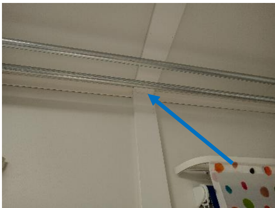
Kuva 21. Elementtisauman yläosasta vähäistä ilmavuotoa.
