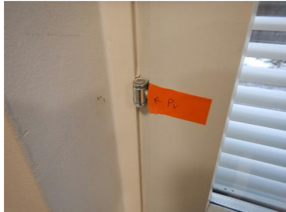
Kuva 5. Pistemäisiä vuotoja ikkunan saranoiden kohdista (4).
