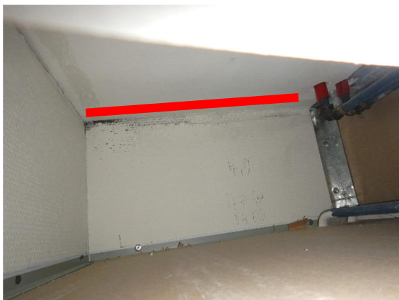
Kuva 21. Merkittävää vuotoa ulkoseinän ja välipohjan liittymästä. Kohdassa näkyvää rakoja. (4).
