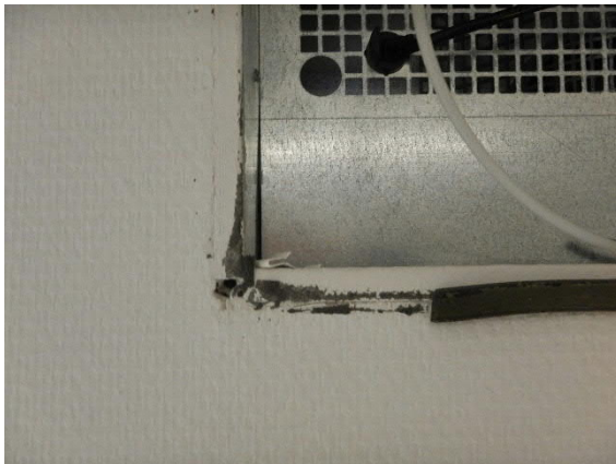
Kuva 31. IV-liitäntälaatikon läpiviennin reunoja ei ole tiivistetty käytävän puolelta eikä toimiston puolelta. Avonaisesta liitoksesta voi päästä mineraalikuituja huoneilmaan.
