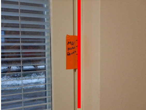
Kuva 24. Merkittävää vuotoa ikkunan ja ulkoseinän liittymästä (1).
