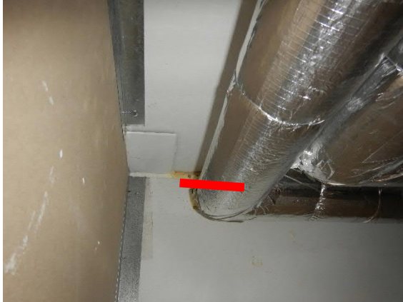
Kuva 12. Merkittävää vuotoa ulkoseinän ja välipohjan liittymästä. Kohdassa näkyvää rakoa ja kolo, jota tiivistetty uretaanilla (1).
