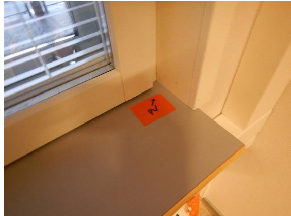
Kuva 30. Pistemäistä vuotoa ikkunan karmipuiden kulmaliitoksista (2).
