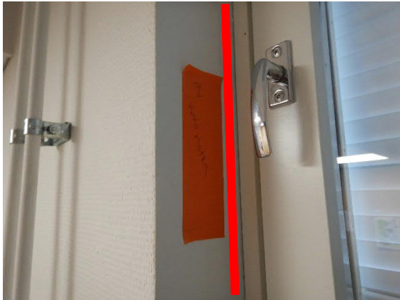
Kuva 19. Merkittävää vuotoa ikkunan ja ulkoseinän liittymästä (3).
