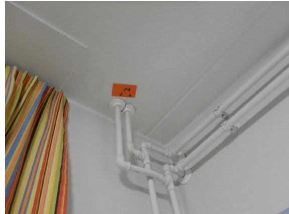
Kuva 27. Pistemäistä vuotoa patteriputkien ja välipohjan liittymästä (4).
