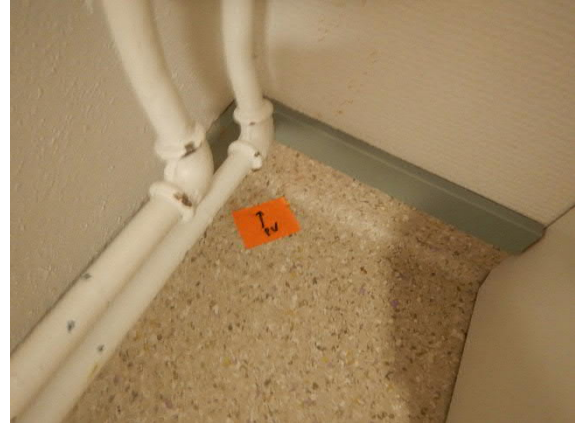
Kuva 25. Pistemäistä vuotoa muovimaton kulmasta (2).
