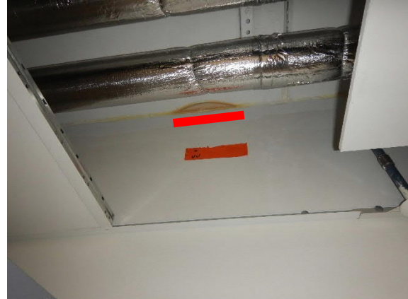
Kuva 13. Vähäistä vuotoa ulkoseinän ja välipohjan liittymästä. Kohdassa epämääräinen massaus (2).
