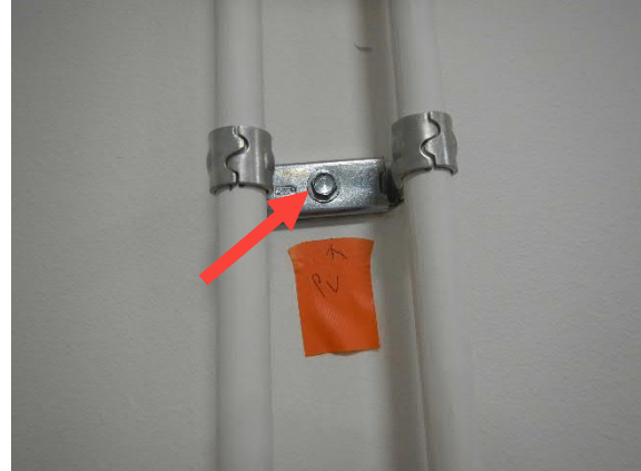
Kuva 9. Pistemäistä vuotoa patteriputkien seinäkiinnikkeestä (7).
