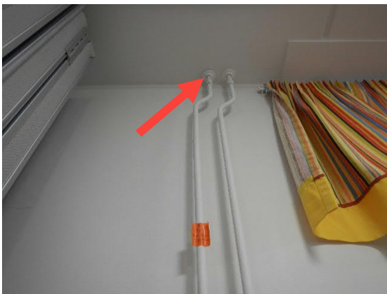
Kuva 6. Pistemäinen vuoto patteriputken ja välipohjan liittymästä (5).
