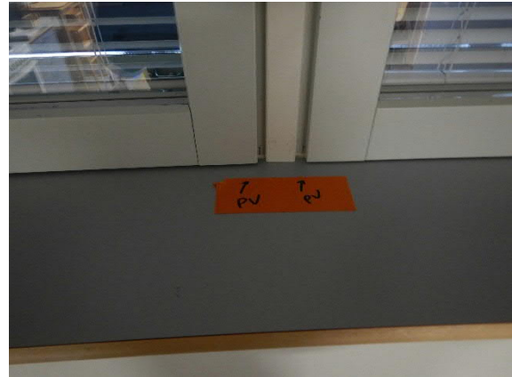
Kuva 15. Pistemäistä vuotoa ikkunan karmipuiden kulmaliitoksista (4).
