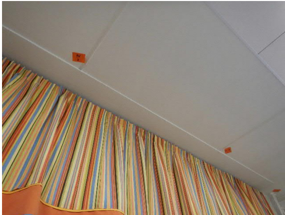
Kuva 26. Pistemäistä vuotoa ontelolaattojen saumakohdista teräspalkin päältä (3).
