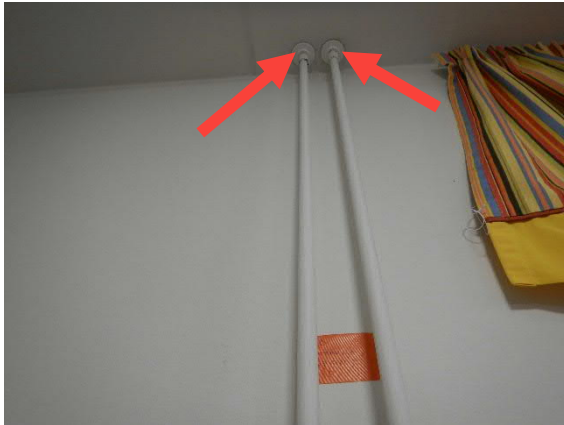
Kuva 10. Pistemäistä vuotoa patteriputkien ja välipohjan liittymästä (8).
