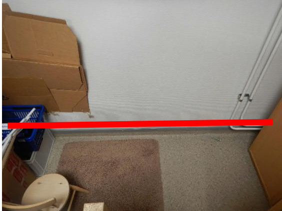
Kuva 17. Merkittävää vuotoa ulkoseinän ja muovimaton ylösnoston liittymästä (1).
