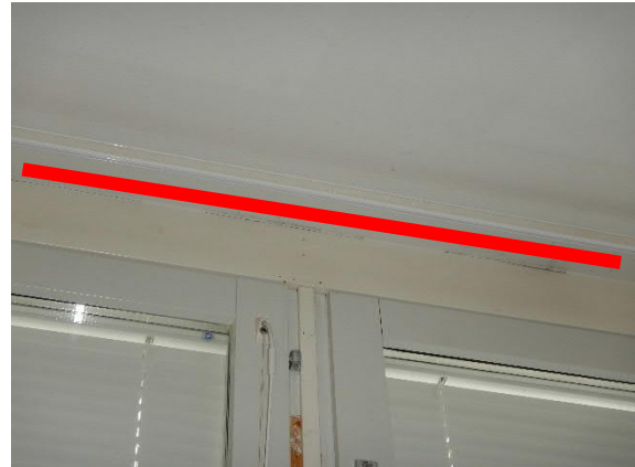
Kuva 20. Merkittävää vuotoa ikkunan ja välipohjan liittymästä. Saumamassassa halkeilua ja ilmavuodon aiheuttamaa tummentumaa (3).
