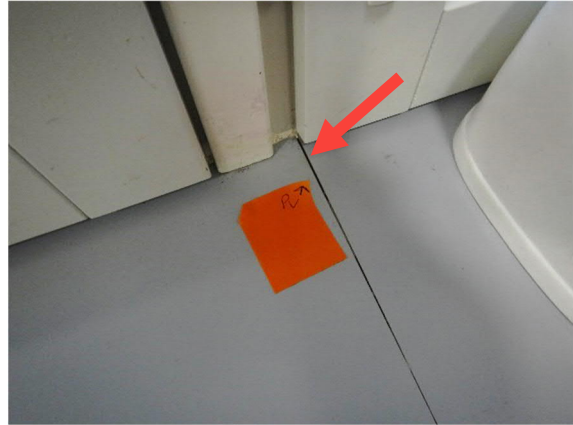
Kuva 3. Pistemäinen vuoto ikkunakarmien ja ikkunalaudan liittymästä (2).
