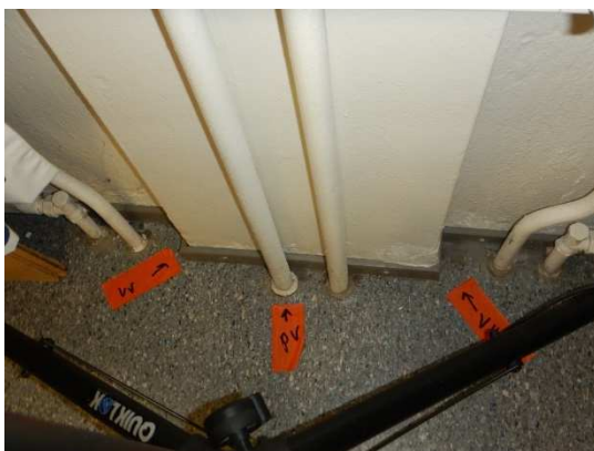
Kuva 5. 2 kpl vähäisiä ilmavuotoja pilarin kulmissa alapohjan liittymässä. Pistemäinen ilmavuoto putken läpiviennissä alapohjasta.
