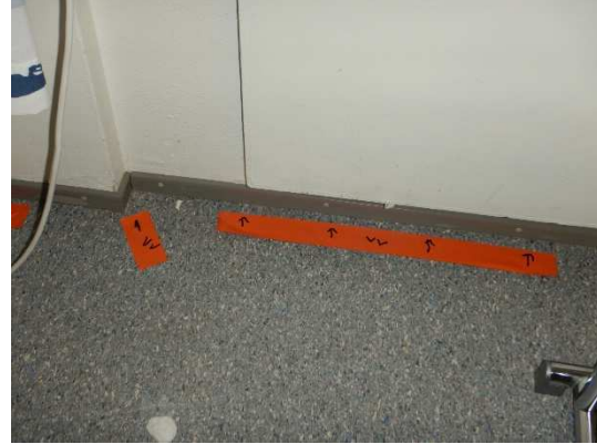
Kuva 2. Vähäinen ilmavuoto pilarin liittymässä ja ulkoseinän sekä alapohjan liittymässä noin 40 cm pitkä vähäinen ilmavuoto.
