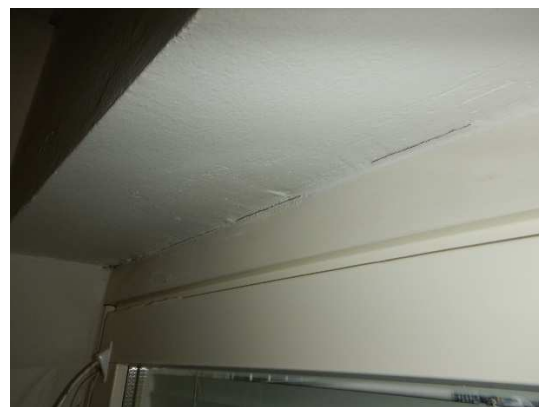
Kuva 6. Ikkunoiden elastisissa tiivistyksissä havaittiin epätiiveyttä.
