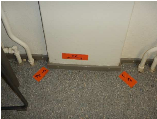
Kuva 3. Pistemäiset ilmavuodot pilarin kulmissa ja vähäinen ilmavuoto keskellä alapohjan liittymää.
