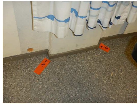
Kuva 4. Pistemäiset ilmavuodot pilarin ja alapohjan liittymässä.
