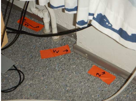
Kuva 1. Vähäinen ilmavuoto ulkoseinän ja alapohjan rajassa. Vähäinen ja pistemäinen ilmavuoto pilarin ja alapohjan liittymässä.
