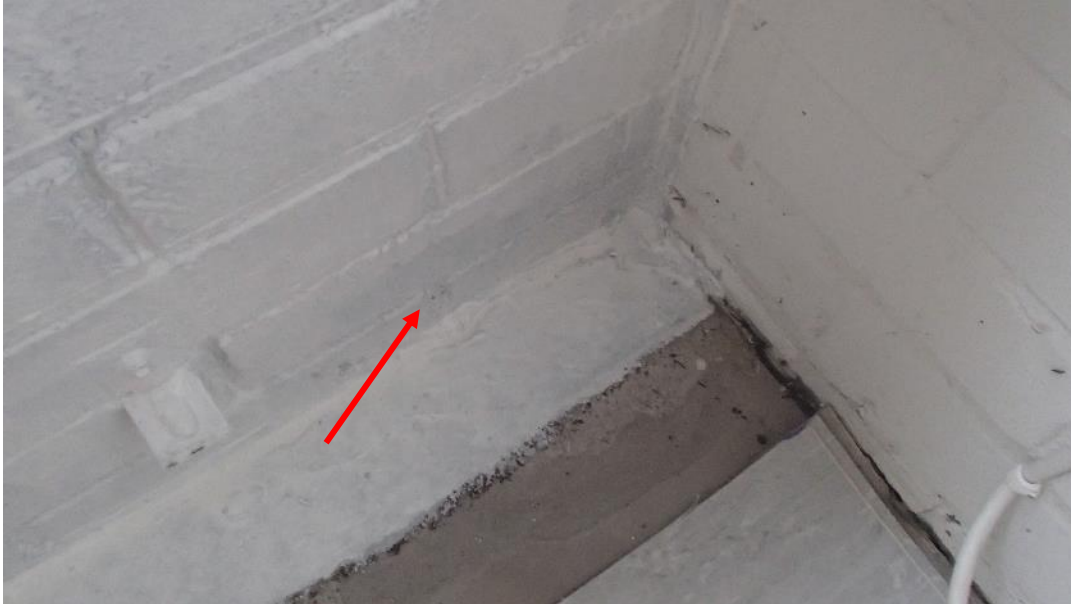
Kuva 4. Neulamainen vuotopaikka luokkahuoneessa 3B.
