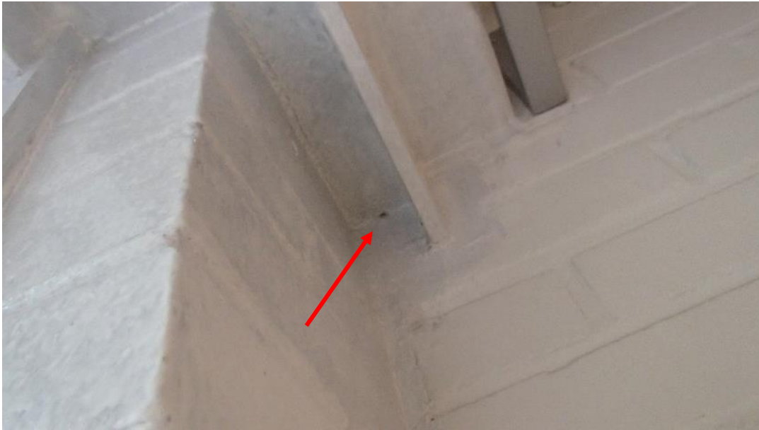
Kuva 6. Vuotopaikka luokkahuoneessa 5C levytyksen ja tiilimuurauksen rajapinnasta.
