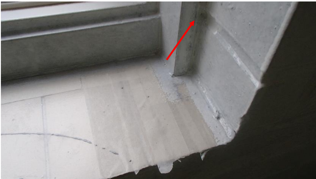
Kuva 5. Neulamainen vuotopaikka luokkahuoneessa 3A peitelistan ja tiilimuurauksen rajapinnasta.
