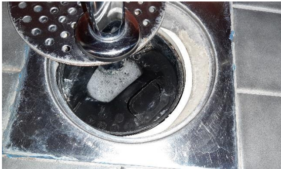
Lattiakaivon hajulukon kannen reunan tiiveys epätasainen. Vesilukko toimii.
