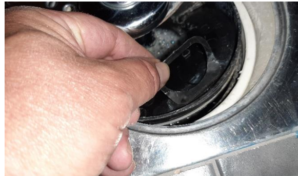
Hajulukko irtoaa kevyesti. Viemärikaasuja vuotaa ohi tiivistyksen.
