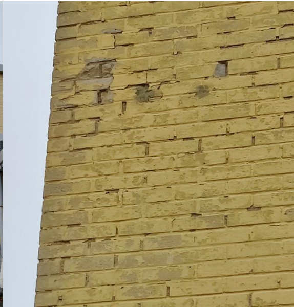
Kuva 2. Julkisivussa havaittiin rapaumaa ja paikoittain tiilipinnasta on lohkeillut palasia.
