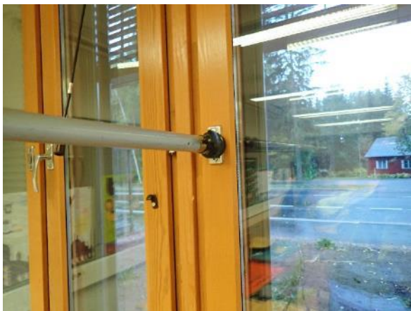
Kuva 20. Alipaineistettuna havaittiin merkittävää ilmapuotoa ikkunoiden avausmekanismien kohdalla.
