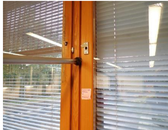
Kuva 14. Alipaineistettuna havaittiin pistemäinen ilmavuoto ikkunalistan kohdalla.
