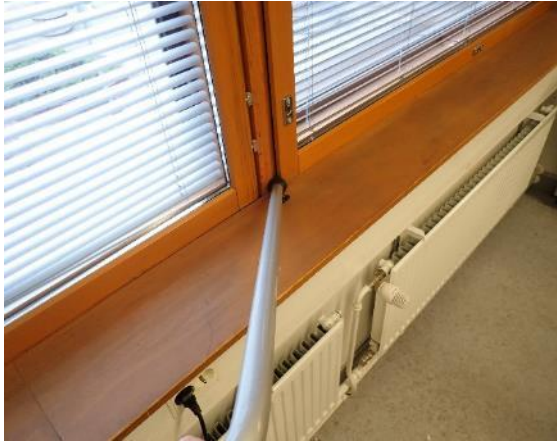
Kuva 11. Normaali-tilassa ja alipaineistettuna havaittiin vähäistä ilmavuotoa ikkunakarmien liittokohdassa.
