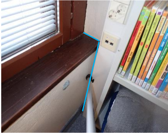
Kuva 8. Normaalitilassa ja alipaineistettuna havaittiin vähäistä ilmavuotoa pilarin ja ulkoseinänliittymässä sekä ikkunan ja pilarin liittymässä.
