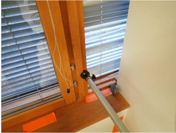
Kuva 16. Normaalityllassa ja alipaineistettuna havaittiin vähäistä ilmapuotoa ikkunakarmien liitoskohdassa.
