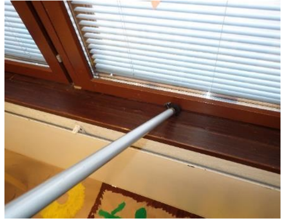
Kuva 5. Normaalityllassa ja alipaineistettuna havaittiin merkittävää ilmavuotoa ikkunan ja ulkoseinän liittymäkohdassa ikkunalaudan alueella.
