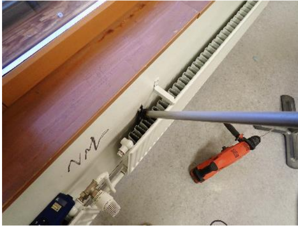
Kuva 22. Alipaineistettuna havaittiin pistemäinen ilmavuoto patterikannakkeessa.
