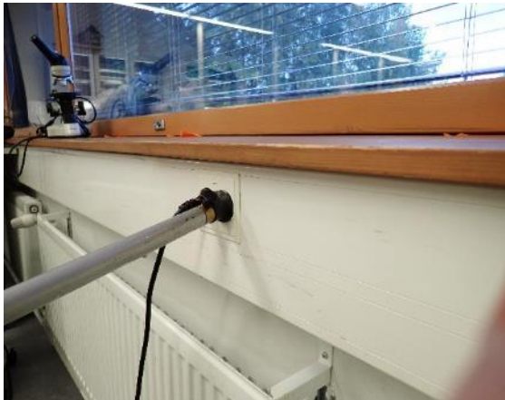
Kuva 13. Alipaineistettuna havaittiin vähäistä ilmavuotoa sähköpistorasiassa.
