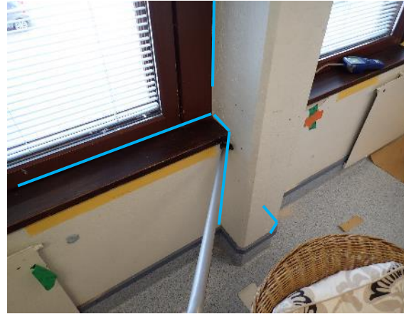
Kuva 9. Normaalitilassa ja alipaineistettuna havaittiin merkittävää ilmavuotoa ikkunan ja pilarin liittymäkohdassa ikkunalaudan alueella. Lisäksi vähäistä vuotoa havaittiin alipaineistettuna pilarin juurella.
