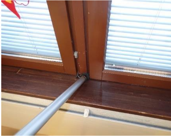
Kuva 4. Normaalityllassa ja alipaineistettuna havaittiin merkittävää ilmavuotoa ikkunakarmien liitoskohdassa. Samassa kohdassa merkittävää ilmavuotoa ikkunalaudan alueella. ks. tutkimuskartta
