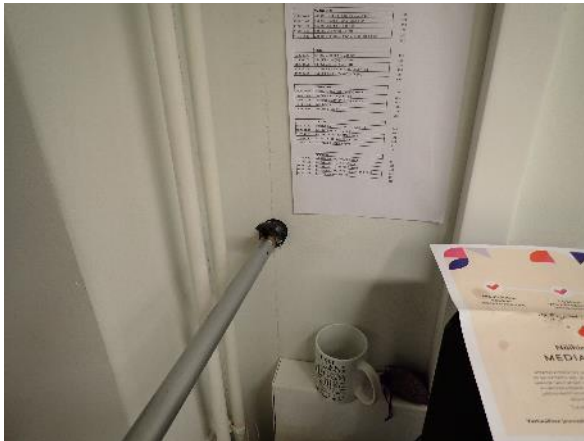
Kuva 18. Normaalityllassa ja alipaineistettuna havaittiin merkittävää ilmapuotoa väliseinän halkeamassa.
