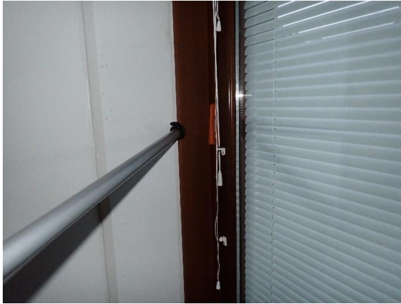
Kuva 24. Normaali- ja alipaineistettuna havaittiin merkittävää ilmavuotoa pilarin ja ulkoseinän, sekä ikkunan ja ulkoseinän liittymissä.
