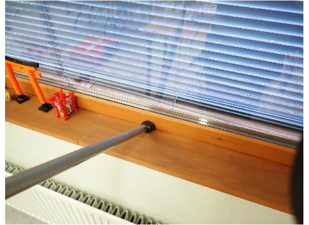
Kuva 17. Normaalityllassa ja alipaineistettuna havaittiin merkittävää ilmapuotoa ikkunan ja ulkoseinän liittymäkohdassa ikkunalaudan alueella.
