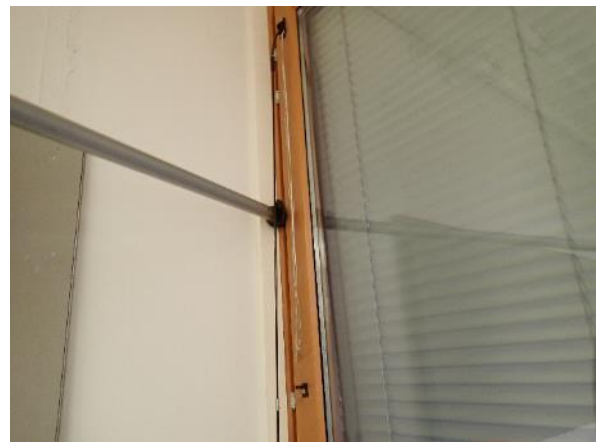
Kuva 21. Alipaineistettuna havaittiin vähäistä ilmapuotoa ikkunan ja pilarin liittymässä.
