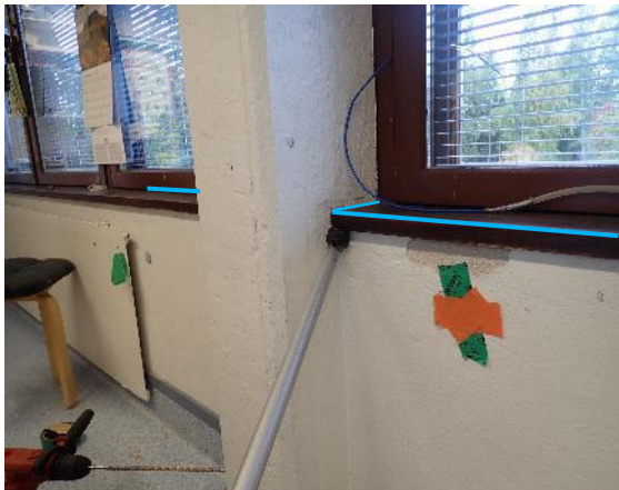
Kuva 6. Normaalityllassa ja alipaineistettuna havaittiin vähäistä ilmavuotoa ikkunalaudan alueella, pilarin ja ulkoseinän liittymässä sekä ikkunan ja ulkoseinän liittymäkohdalla.
