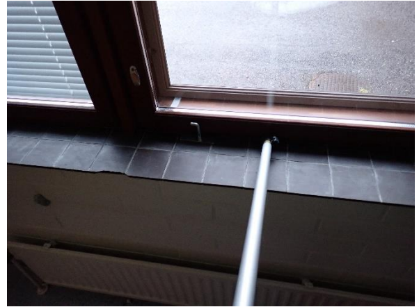
Kuva 25. Normaali- ja alipaineistettuna havaittiin merkittävää ilmavuotoa ikkunan ja ulkoseinän liittymäkohdassa.
