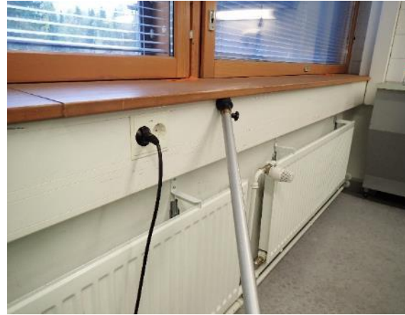
Kuva 12. Normaali-tilassa ja alipaineistettuna havaittiin merkittävää ilmavuotoa ikkunan ja ulkoseinän liittymäkohdassa ikkunalaudan alueella.
