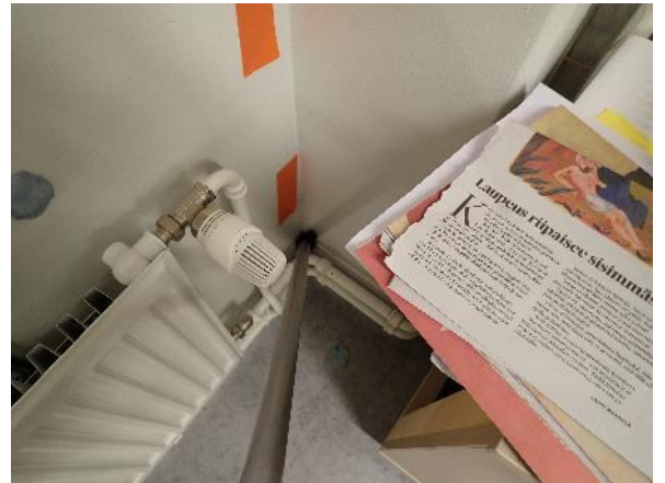
Kuva 19. Normaalityllassa ja alipaineistettuna havaittiin merkittävää ilmapuotoa pilarin liittymässä.
