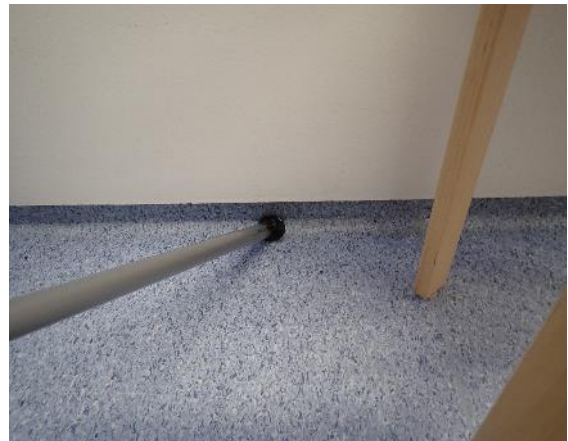
Kuva 7. Normaalityllassa ja alipaineistettuna havaittiin vähäistä ilmavuotoa välipohjan ja ulkoseinän liittymässä.
