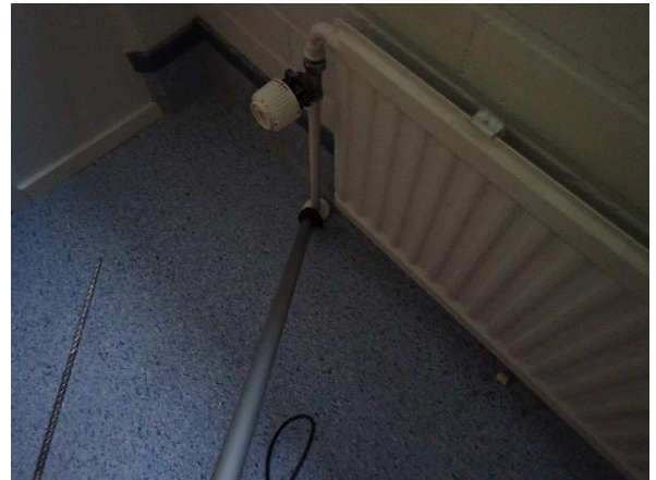
Kuva 27. Normaali- ja alipaineistettuna havaittiin vähäistä ilmavuotoa patterin vesiputken läpiviennessä.
