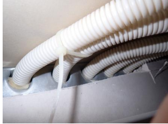
Kuva 3. Käytävän 123 puolella havaittiin samassa läpivienti kohdassa mineraalivillaa sähköputkien alapinnalla.
