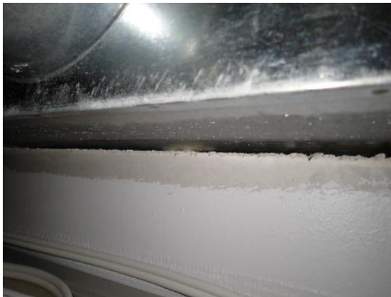
Kuva 4. Liitäntälaatikon alapinnan ja väliseinän välissä havaittiin mineraalivillaa käytävän puolella.
