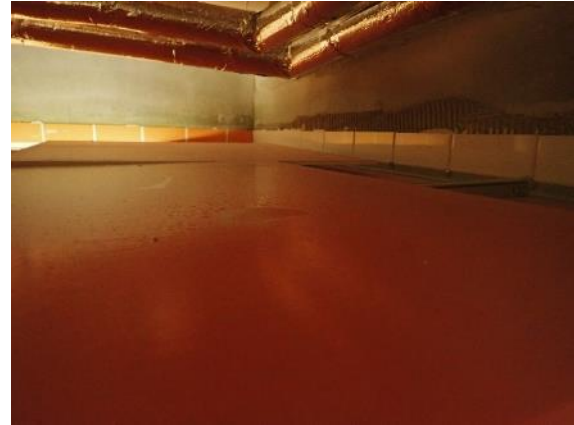
Kuva 13. WC-tilan alaslasketun kattolevytyksessä havaittiin vanha vuotojälki. Yläpuolella ei kuitenkaan havaittu mahdollisia vuotoreittejä.
