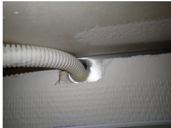
Kuva 5. Teräsrankaisen väliseinän läpiviennin kohdalla havaittiin mineraalivillaa.
