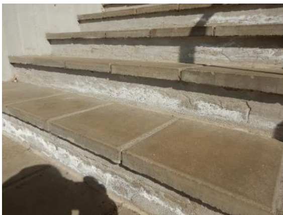
Kuva 24. Yhdyskäytävän portaissa kalkkihärmettä.
