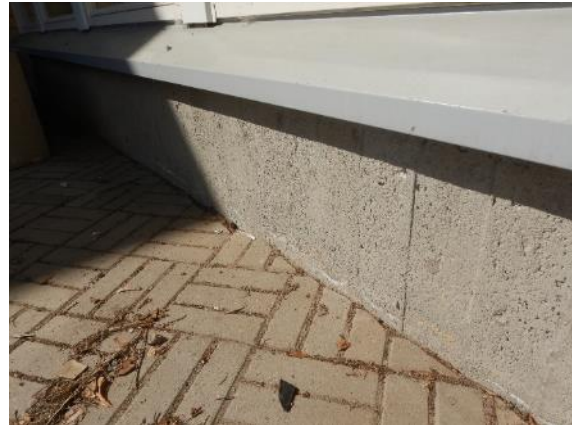
Kuva 23. Sisäpihan puolella sokkelin juurella lievästi kalkkihärmettä ja kosteusjälkiä.
