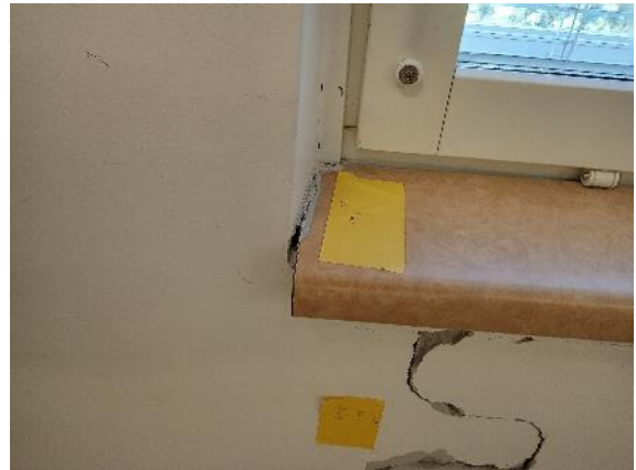
Kuva 61. Tilassa 116 halkeama, jossa merkittävästi merkittävästi ilmavuotoa.
