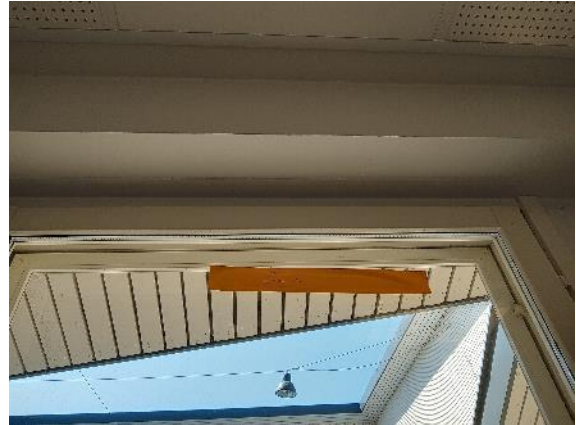
Kuva 59. Yläkarmen liittymässä ilmavuotoa.
