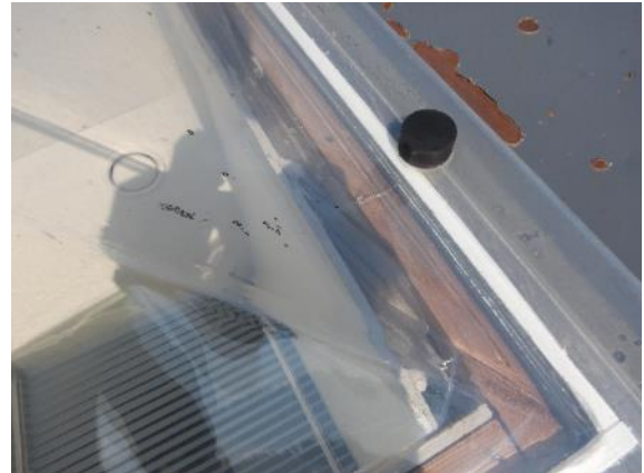
Kuva 68. KUILUN sisäpuolen levy on irronnut yläpää- tään.
