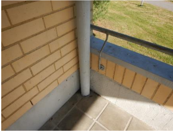
Kuva 20. Kuvan 22 kaiteen toiselta puolelta. Syök- sytorvi voi vuotaa rakenteen sisällä.
