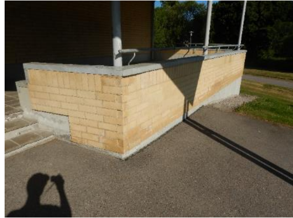
Kuva 21. Terrassin kaiteen alapäässä kosteusjälkiä ja kalkkihärmettä.
