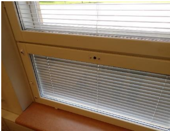
Kuva 44. Sälekaihtimen säätötanko irronnut.
