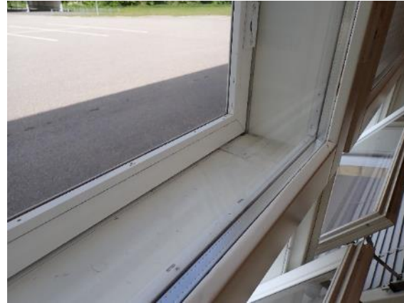
Kuva 43. Muovinen liukupinta vaurioitunut.
