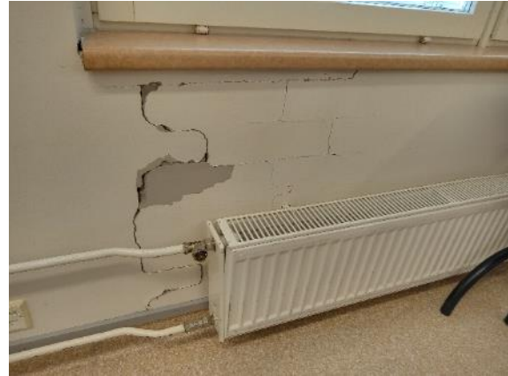
Kuva 36. Sisäpuolella saumojen myötäilevää halkeilua. Halkeama sijaitsee rakennuksen liittymäkohdassa. Alapuolella on väestönsuojan väliseinän ja ulkoseinän välinen liittymä.
