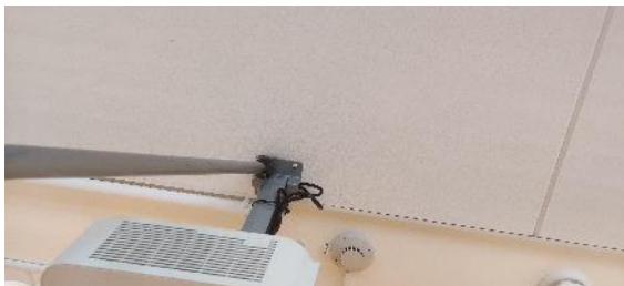
Kuva 75. Videotykin ruuvien kohdalta ilmavuotoa.
