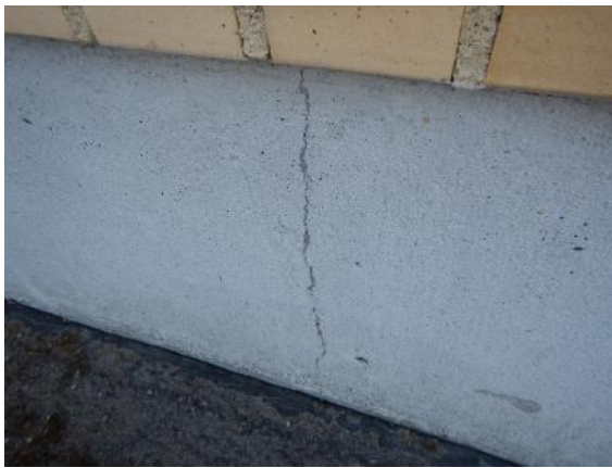
Kuva 16. Sokkelissa on monin paikoin pystysuuntaisia halkeamia.
