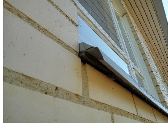
Kuva 39. Vesipellityksen liittymät epätiivit.
