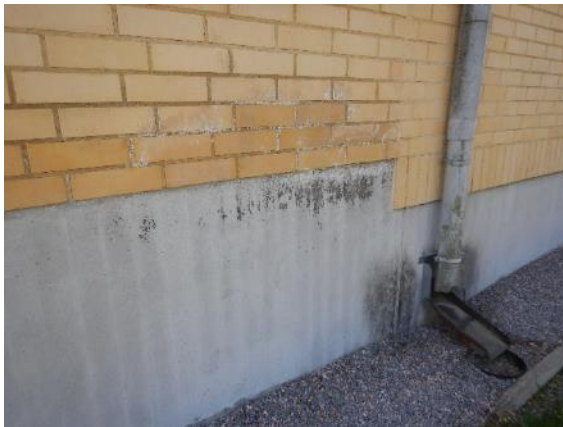
Kuva 18. Kosteusjälkiä ja kalkkihärmeä terassin kaiteessa ja sokkelissa koilliskulmalla.
