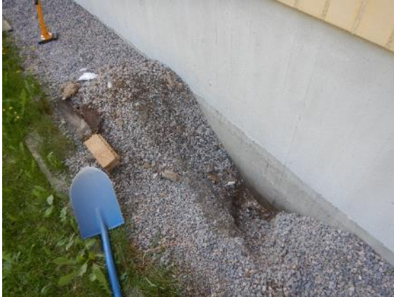
Kuva 12. Eteläjulkisivulla ei havaittu kosteuseristettä sokkelin ulkopinnassa.
