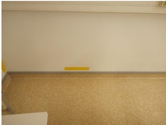
Kuva 31. Pistemäinen ilmavuoto väliseinän kulmauksessa. Lisäksi huoneistojen välisessä väliseinässä havaittiin noin 2-metrin matkalla ilmavuotoa.
