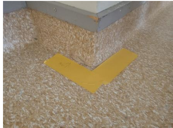
Kuva 32. Muovimaton saumoissa halkeamia, josta havaittiin merkittävää ilmavuotoa.
