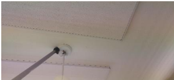
Kuva 73. Melkein kaikissa lamppujen läpivienneissä havaittiin ilmavuotoa.
