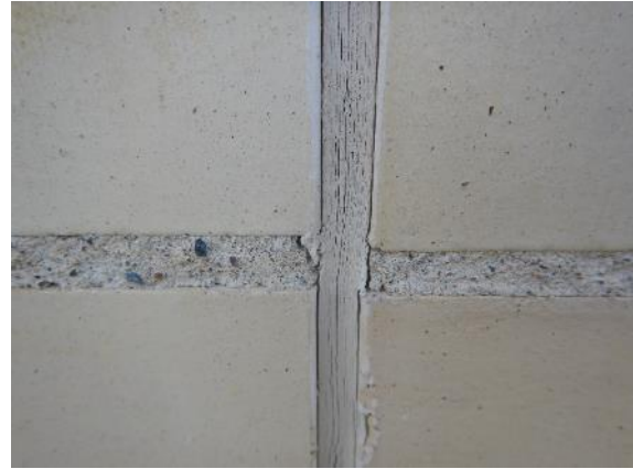
Kuva 34. Julkisivujen elastisissa saumamassoissa on halkeilua ja irtoamista reunoilta.
