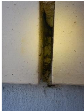
Kuva 37. Osa muurauksen tuuletusaukoista on tukkeutunut laastipurseista.
