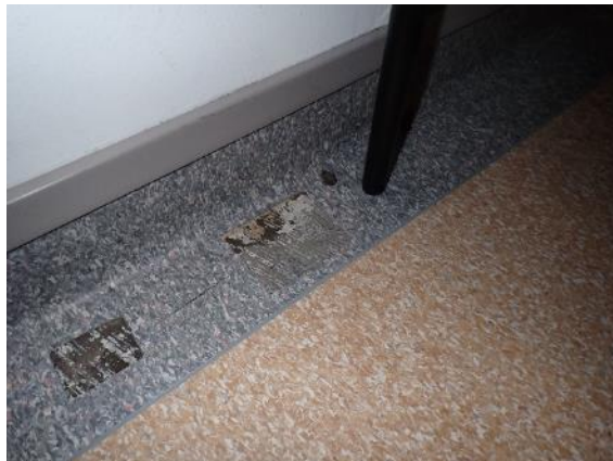
Kuva 26. Käytävällä 001, muovimatton alapinnassa tummentumaa. Kohdassa lisäksi voimakas haju.
