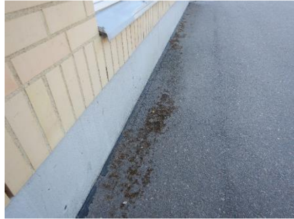
Kuva 5. Pohjoisjulkisivulla pinta kallistaa hieman rakennusta kohden, sammaloitumista.
