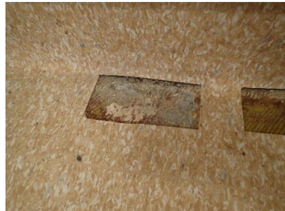
Kuva 27. Opiskelutila 005, muovimatton alapinnassa kuivunutta ja osin vaalennutta liimaa.
