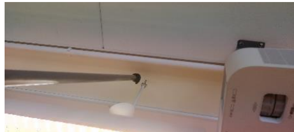
Kuva 74. Lampun kannatinkoukun kohdalla ilmavuotoa.
