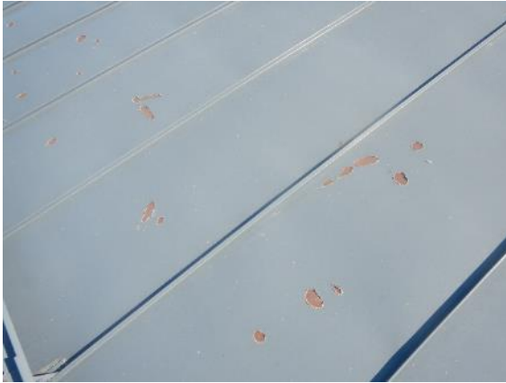
Kuva 65. Vesikatteen pinnoitteessa runsaasti piste- mäisiä alueita, joissa pinnoite irronnut.
