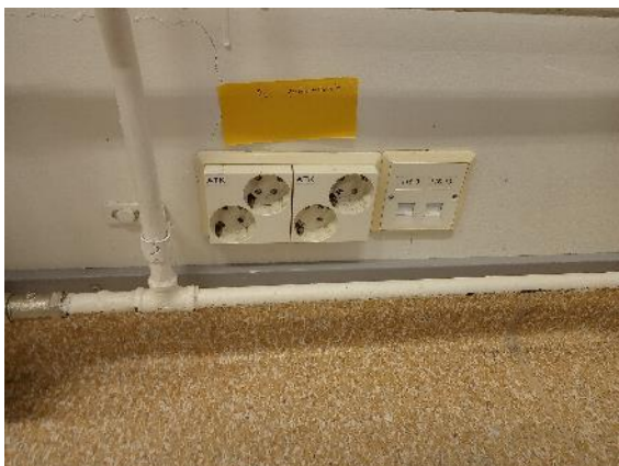
Kuva 62. Pistorasioissa pistemäistä ilmavuotoa.
