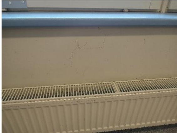
Kuva 35. Sisäpuolella saumojen myötäilevää halkeilua.
