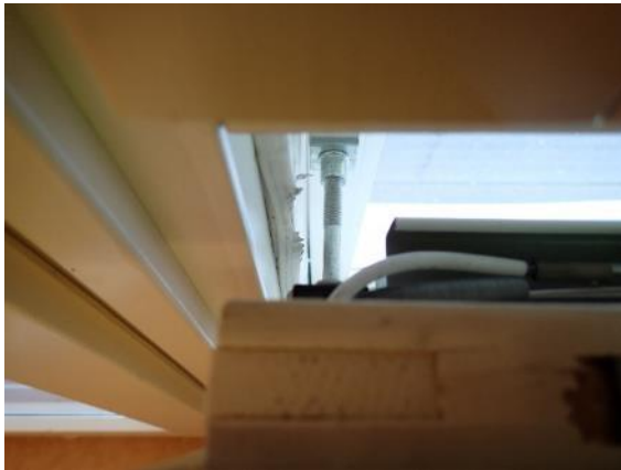
Kuva 40. Osassa ikkunoita havaittiin tiivisteessä repeämiä / reikiä.
