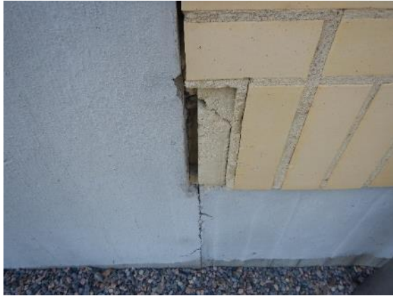
Kuva 33. Pohjoisjulkisivulla halkeama ja tiili lohjennut materiaalien rajapinnassa.
