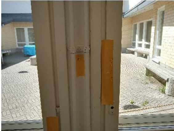
Kuva 58. Käytävällä puurakenteisen seinän ikkuna-karmien liittymissä ja patterikannakkeissa havaittiin ilmavuotoa.
