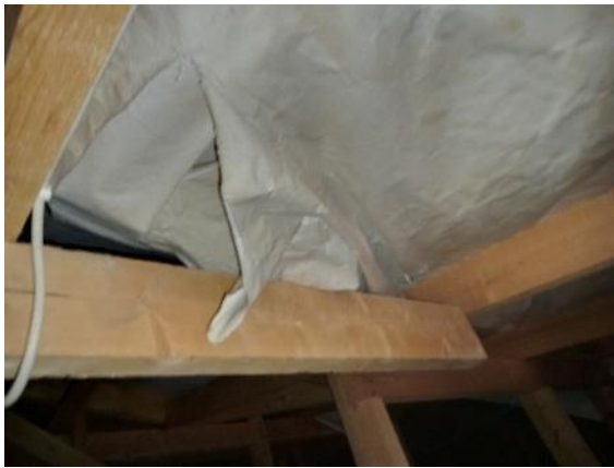
Kuva 71. Yksittäisissä kohdissa aluskatteen liittymäkohdat eivät näytä tiiviiltä.
