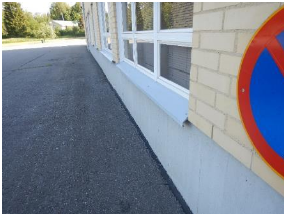
Kuva 2. Länsijulkisivulla rakennuksen vierusta on melko tasainen. Asfaltti painunut aivan sokkeliin vieressä.
