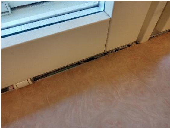
Kuva 60. Tilassa 118 havaittiin ikkunalaudan ja ikkunan välillä silmin havaittavaa rakoa. Kohdassa oletettavasti merkittävästi merkittävästi ilmavuotoa.
