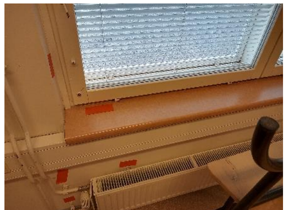
Kuva 63. Patterinkannakkeissa sekä ikkunan liittymissä havaittiin ilmavuotoa.
