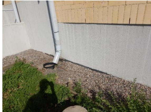
Kuva 7. Syöksytorvi ei laske rännikaivoon eteläisivulla.
