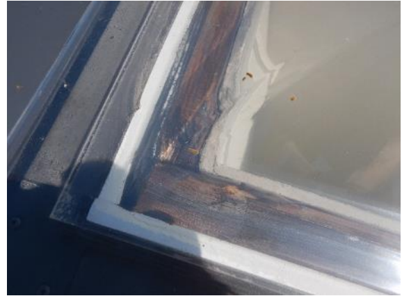
Kuva 66. Kattoikkunoiden puurungossa muutamien paikoin mahd. kosteuden aiheuttamia tummentumia.
