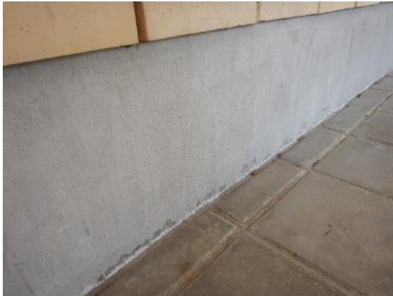
Kuva 22. Terrassisyvennöksen ulkoseinien ala- päässä kalkkihärmettä.
