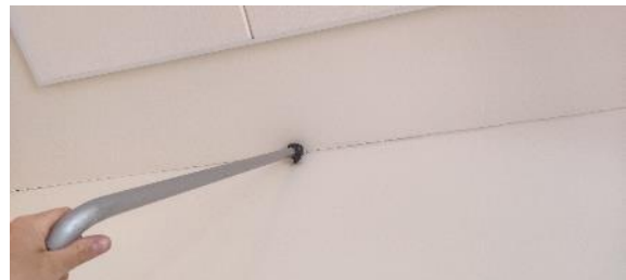
Kuva 76. Väliseinien ja yläpohjan liittymässä ilmavuotoa.
