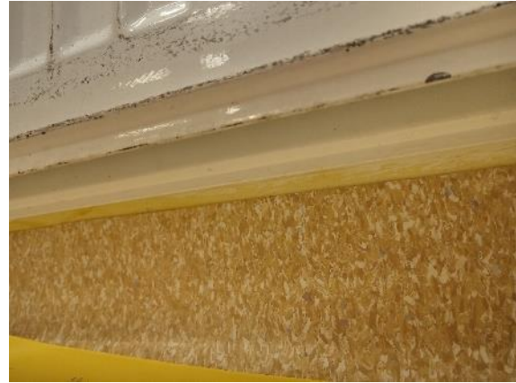
Kuva 30. Merkittävää ilmavuotoa havaittiin patterin alapuolella muovimaton liitoksessa, jossa ei ole reunalistaa asennettuna.
