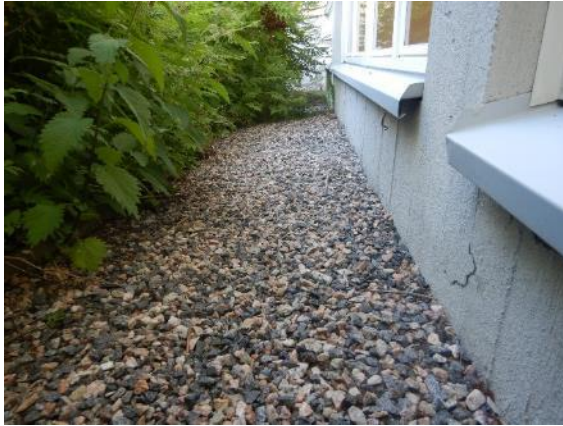
Kuva 4. Pinta kallistaa ulospäin yhdyskäytävän sokkelin vierustalla.
