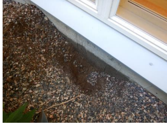
Kuva 11. Yhdyskäytävän sokkelin vieressä vain pinnassa sepeliä, alla hienojakoista maa-ainesta.
