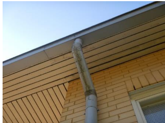
Kuva 19. Kuva edellisen kuvan syöksytorven yläpäästä. Liitos vuotaa.
