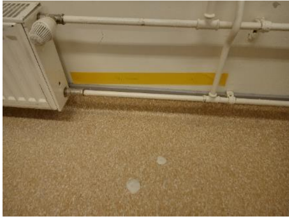
Kuva 29. Vähäistä ilmavuotoa ulkoseinän ja alapohjanliitelmästä.
