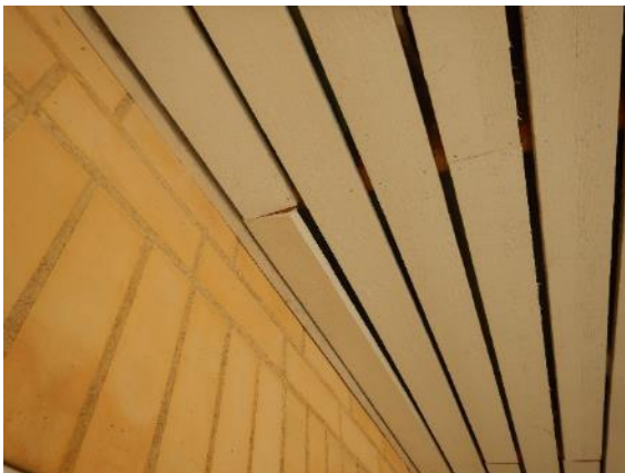
Kuva 69. Yhdyskäytävän katoksen alapinnassa päästään irronnut lauta.
