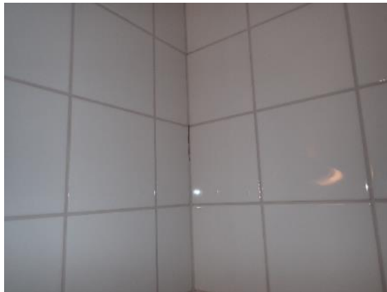
Kuva 64. WC-tilojen elastisissa saumoissa havaittiin halkeilua ja reikiä.
