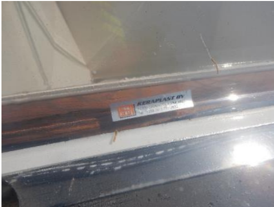
Kuva 67. Kattoikkunan tiiviste lainehtii ja sen päällä vaaleita kosteusjälkiä.
