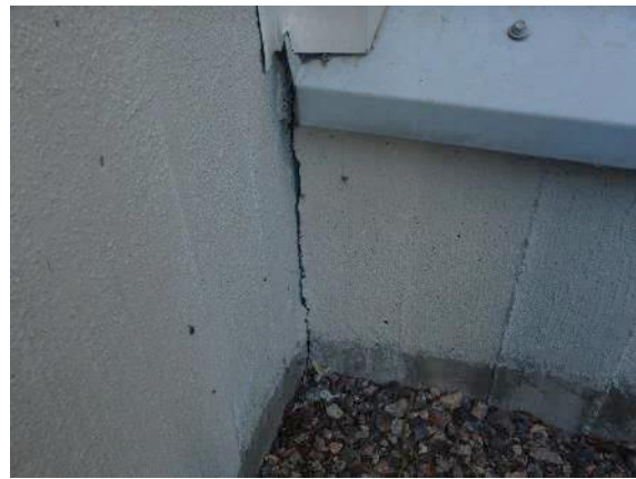
Kuva 17. Rakennuksen ja yhdyskäytävän liitos epätiivis.
