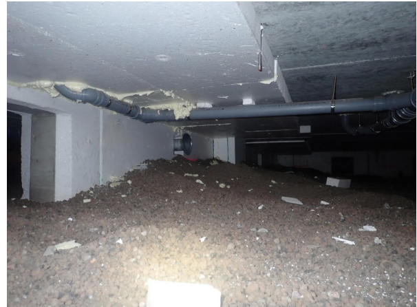
Kuva 8. Keskeemmällä alapohjaa on koneellisen poiston putki.
