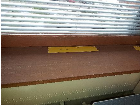
Kuva 19. Normaalityllassa havaittiin vähäistä ilmvuotoa ikkunalaudan ylä- ja alapinnalla. Ilmvuoto on oletettavasti ikkunan alakarmin ja ulkoseinäliittymän rajapinnalla.
