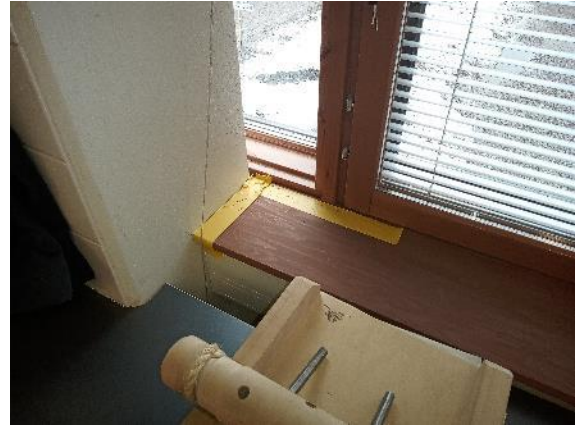
Kuva 20. Normaalityllassa havaittiin vähäistä ilmvuotoa ikkunalaudan ja pilarin välisestä liittymästä sekä ikkunalaudan yläpuolelta. Ilmvuoto on oletettavasti ikkunan alakarmin ja ulkoseinäliittymän rajapinnalla.
