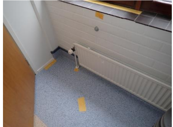
Kuva 15. Normaalityllassa havaittiin merkittävää ilmapuotoa ikkunan alakarmin liittymässä. Lisäksi merkittävää ilmapuotoa havaittiin ikkunapenkin kaakeloiden alapuolisissa raoissa. Patteriputken läpiviennissä havaittiin pistemäinen ilmapuoto.
