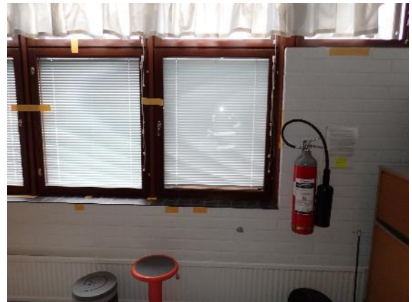
Kuva 17. Normaalityllassa havaittiin merkittävää ilmapuotoa ikkunapenkin kaakelin alapuolella olevissa raoissa, sekä "pienemmän ikkunan" alakarmin ja ulkoseinän liittymässä merkittävää ilmapuotoa alipaineistettuna. Ikkunakarmin pystyliittymässä merkittävää ilmapuotoa normaalityllassa. Ikkunakarmien välisessä liittymässä vähäistä ilmapuotoa alipaineistettuna.
