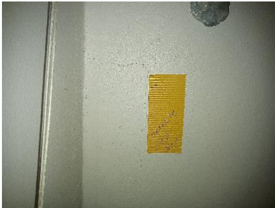
Kuva 21. Normaalityllassa havaittiin vähäistä ilmvuotoa seinän halkeamissa.
