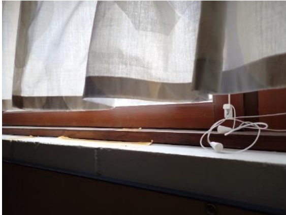
Kuva 14. Normaalityllassa havaittiin merkittävää ilmapuotoa ikkunoiden alakarmien liittymissä.
