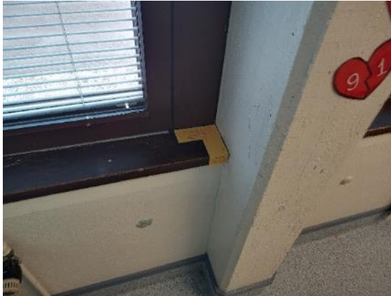
Kuva 9. Normaalityössä havaittiin vähäistä ilmapuotoa ikkunalaudan ja ikkunan välissä ja ikkunan ja pilarin välissä. Lisäksi alapinnalla rako.
