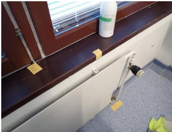
Kuva 6. Patterinkannakkeessa alipaineistettuna pistemäistä ilmavuotoa. Ikkunakarmin liitoskohdassa pistemäistä ilmavuotoa normaalitilassa ja patteriputken läpiviennissä pistemäinen ilmavuoto normaalitilassa.
