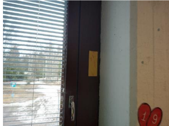
Kuva 10. Alipaineistettuna ikkunakarmin ja pilarin liittymässä ilmapuotoa koko ikkunan matkalla.
