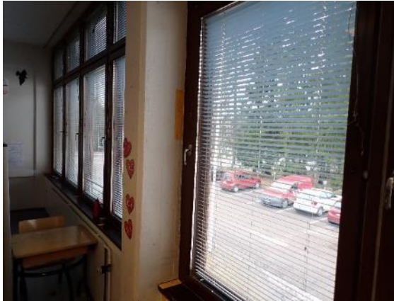
Kuva 4. Normaalitilassa ikkunalaudan ja pilarin liittymässä vähäistä ilmavuotoa. Ikkunalaudan alapuolella silmin havaittava rako, jossa merkittävää ilmavuotoa. Ikkunakarmin ja pilarin liittymässä alipaineistettuna merkittävää ilmavuotoa.
