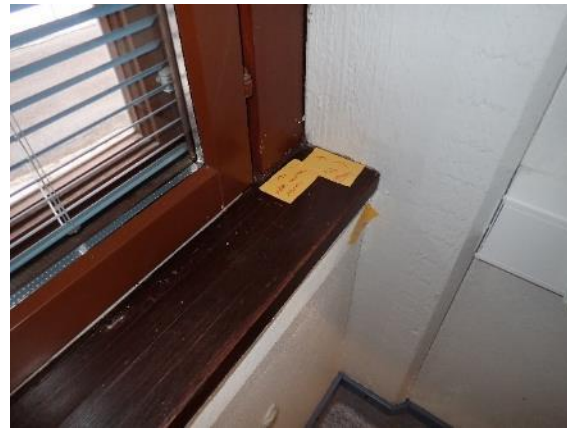
Kuva 7. Normaalitilassa havaittiin vähäistä ilmavuotoa ikkunalaudan liittymässä. Ikkunalaudan alapuolella liitosnauha ei ulotu pilaria vasten, jonka vuoksi ikkunalaudan alapuolella havaittavissa ilmavuotoa.
