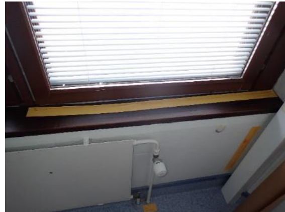
Kuva 12. Normaalityössä havaittiin merkittävää ilmapuotoa ikkunalaudan liittymässä. Ilmapuoto on oletettavasti alakarmin ja ulkoseinän rajapinnassa.
