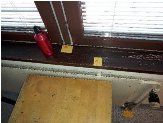
Kuva 11. Normaalityössä havaittiin pistemäisiä ilmapuotoa, patterinkannakkeesta, ikkunakarmin välisestä liittymästä ja patteriputken läpiviennissä.
