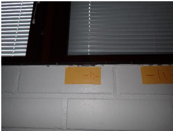
Kuva 16. Normaalityllassa ikkunapenkin kaakelin alapuolella olevissa raoissa merkittävää ilmapuotoa.
