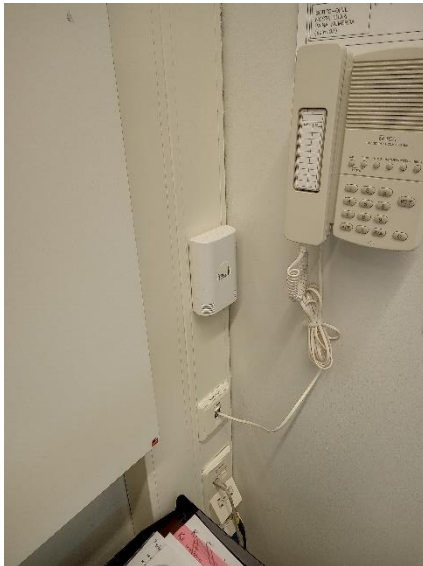
Kuva 7. Freesijärjestelmän mittalaite on sijoitettu ulkoseinän ja väliseinän liihtymän alueelle.
