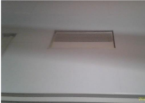
Kuva 9: Suorakaiteen muotoisissa seinäsäleiköissä on mineraalikuitulähteitä (toimintatila).
