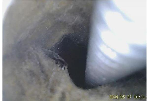
Kuva 10 Säleikön vaimennuslevyn ja säätöjousen läpiviennissä näkyy avointa mineraalikuitua (toimintatila).
