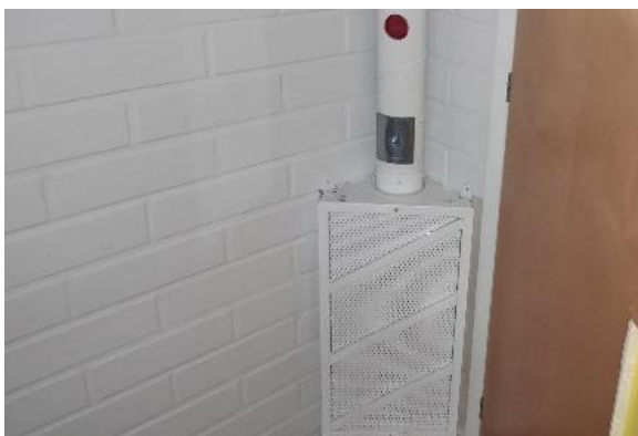
Kuva 13: Syrjäyttävässä tuloilman päätelaitteessa ei ole mineraalikuitulähteitä (tila 7).
