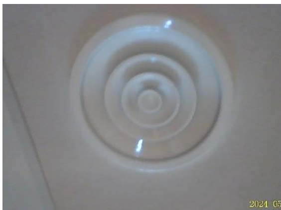
Kuva 7: Pienissä tuloilman kattohajottajissa on mineraalikuitulähteitä (tila 4).
