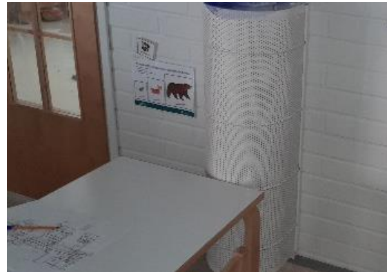
Kuva 12 Syrjäyttävässä tuloilman päätelaitteessa ei ole mineraalikuitulähteitä (tila 5).
