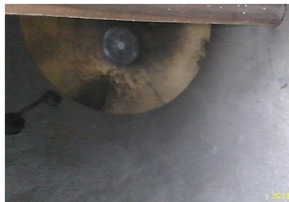
Kuva 8: Pienen kattohajottajan kanavan päässä on säätöyksikkö ja vaimennustäytettä, joka on mineraalikuitupohjaista (tila 4).
