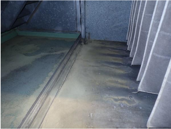
Kuva 2: Tuloilman suodatinkammioon pääsee lunta talvisin ja pölyä/siitepölyä kesäisin.
