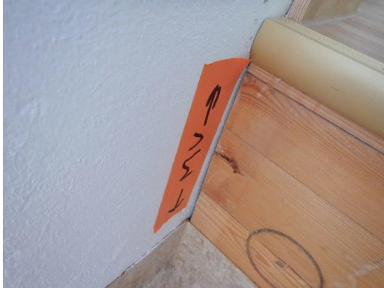
Kuva 7. Merkittävää vuotoa näyttämön ja pilarin saumasta (1). Vuotolähde näyttämörakenteen alla.
