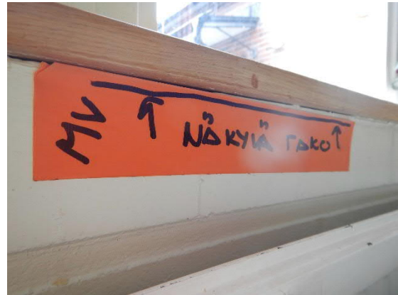
Kuva 15. Merkittävää vuotoa ikkunapenkin alaliittymästä, suuria rakoja (4).
