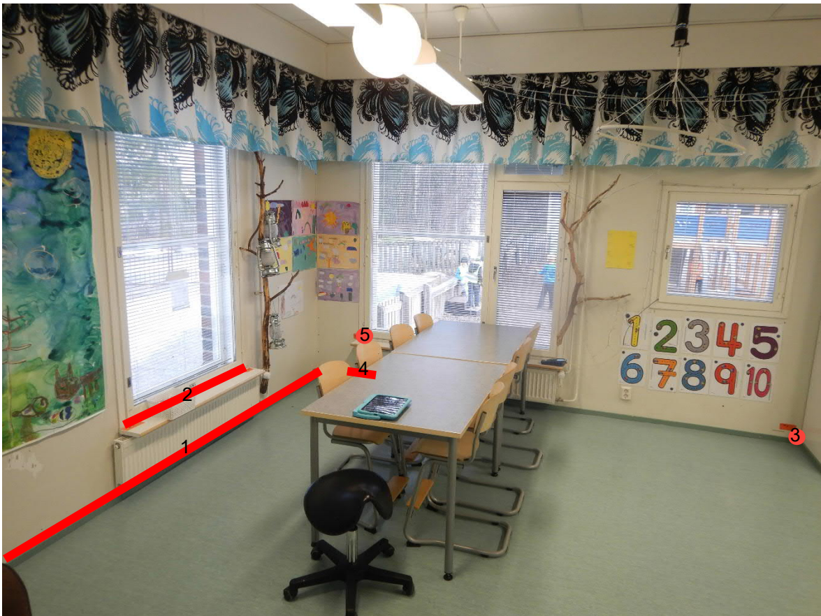
Kuva 18. Havaitut ilmapuotokohdat tilassa 1220.
