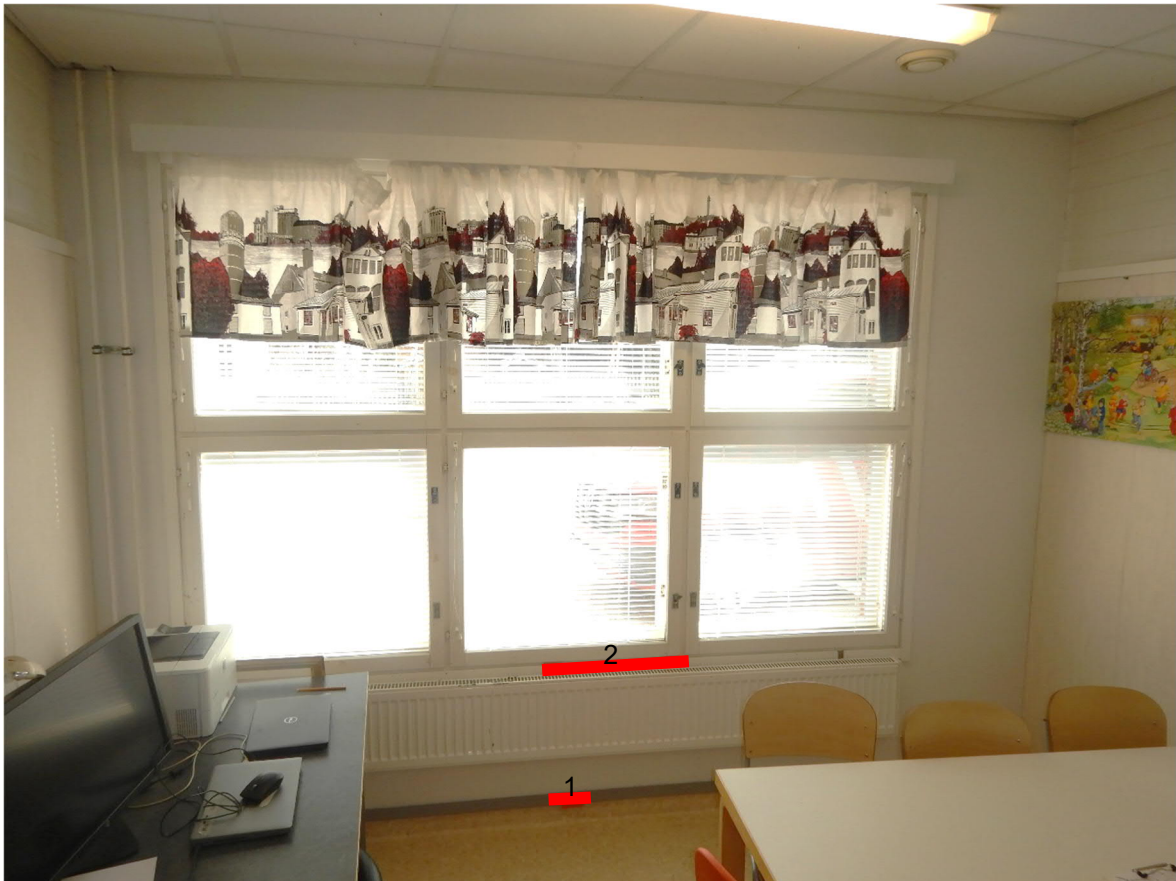
Kuva 22. Havaitut ilmavuotokohdat tilassa 1226.
