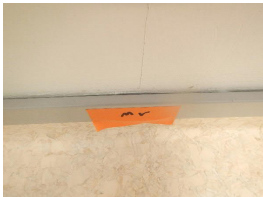
Kuva 23. Merkittävää vuotoa ulkoseinän ja lattian liittymästä. Jalkalistan takana rakoa (1).
