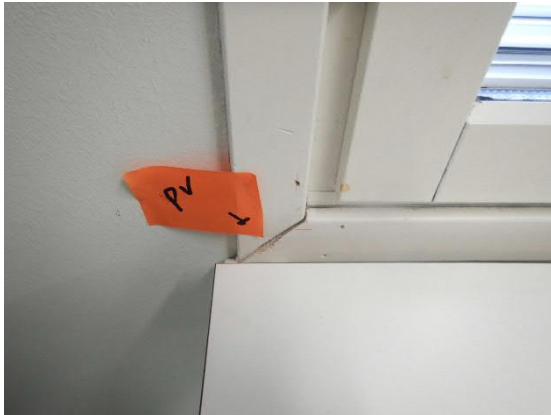
Kuva 21. Pistemäistä vuotoa ikkunakarmin kulumasta listoituksen takaa (5).
