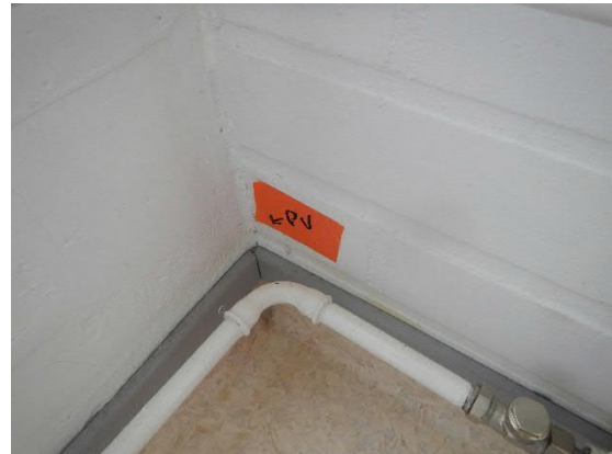
Kuva 5. Pistemäistä vuotoa muovimaton ylösnoston nurkkaliittymästä (7).
