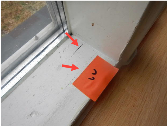
Kuva 2. Vähäistä vuotoa ikkunakarmissa olevista halkeamista (1).
