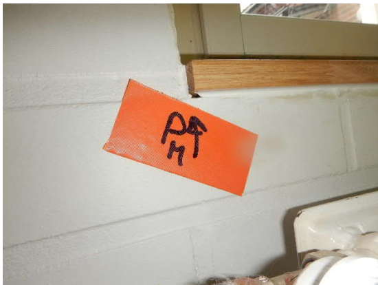
Kuva 16. Pistemäistä vuotoa ikkunapenkin päädystä. Tiivistyksessä reikä (5).
