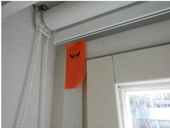
Kuva 4. Vähäistä vuotoa ikkunakarmin ja listan liittymästä (5).
