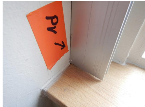
Kuva 10. Pistemäistä vuotoa ikkunapenkin ja alumiinilistan välisestä raosta (4).
