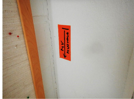
Kuva 13. Merkittävää vuotoa ulkoseinän ja pilarin liittymässä olevasta halkeamasta (2).
