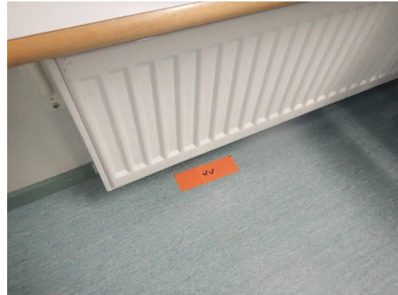
Kuva 20. Vähäistä vuotoa ulkoseinän ja lattian liittymästä (4).
