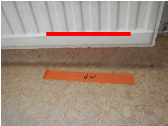
Kuva 9. Vähäistä vuotoa ulkoseinän ja muovimaton liitoksesta (3).
