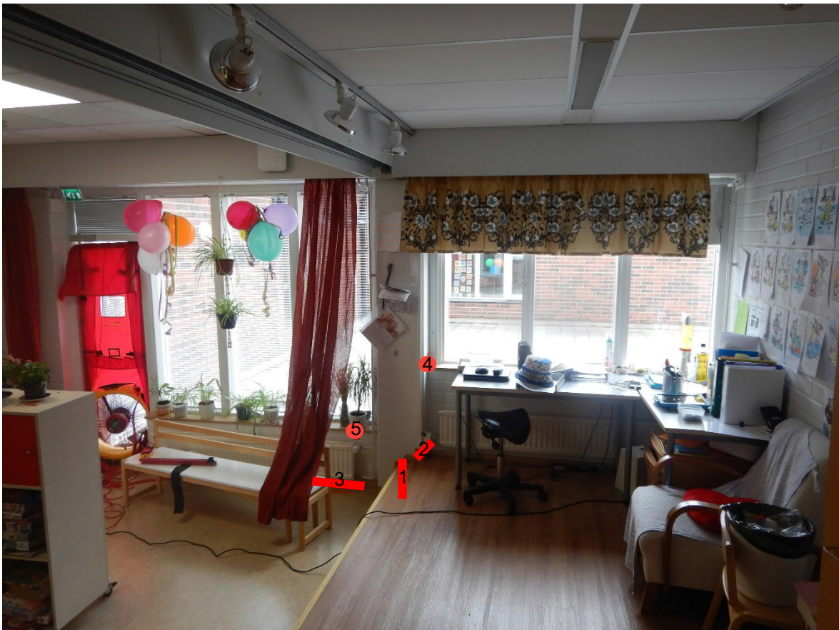
Kuva 6. Havaitut ilmavuotokohdat tilassa 1184.
