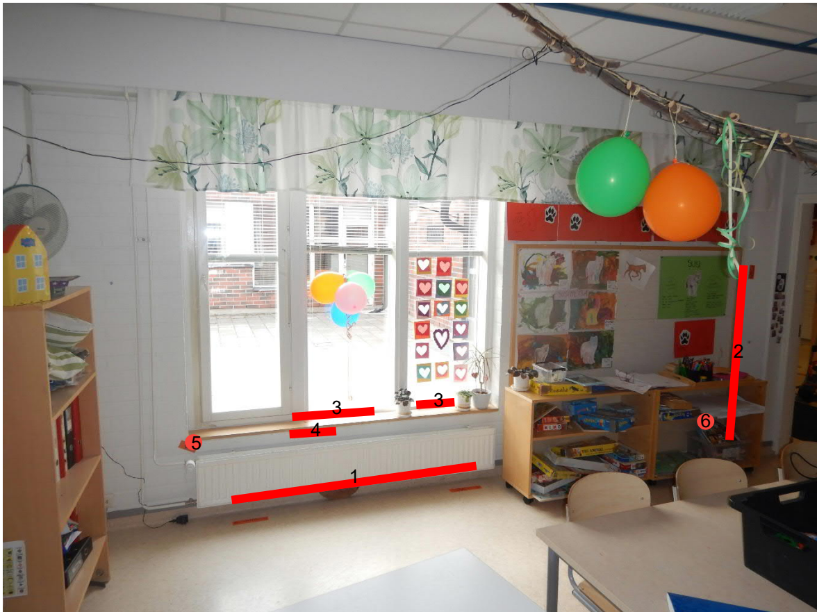
Kuva 11. Havaitut ilmavuotokohdat tilassa 1198.
