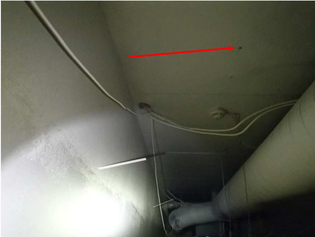
Kuva 15. Yläpohjan ontelolaatoissa havaittiin avoimia reikiä.
