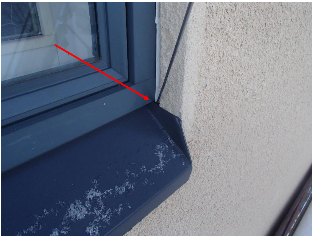
Kuva 13. Paikoin vesipeltien kulmissa on rakoja eristetilaan.
