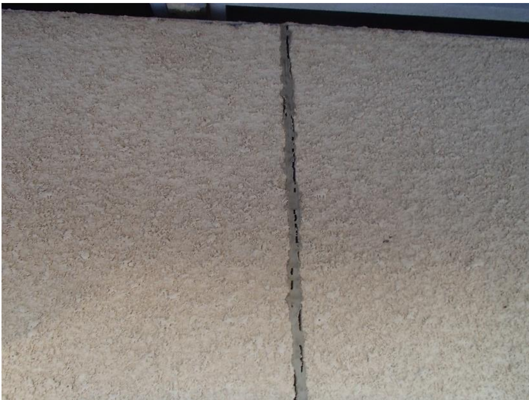
Kuva 11. Julkisivujen elastiset saumamassat ovat ikääntyneet ja irronneet reunoistaan.
