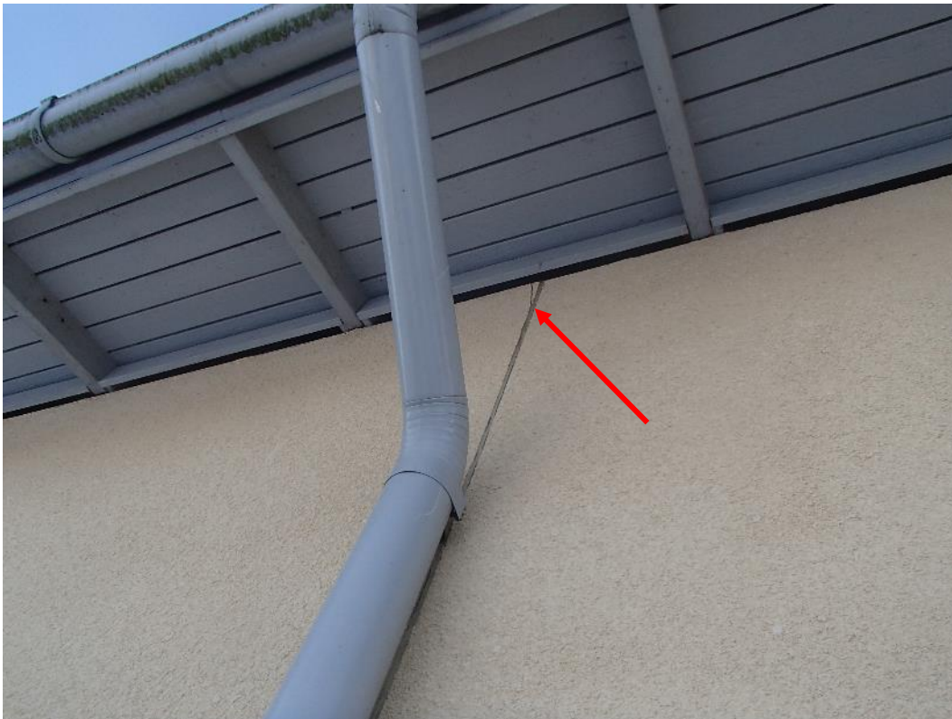
Kuva 14. Paikoin julkisivupinnoilla on halkeilua.
