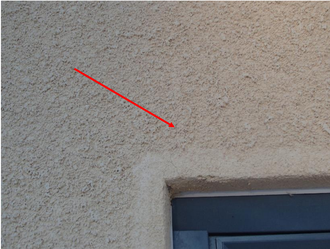
Kuva 10. Paikoin julkisivuilla havaittiin halkeilua.
