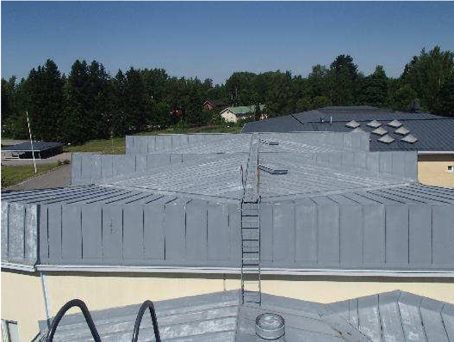
Kuva 156. Vuonna 1990 rakennetun koululaajennuksen vesikaton maalipinnat ovat kuluneet.
