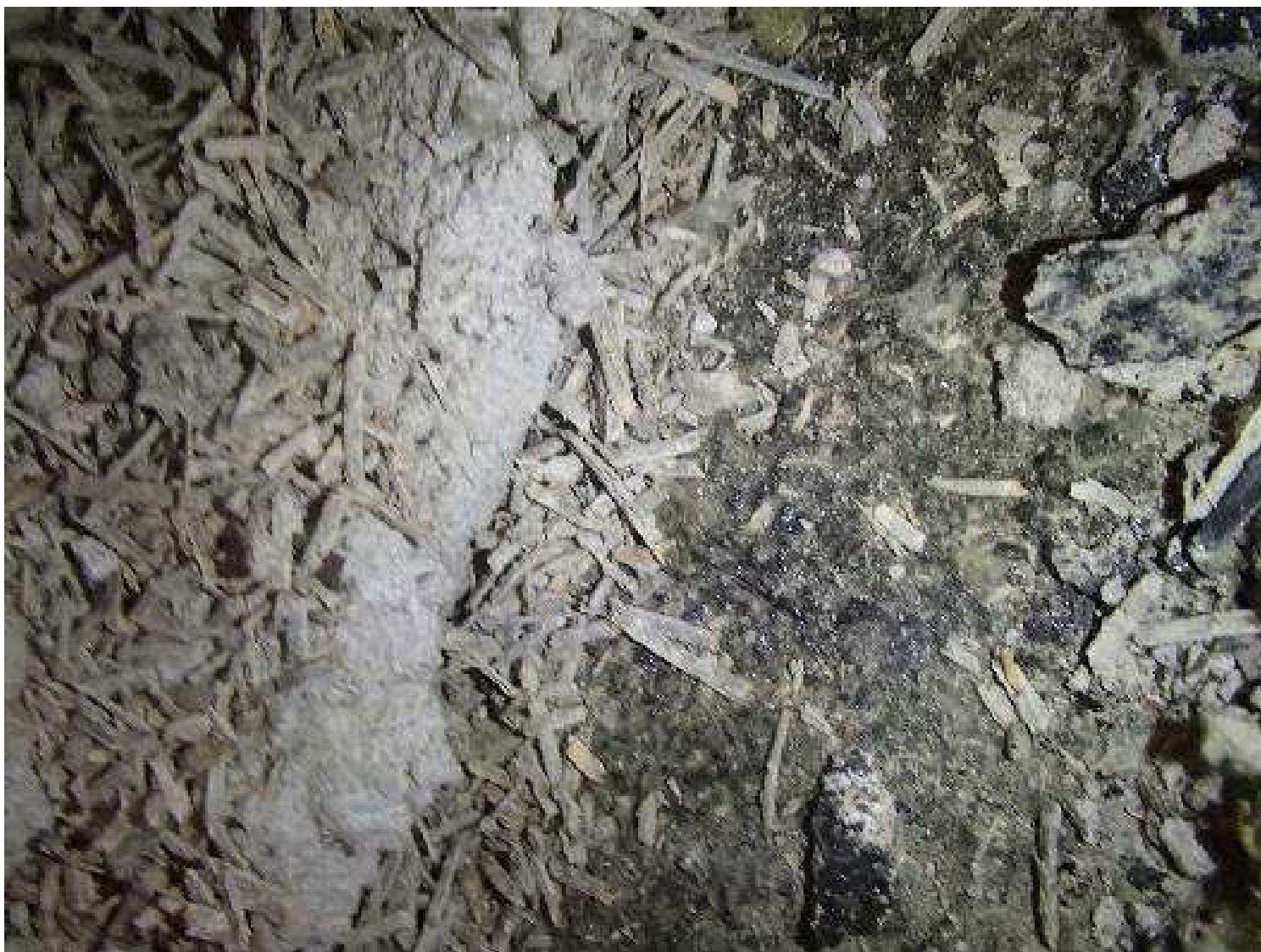
Kuva 125. Sokkelin eristetilassa havaittiin jäänteitä sementtikuitueristeestä (Toja).
