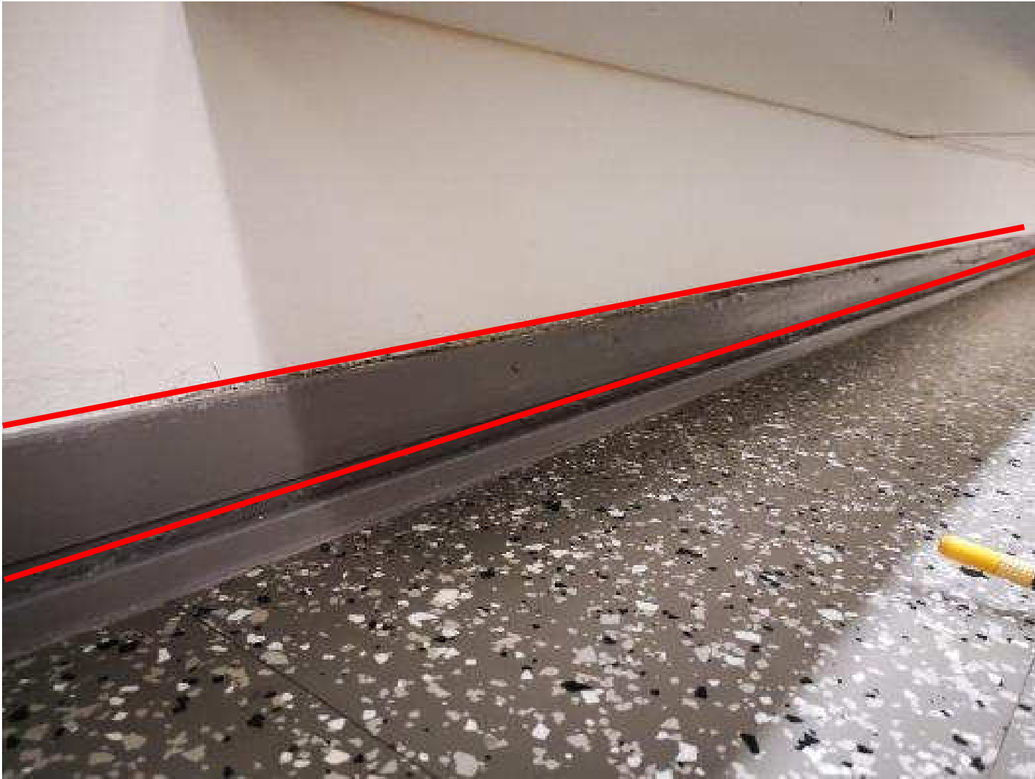
Kuva 196. Lattialitojen reuna-alueiden kautta havaittiin ilmavuotoja sisäilmaan.
