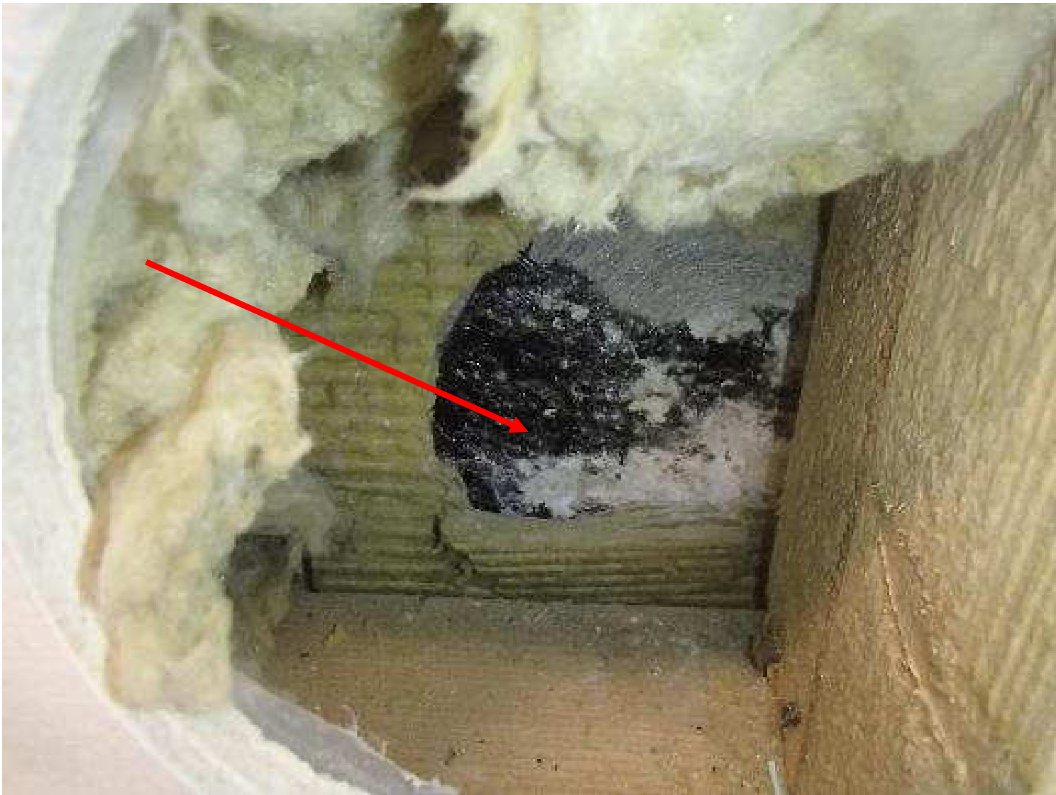
Kuva 111. Sokkelin bitumisivelyn pinnassa havaittiin kalkkihärmekertymiä.
