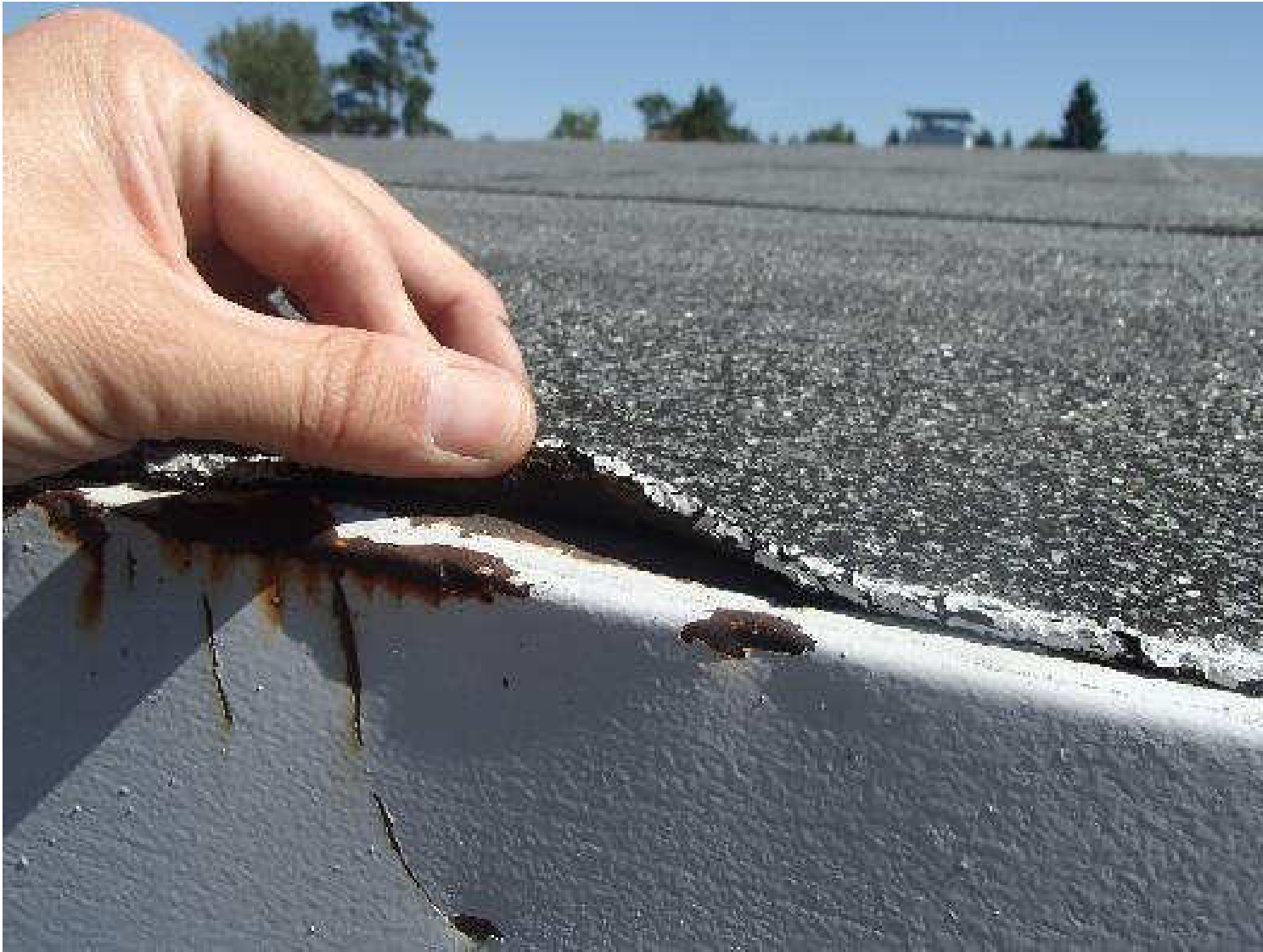
Kuva 142. Bitumikermien liitoksissa reunapellityksiin havaittiin irtoilua kiinnityksestään.
