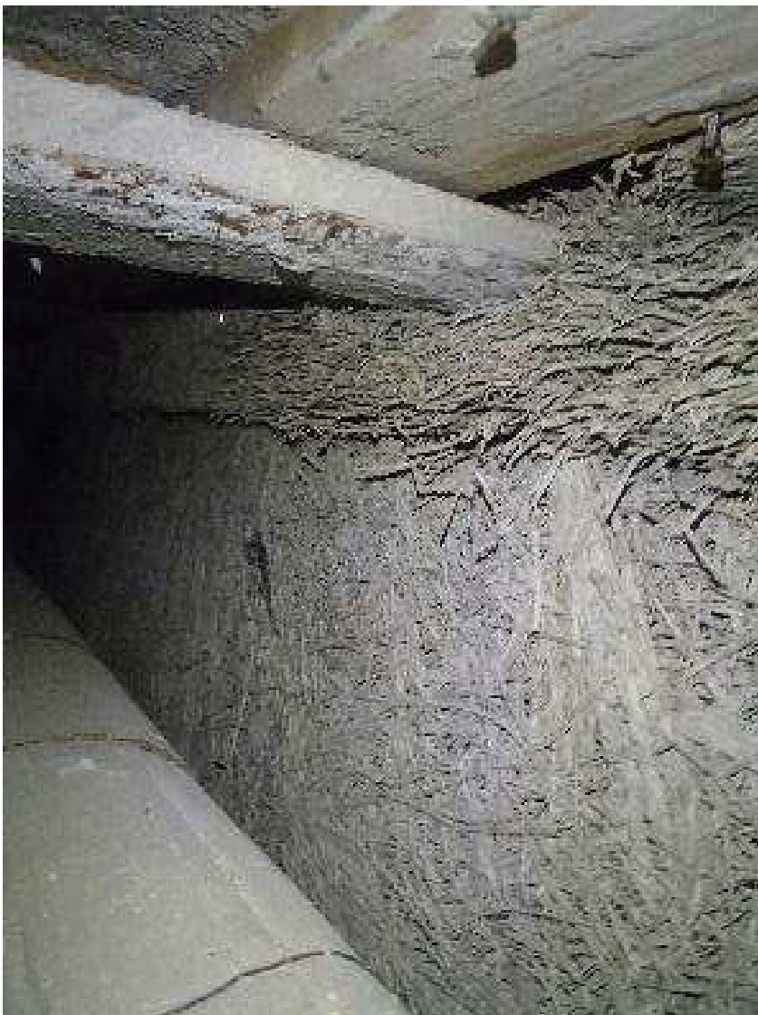
Kuva 160. Yleiskuva putkikanaalista. Putkikanaalissa on vanhat muottilauδοitukset ja sementtikuitueristeet sisäpinnalla,
