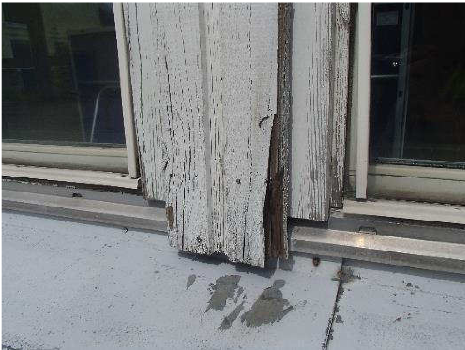
Kuva 121. Julkisivujen paneloinnit ovat paikoin vaurioituneet ja lahonneet.
