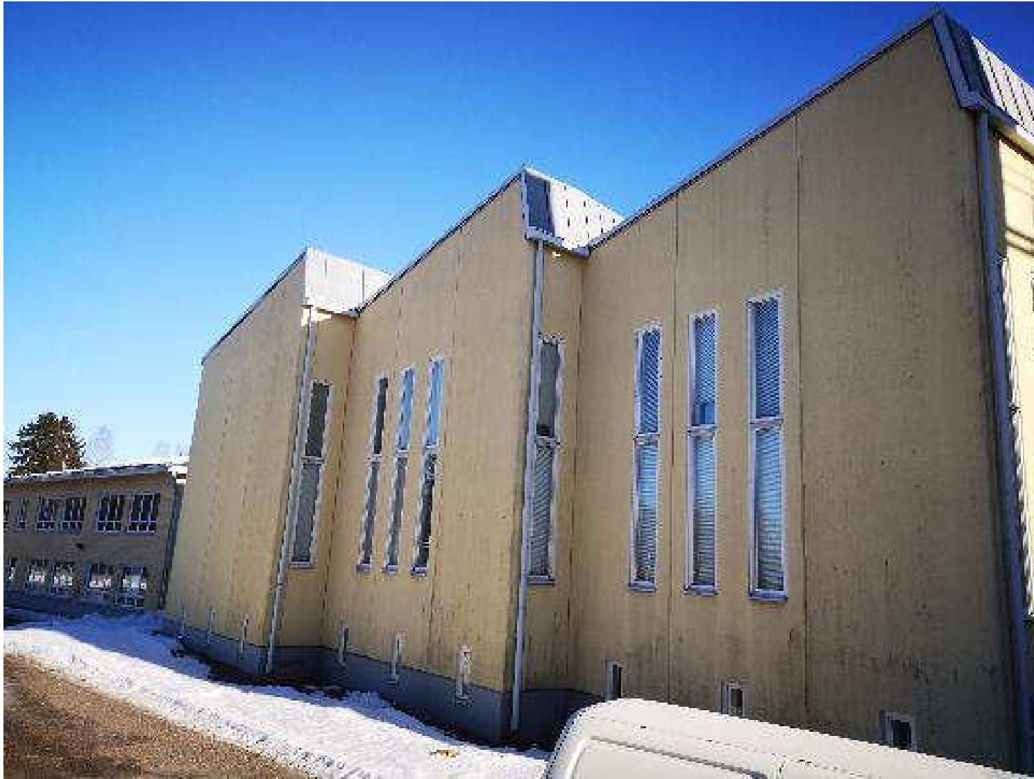
Kuva 104. Julkisivuilla havaittiin likaantumista.
