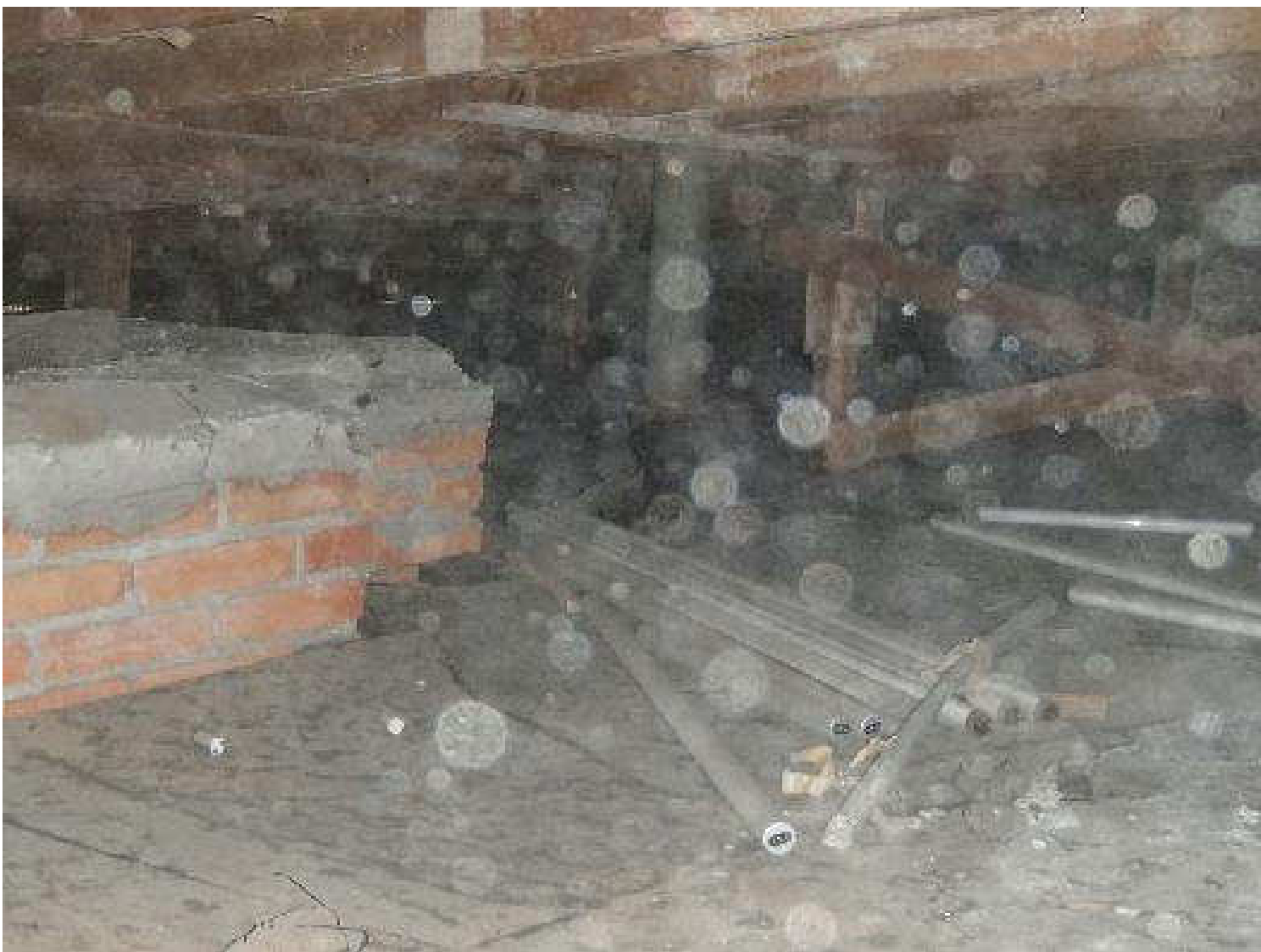
Kuva 153. Liikuntasalin yläpohjassa havaittiin ylimääräistä jätakuormaa.
