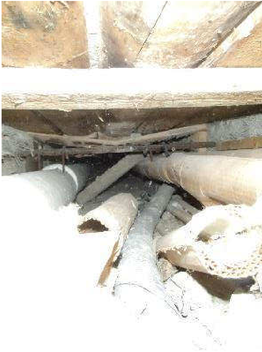
Kuva 161. Putkikanaaleissa havaittiin vanhoja rakennusmateriaaleja, jotka ovat pakoin vaurioituneet.
