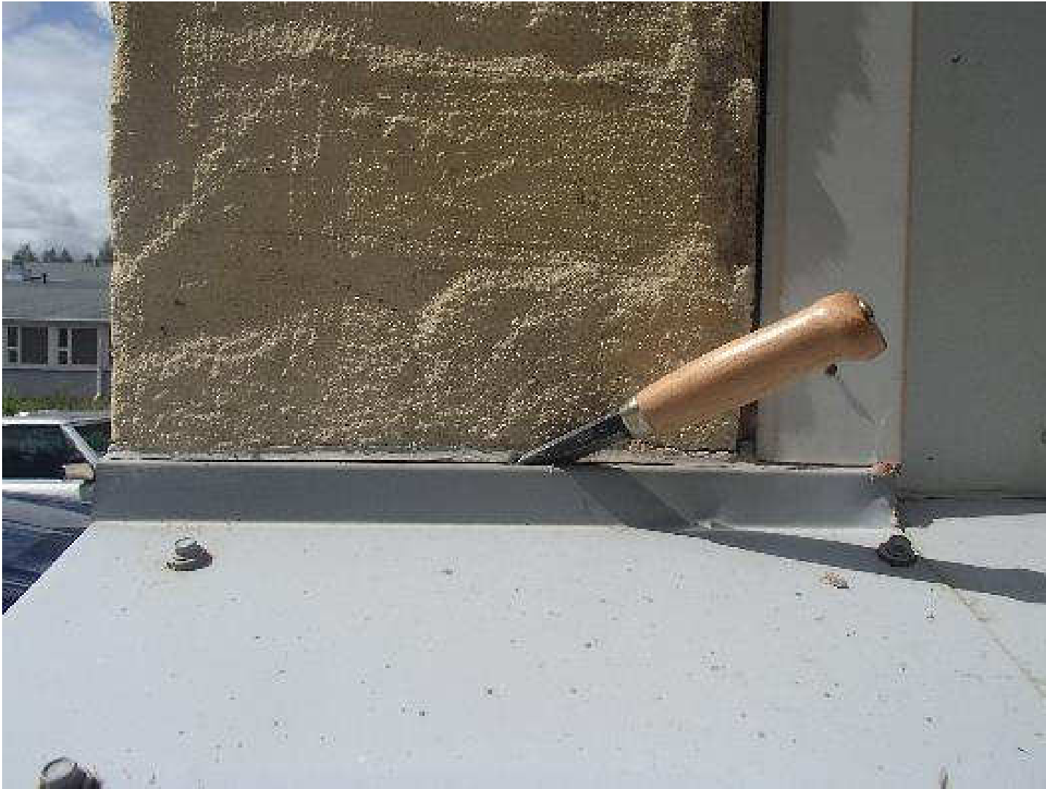
Kuva 112. Julkisivujen pellityksissä havaittiin rakoja rakenteisiin.
