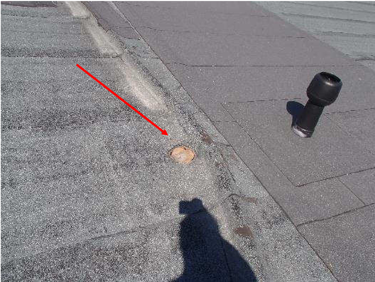
Kuva 147. Sadevesikaivot ovat paikoin vaurioituneet.
