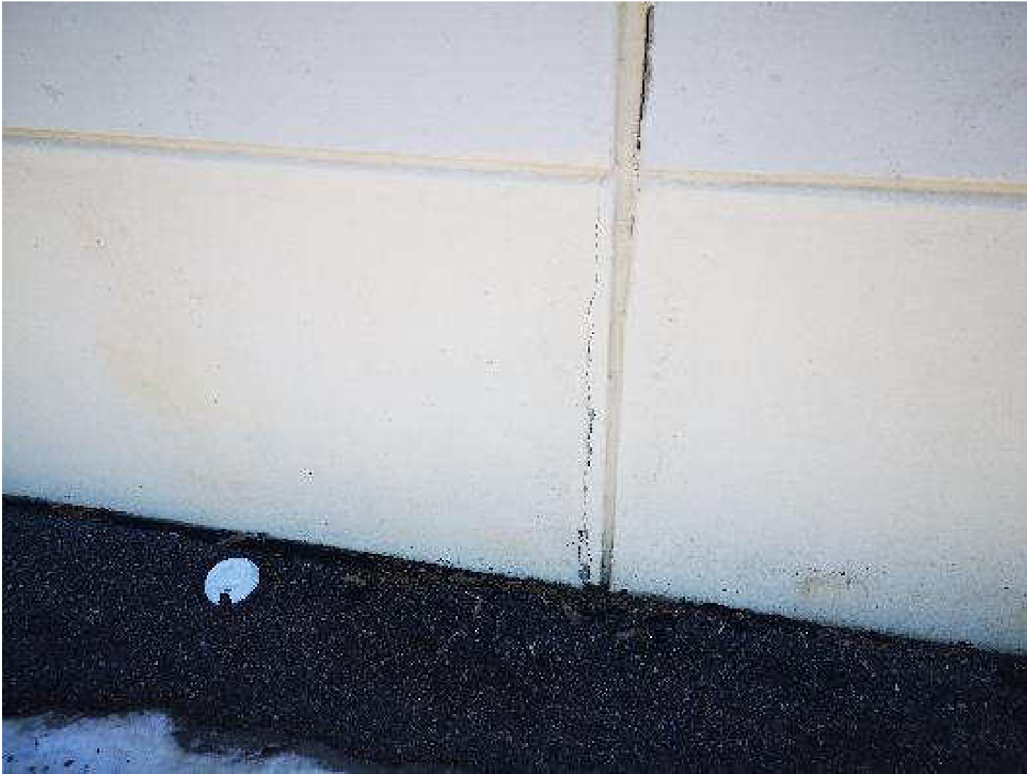
Kuva 108. Betonielementtien pinnassa havaittiin halkeilua.
