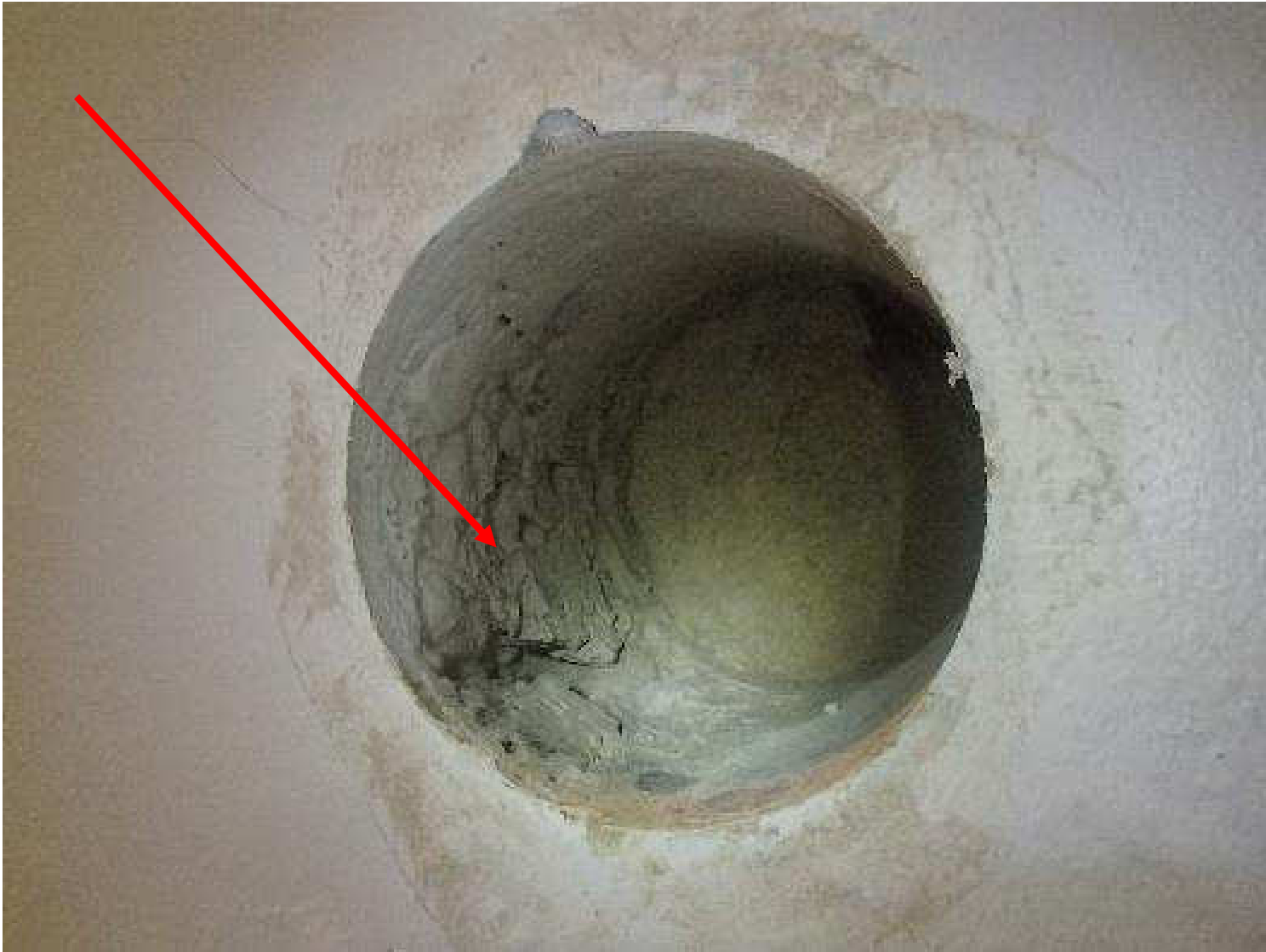
Kuva 169. Kellarikerroksen kosteusvaurioituneen seinän osalla havaittiin betonivalussa puuteellinen tiivistys.
