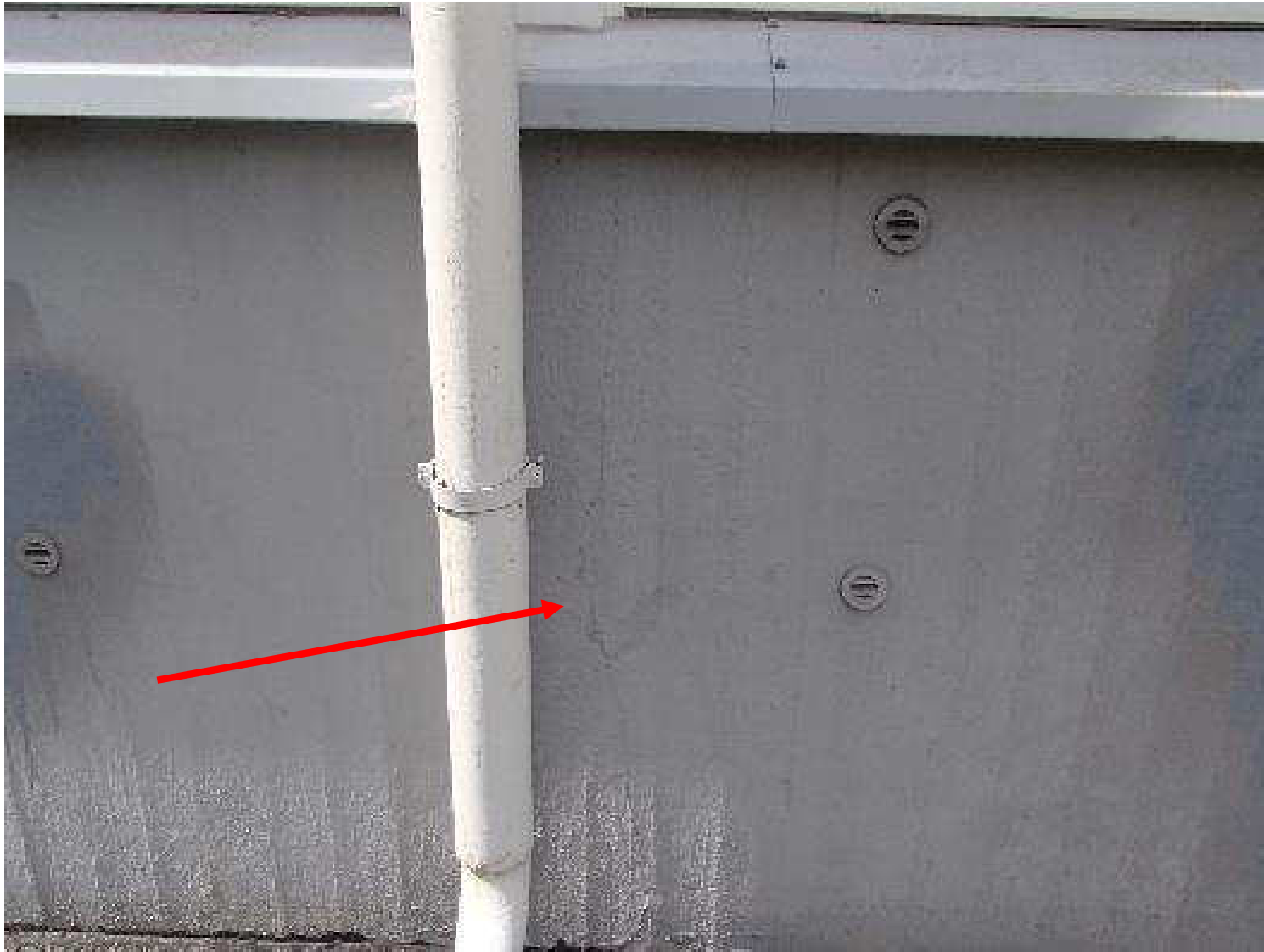
Kuva 130. Sokkelin ulkopinnassa havaittiin halkeilua.
