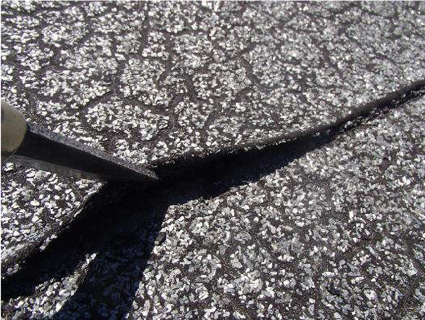
Kuva 146. Bitumikermissä havaittiin ikääntymisestä aiheutunutta verkkomaista halkeilua ja sauma-alueilla havaittiin irtoilua liimauksesta.
