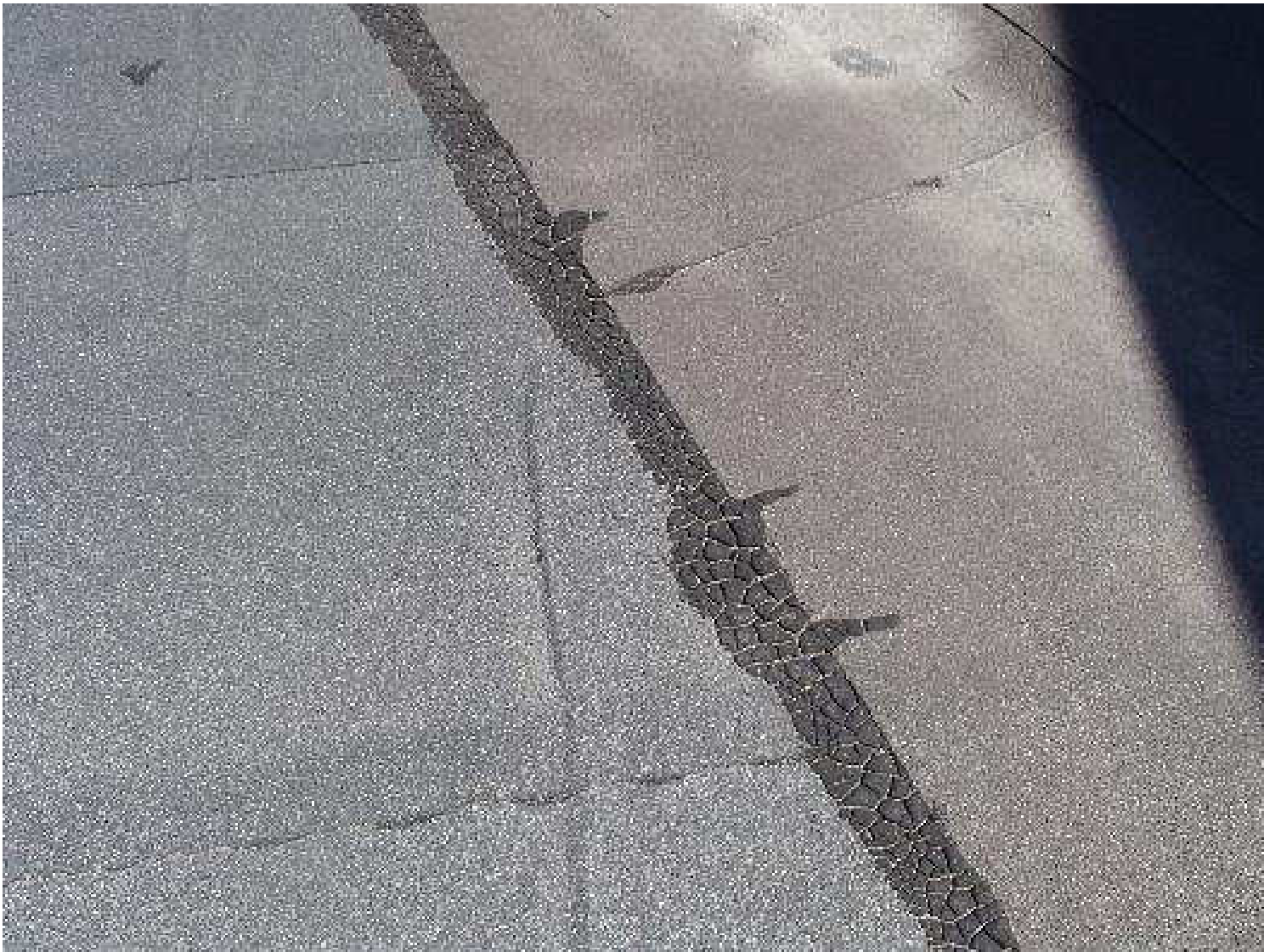
Kuva 145. Bitumitiivistykset ovat ikääntyneet ja halkeilleet.
