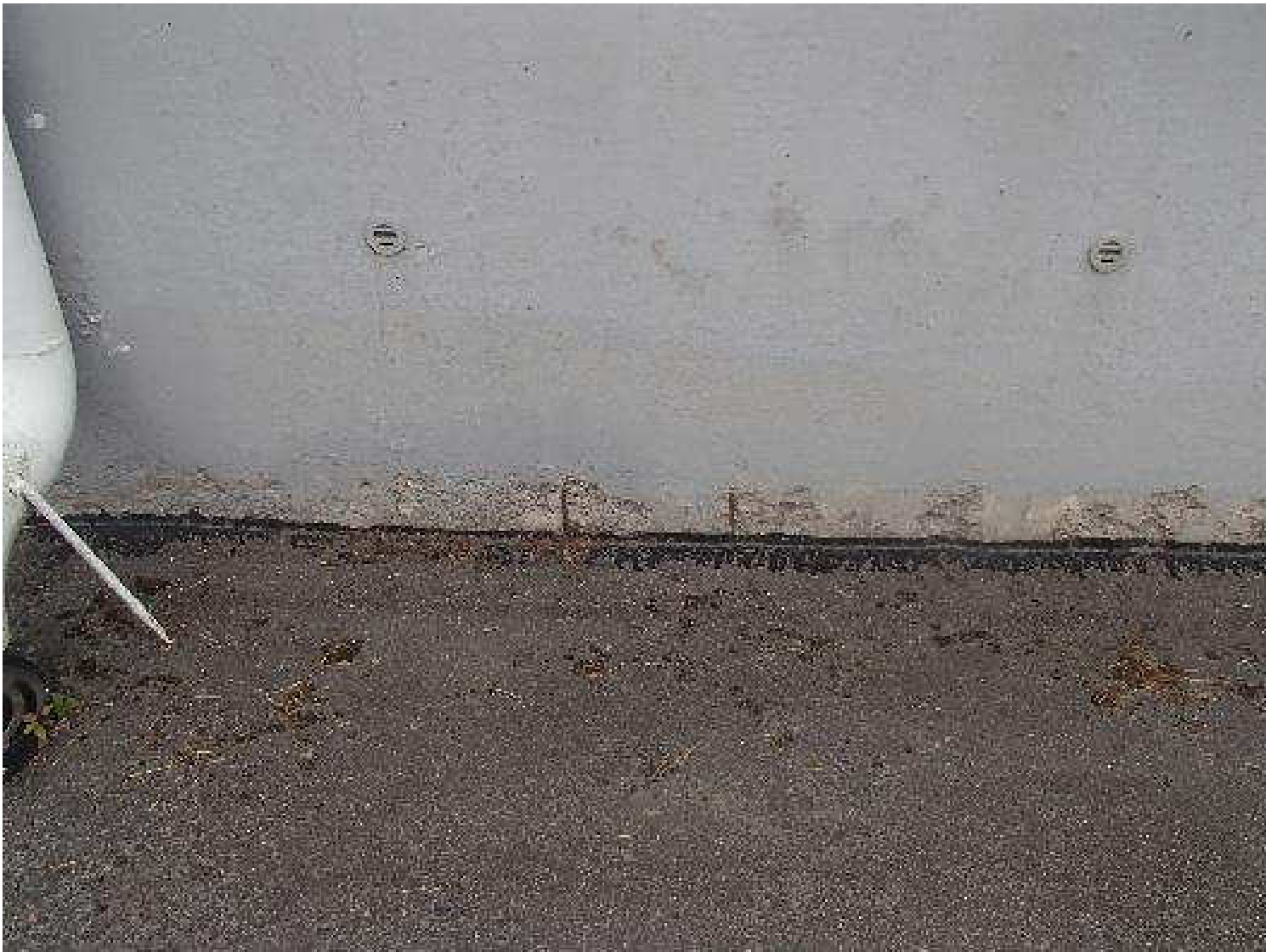
Kuva 129. Sokkelissa havaittiin raudoitusterästen korroosion aiheuttamia vaurioita ja rapautumista.
