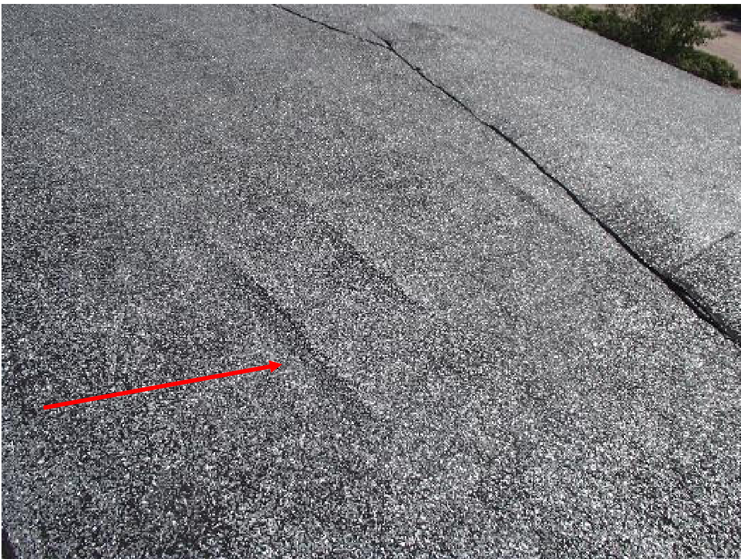
Kuva 139. Vesikattojen bitumikermässä havaittiin poimuuntumista.
