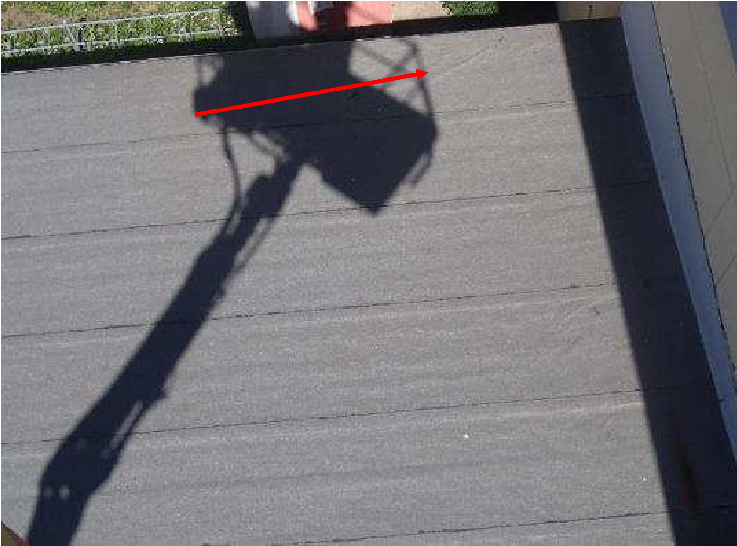
Kuva 138. Vesikattojen bitumikermässä havaittiin poimuuntumista.
