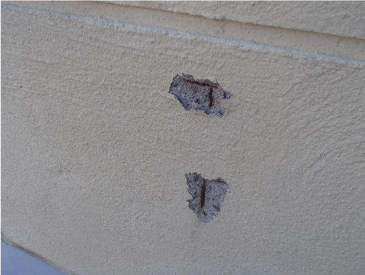
Kuva 106. Betonielementtien pinnasta on irronnut betonipalasia betoniterästen korroosion seurauksena ja irronneiden palasten takaa ovat ruostuneet raudoitusteräket tulleet esiin.
