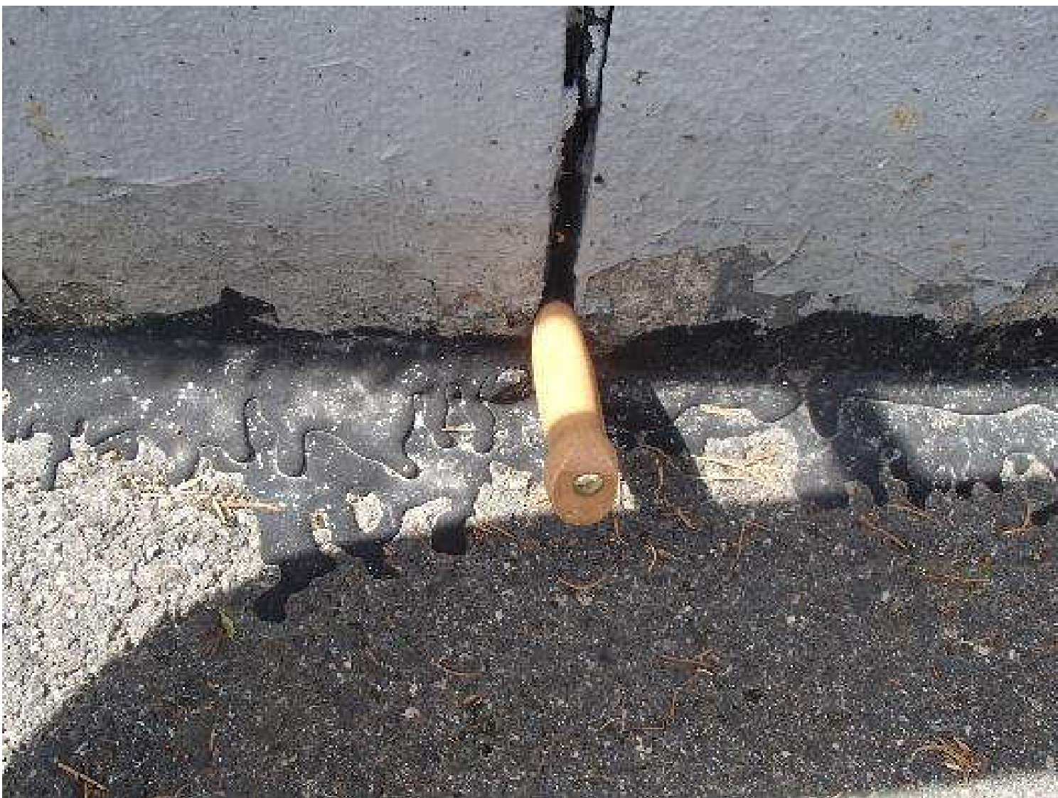
Kuva 135. Sokkelin liikuntasaumot ovat vaurioituneet sekä liikuntasauvoissa on rakoja rakenteisiin.
