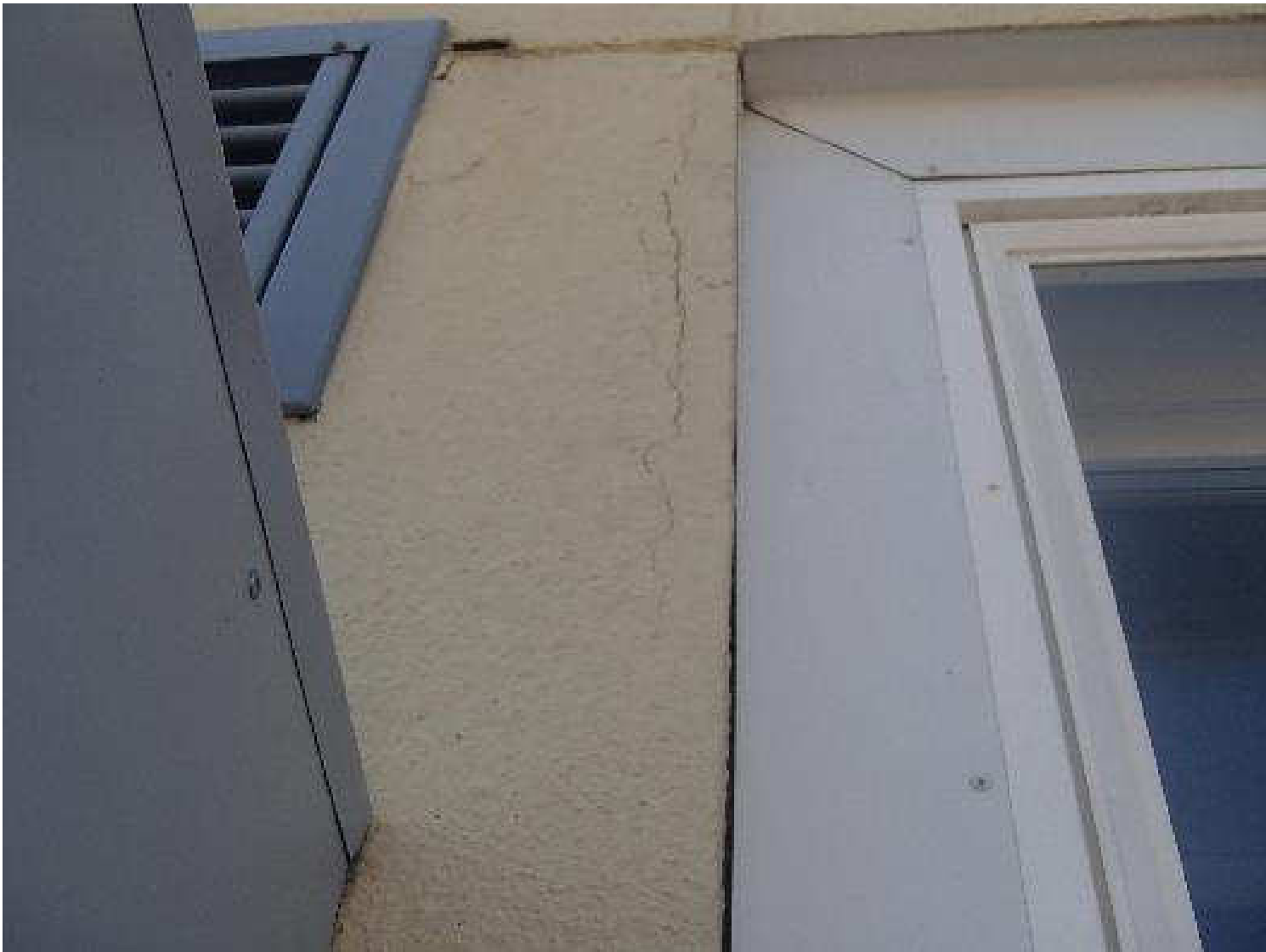
Kuva 107. Betonielementtien pinnassa havaittiin halkeilua.
