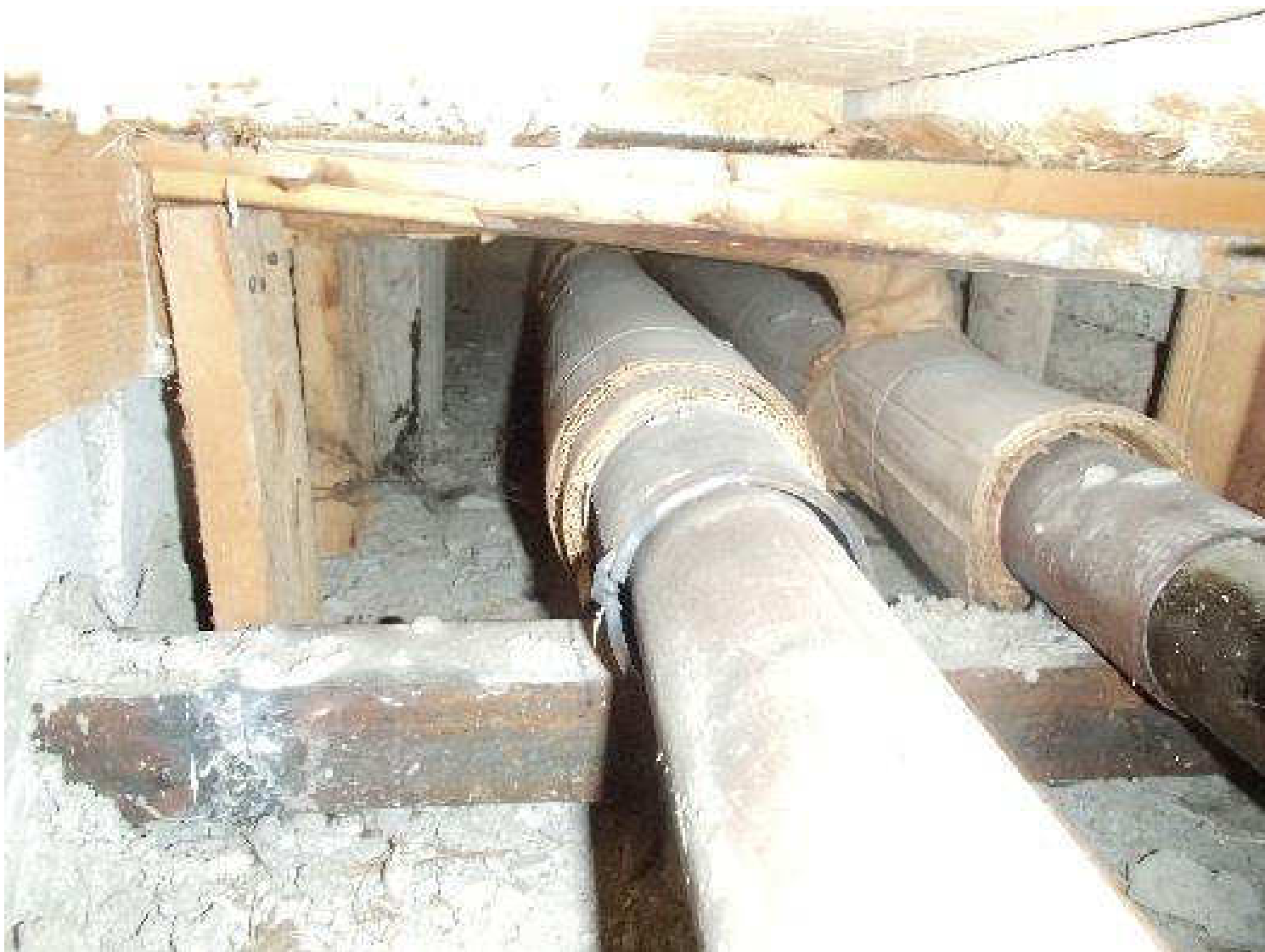
Kuva 162. Putkikanaaleissa havaittiin vanhoja rakennusmateriaaleja, jotka ovat pakoin vaurioituneet.
