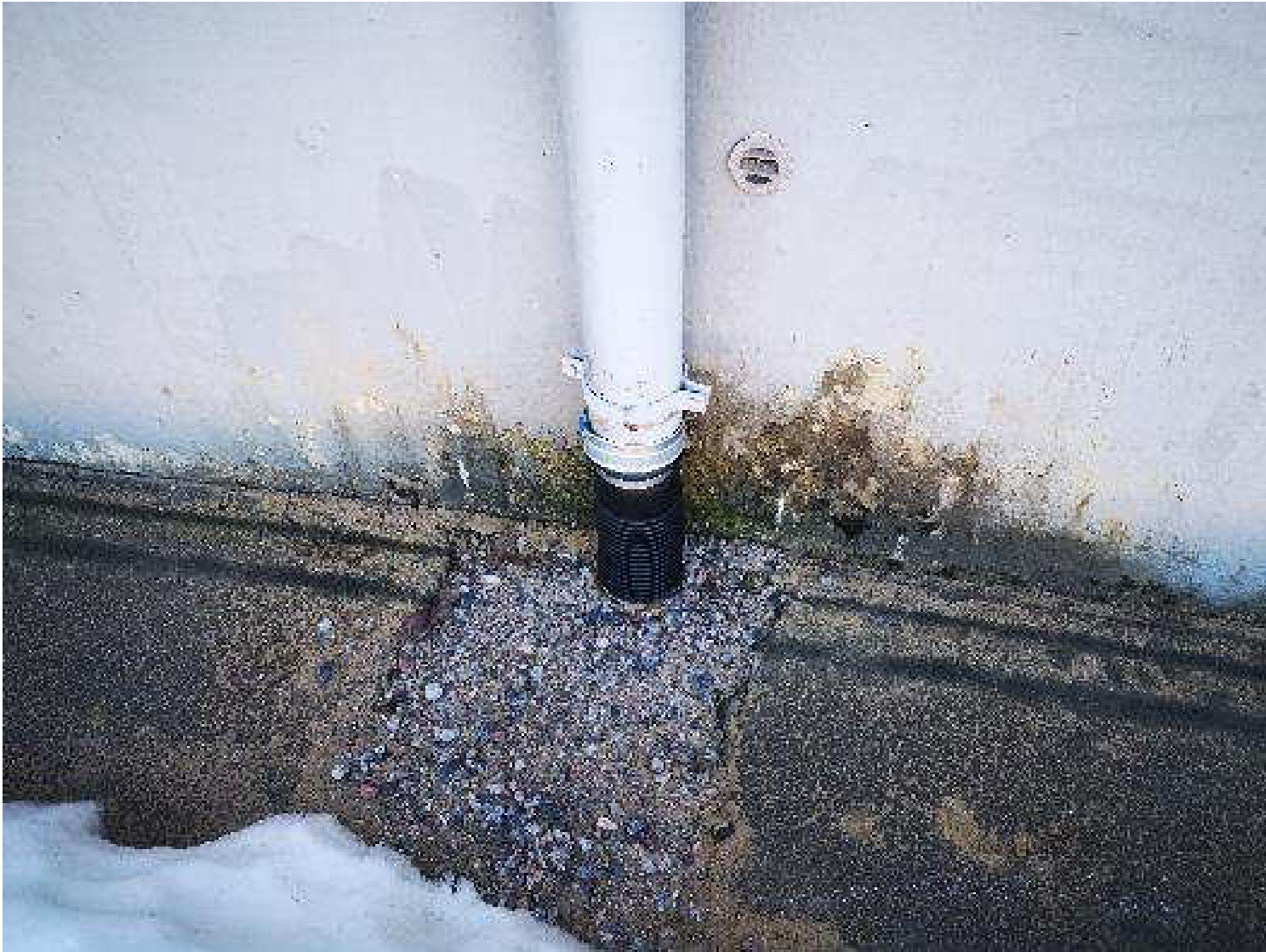
Kuva 134. Vanhojen sadevesikaivojen vierellä havaittiin sokkelissa sammaleen kasvua ja kosteusrasituksesta aiheutuneita vaurioita.
