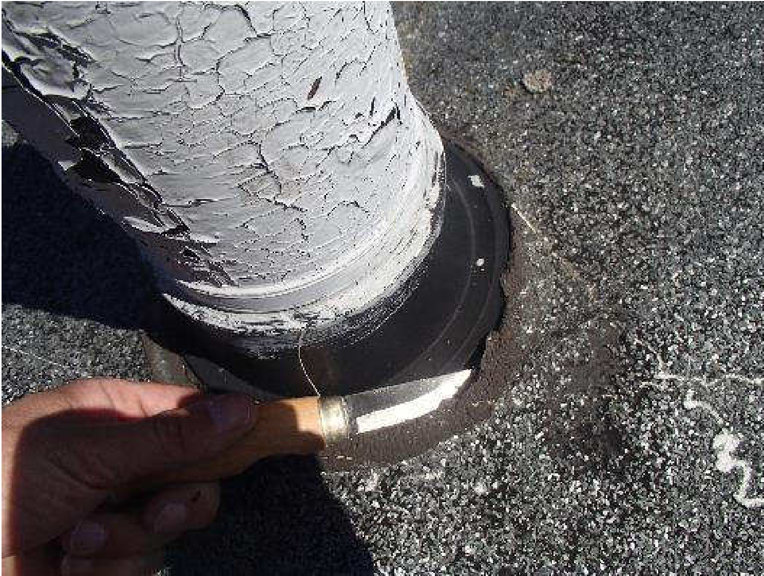
Kuva 144. Vesikattotarvikkeiden liitokset ovat paikoin ikääntyneet ja irronneet liimauksestaan.
