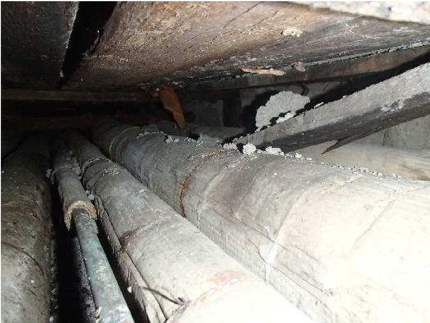
Kuva 164. Putkikanaaleissa havaittiin vanhoja rakennusmateriaaleja, jotka ovat osin vaurioituneet.
