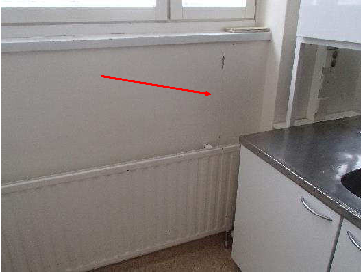
Kuva 122. Ulkovaipparakenteiden sisäseinissä havaittiin halkeilua.
