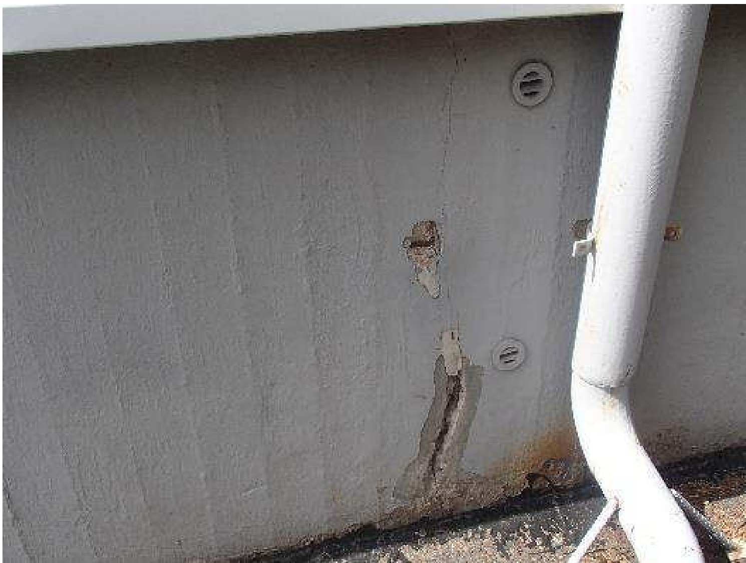
Kuva 131. Sokkelin ulkopinnassa havaittiin paikin leveää halkeilua.
