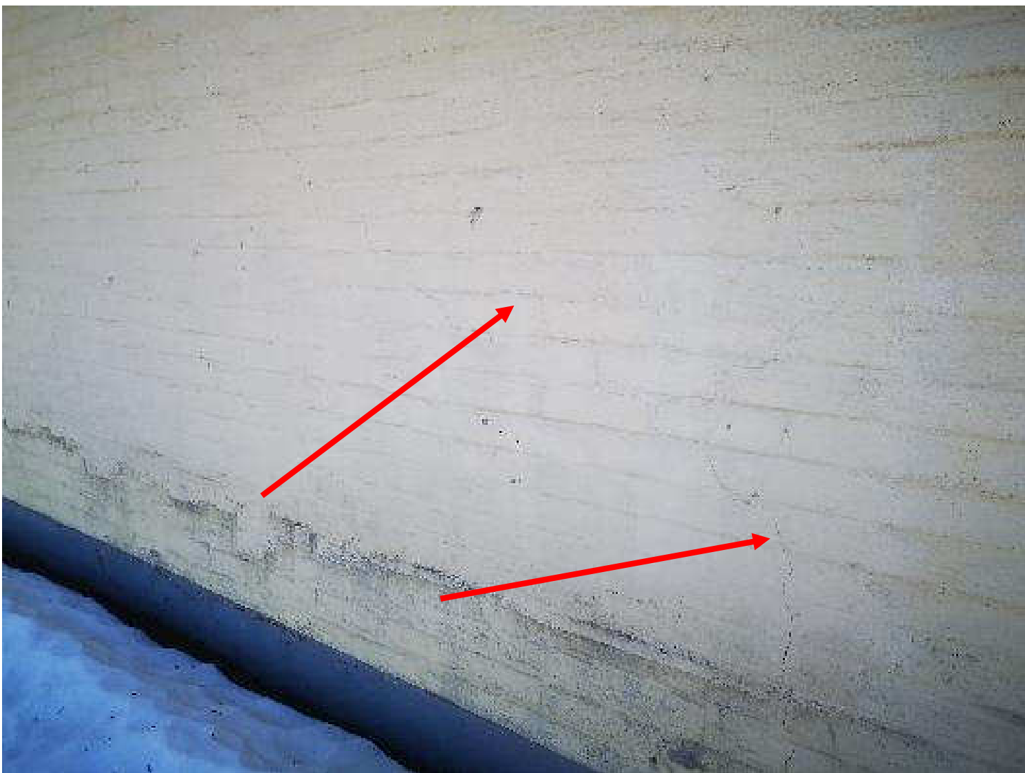
Kuva 103. Tiilimuurauksessa havaittiin tiilimurausta myötäilevää halkeilua.
