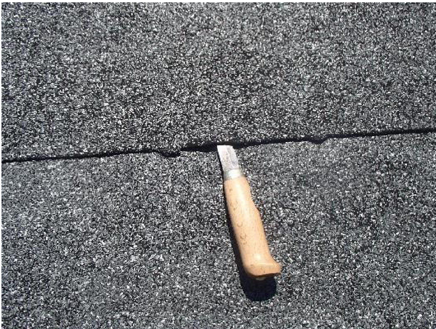
Kuva 141. Bitumikermien välissä saumoissa havaittiin aukeilua.
