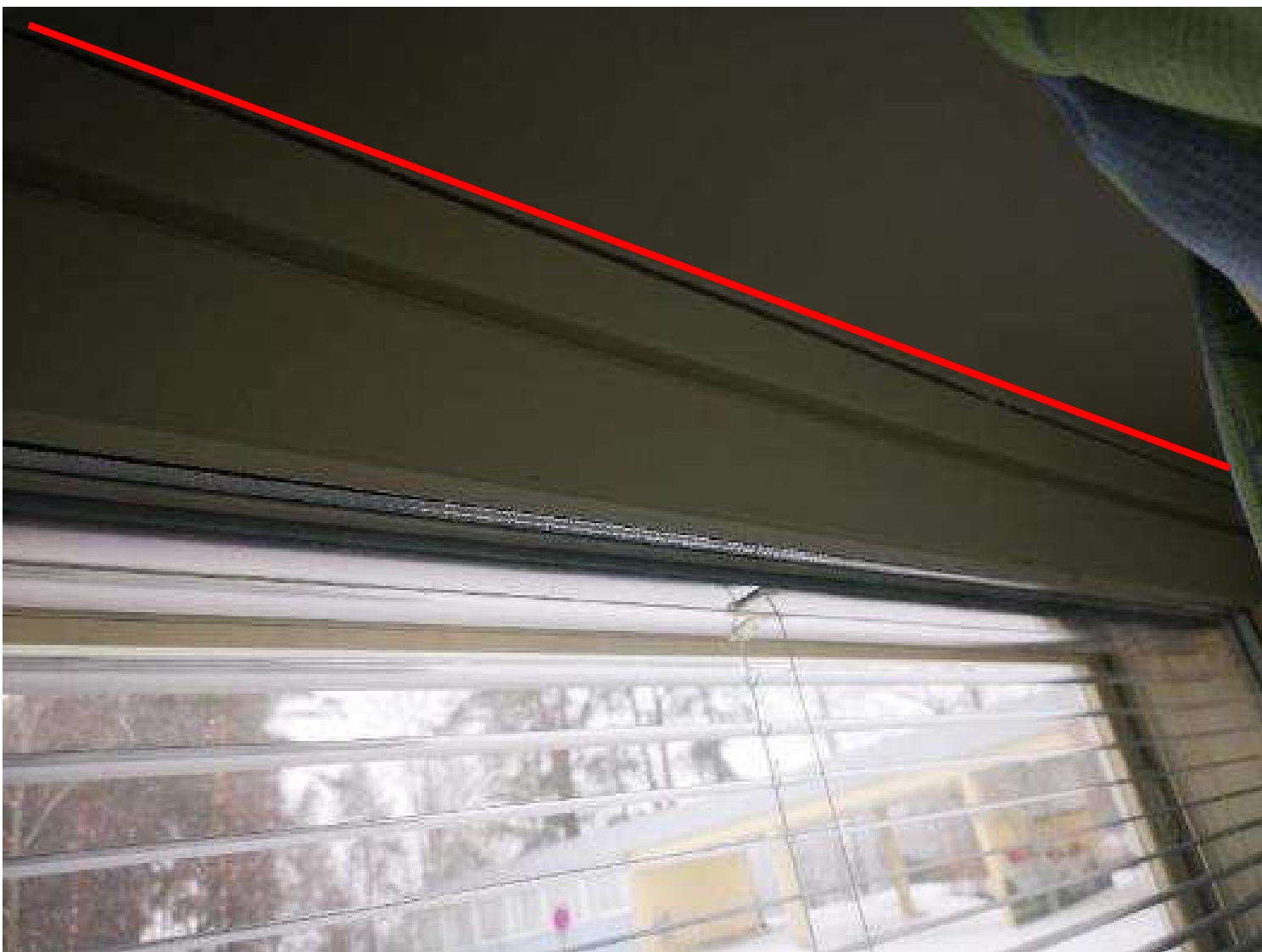
Kuva 191. Ikkunoiden peitelistojen reuna-alueiden kautta havaittiin ilmavuotoja sisäilmaan.
