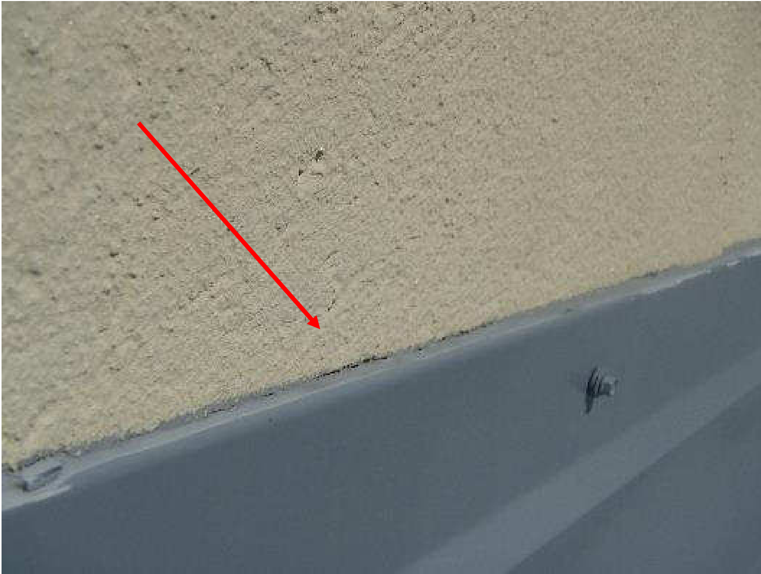
Kuva 114. Pellityksien ja julkisivujen välisissä tiivistyksissä havaittiin halkeilua.
