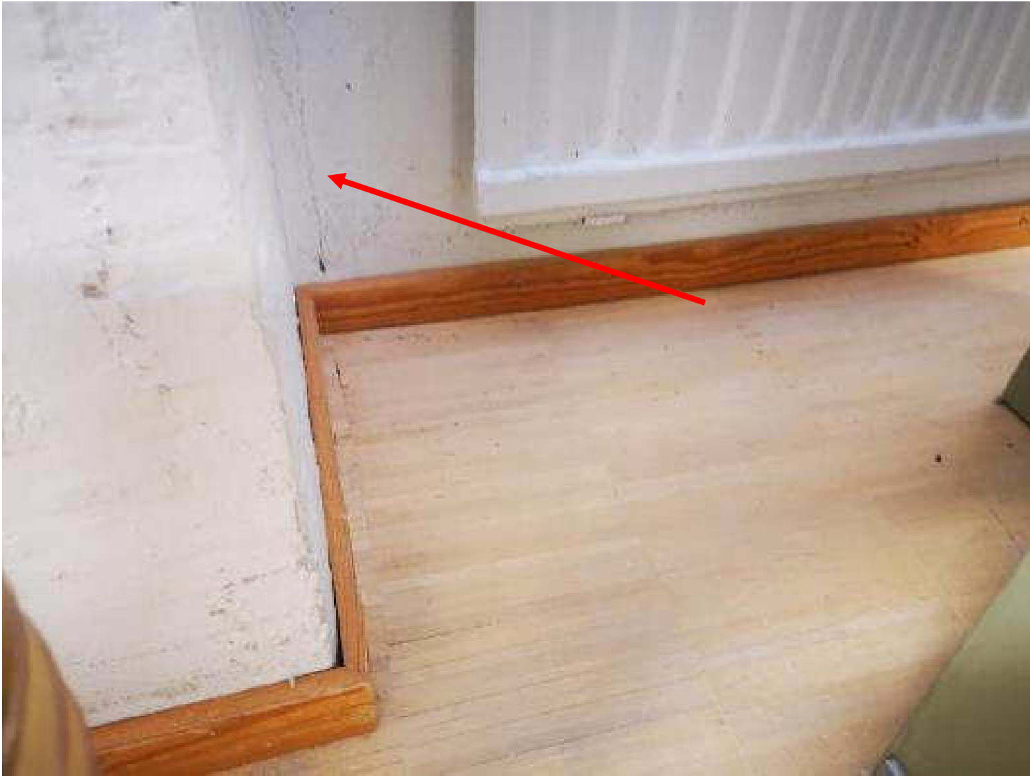
Kuva 194. Lattialistojen reuna-alueiden ja halkeamien kautta havaittiin ilmavuotoja sisäilmaan.
