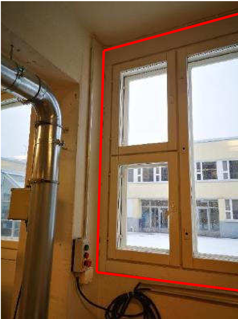
Kuva 195. Ikkunoiden peitelistöjen reuna-alueiden kautta havaittiin ilmavuotoja sisäilmaan.
