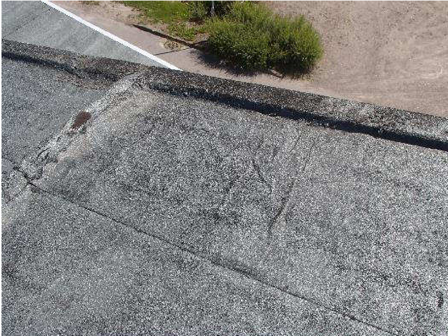
Kuva 140. Vesikattojen bitumikermässä havaittiin poimuuntumista.
