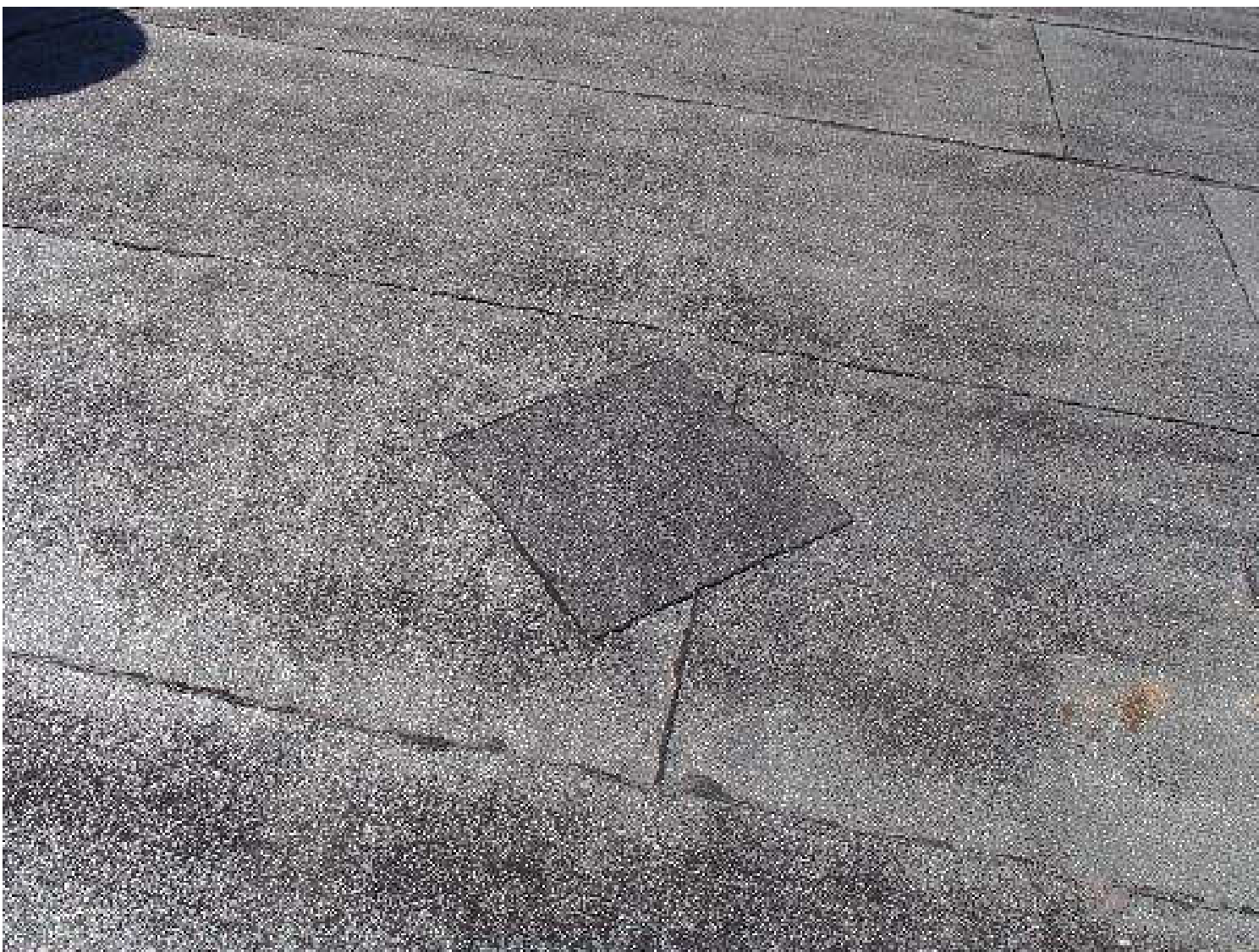
Kuva 143. Vesikattoja on paikkailtu bitumikermipaikoilla.
