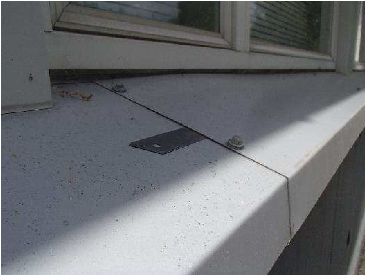
Kuva 115. Vesipeltien liitoksia ei ole tiivistetty.
