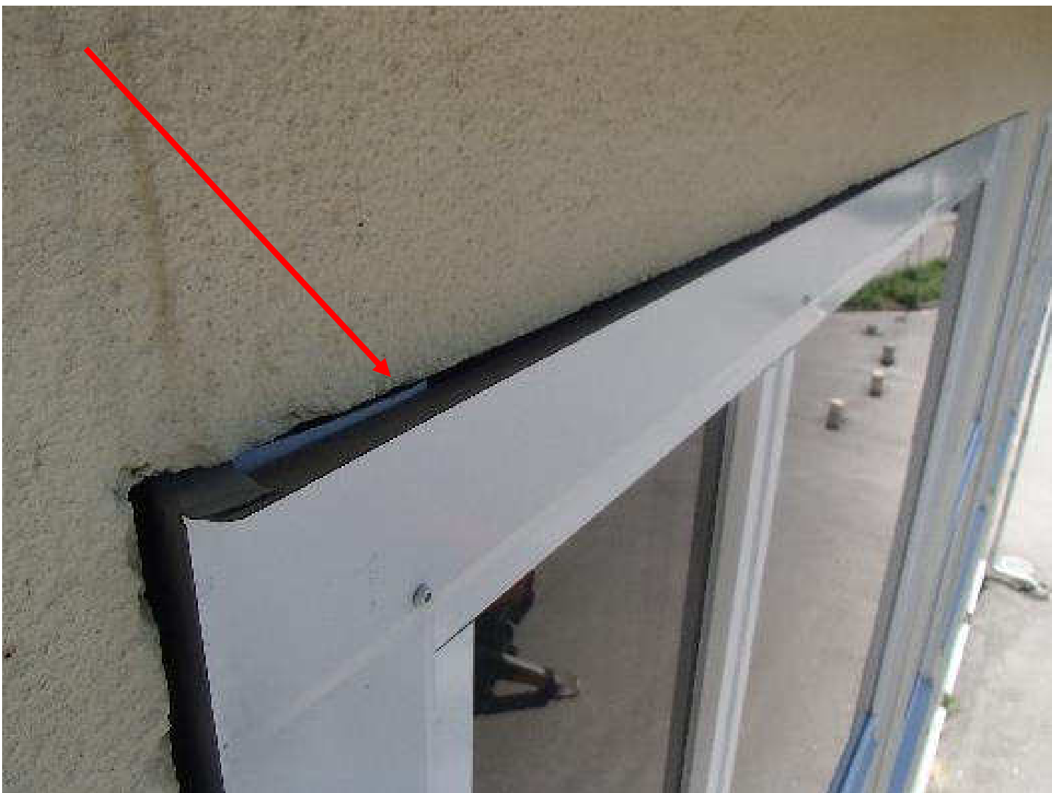
Kuva 117. Ikkunoiden pellitykset ohjaavat paikoin julkisivuja pitkin valuvan veden rakenteisiin.
