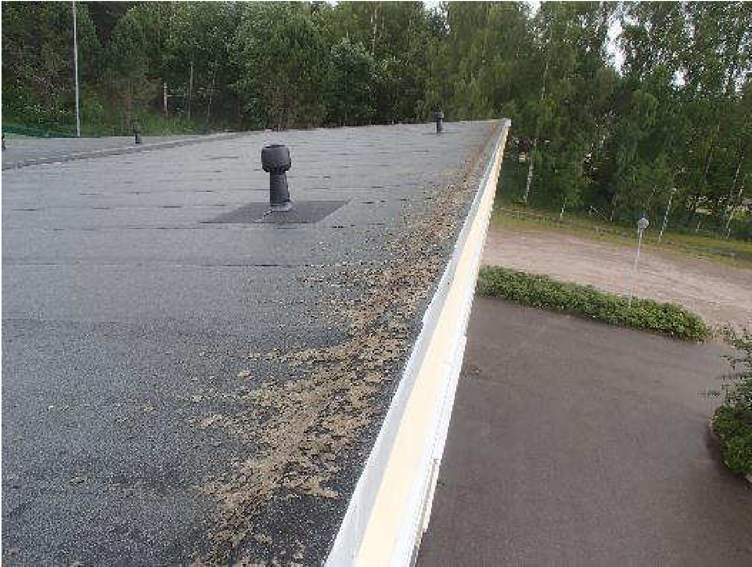
Kuva 148. Paikoin vesikatolla kasvaa sammalta ja jäkälää.
