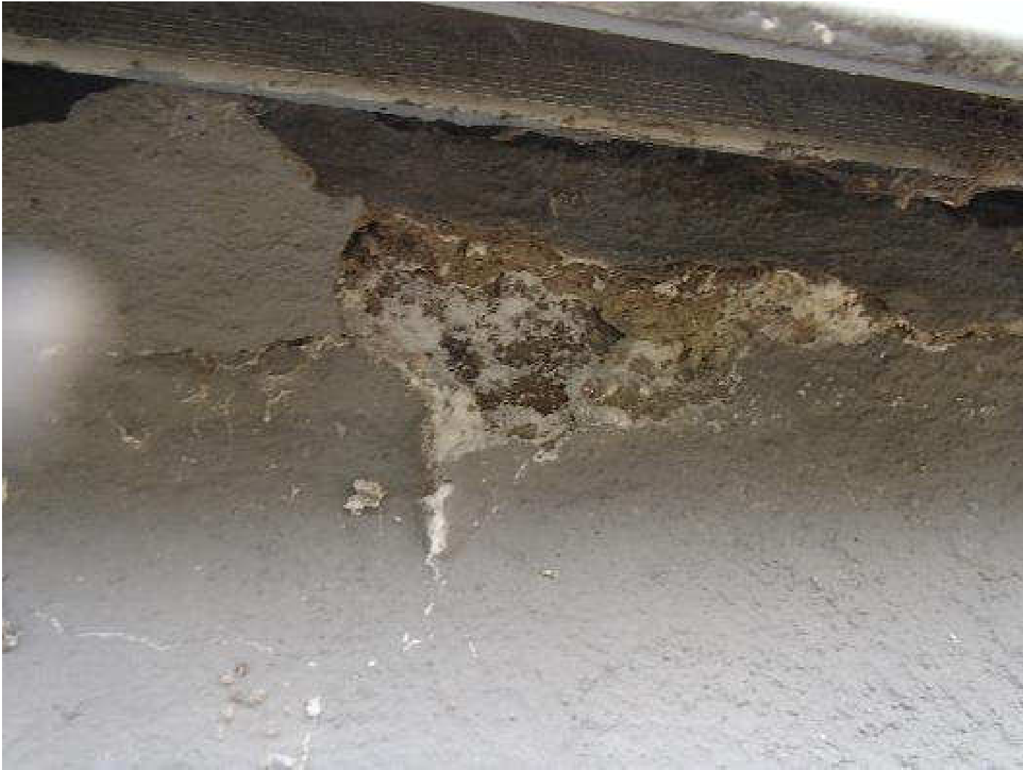
Kuva 126. Sokkelin ulkopinnoilla havaittiin kalkkihärmekertymiä ja rapautumista.
