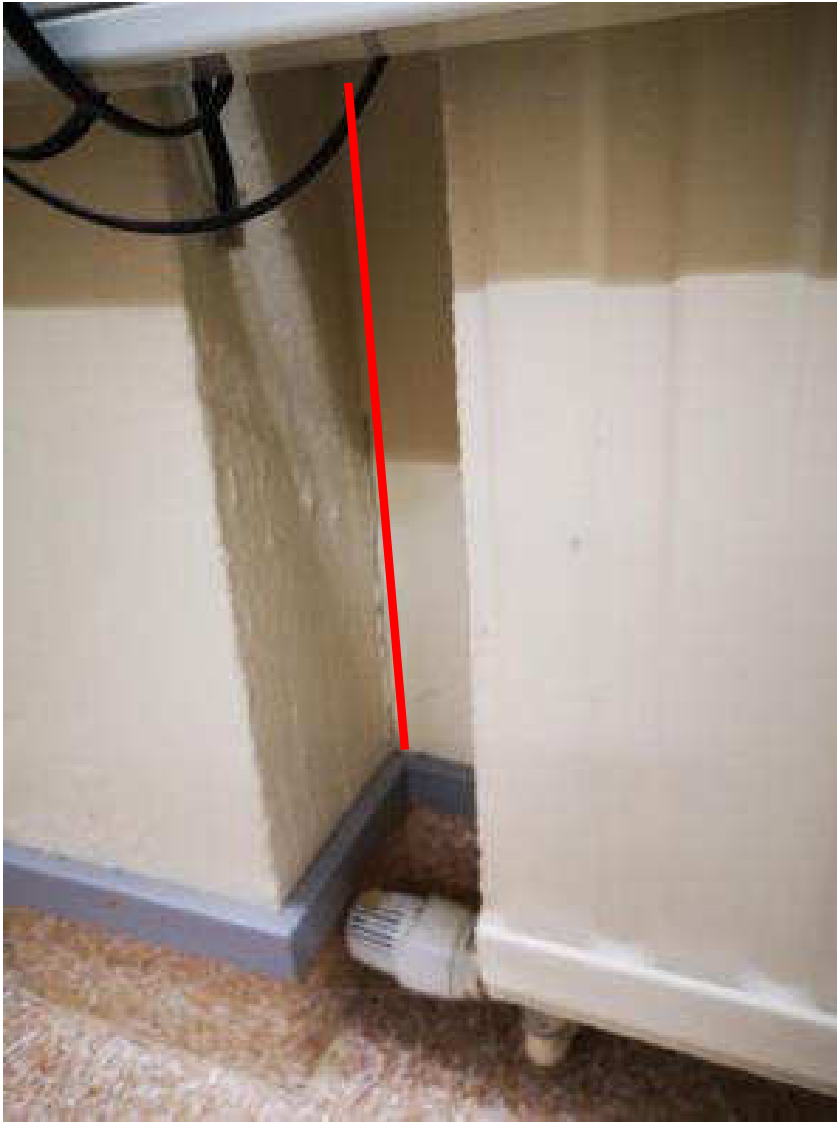
Kuva 198. Levyrakenteisten seinien ja kantavien pilareiden rajapinnoilta havaittiin ilmavuo- toja sisäilmaan.
