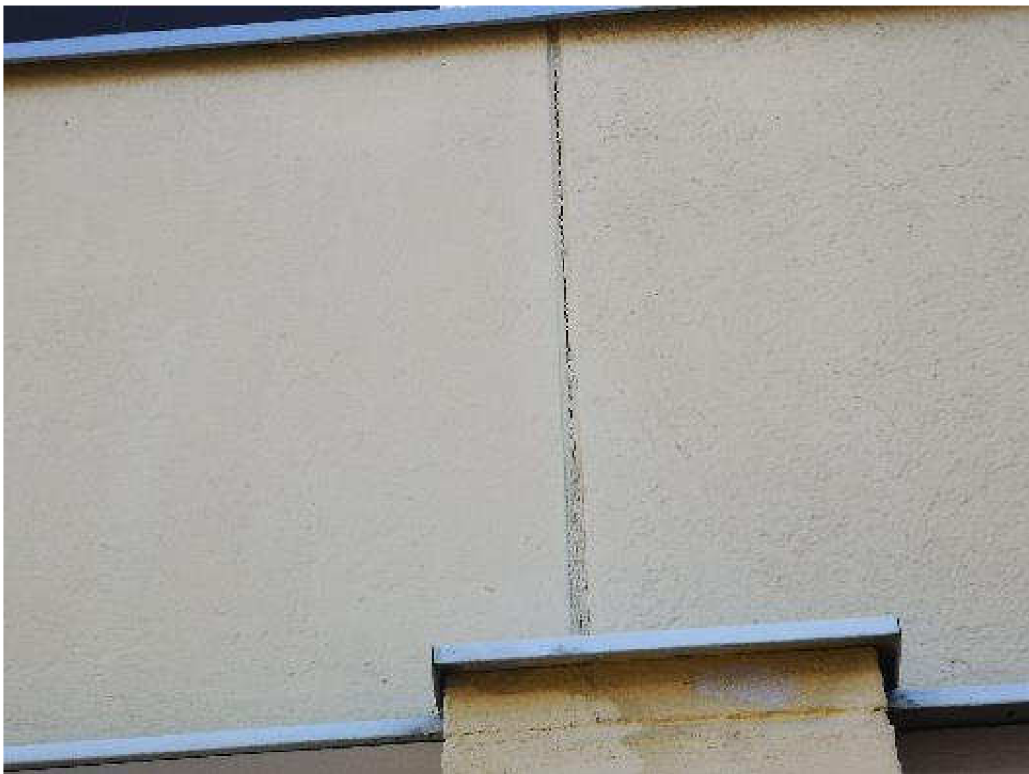
Kuva 119. Julkisivujen elementtisaumoissa havaittiin halkeilua ja ikääntymistä.
