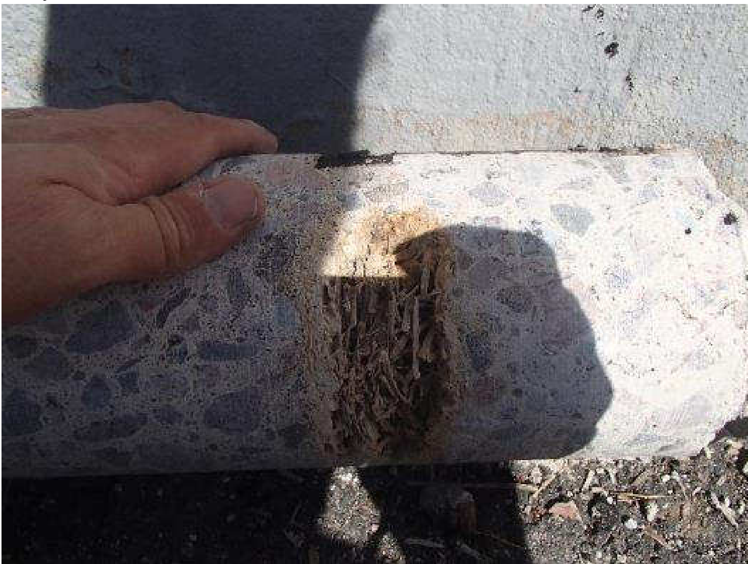
Kuva 57. Rakenneavaus, JS16, betonisokkeliin. Sokkelin eristehalkaisun eristeenä havaittiin sementtikuitulevy (Toja).
