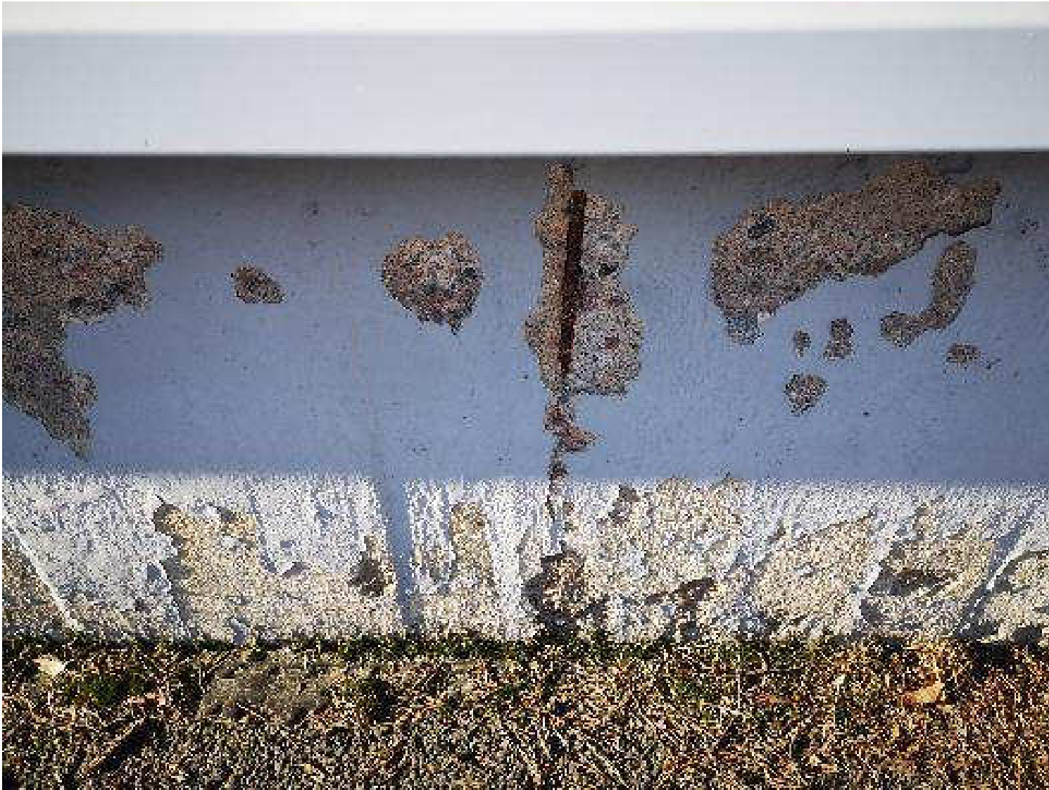
Kuva 128. Sokkelissa havaittiin raudoitusterästen korroosion aiheuttamia vaurioita ja rapautumista.
