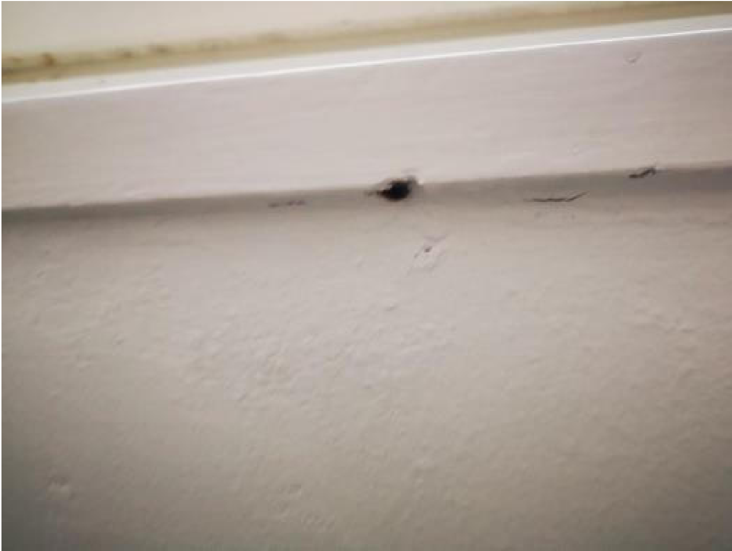
Kuva 192. Ilmavuotoja havaittiin seinien reikien kautta.
