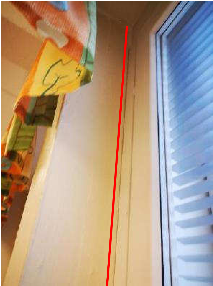
Kuva 197. Ikkunoiden peitelistojen reuna-alueilta havaittiin ilmavuotoja sisäilmaan.
