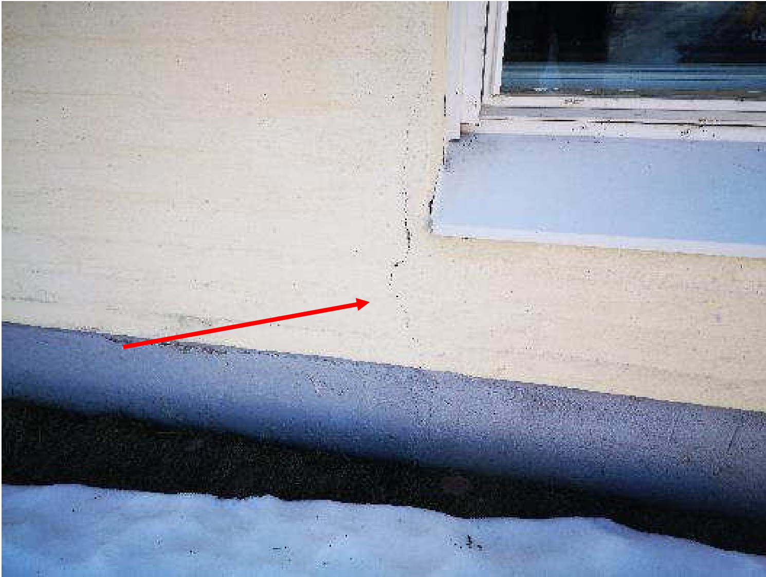
Kuva 102. Tiilimuurauksessa havaittiin halkeilua.
