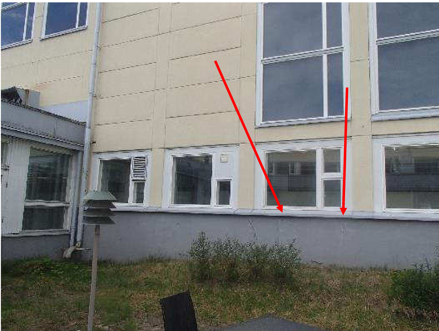
Kuva 127. Sokkelin ulkopinnoilla havaittiin kalkkihärmekertymiä.
