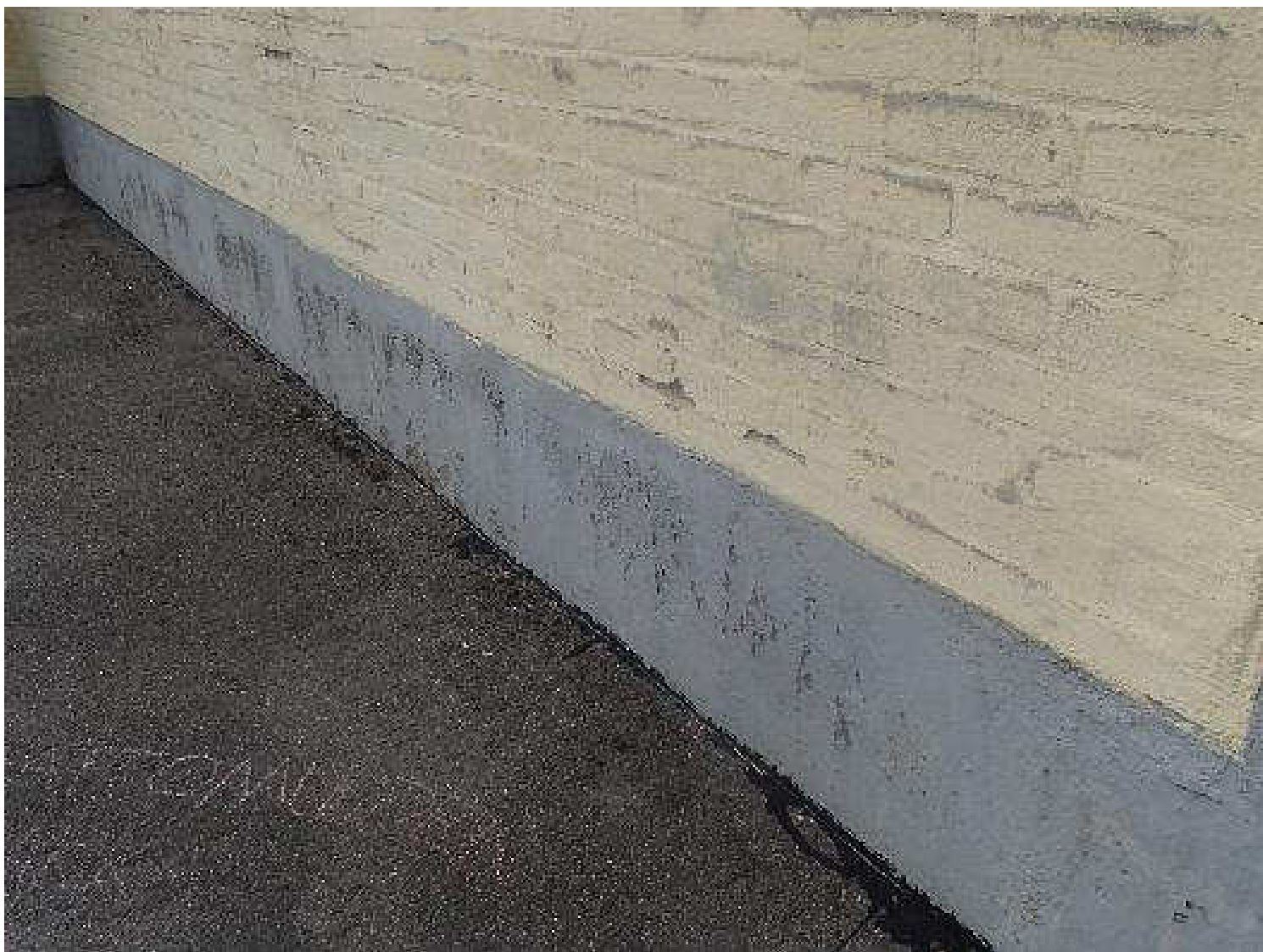
Kuva 99. Tiilimuurauksen alimman rivillä ei havaittu tuuletusrakoja ja tiilimuurauksen saumat ovat rapautuneet.
