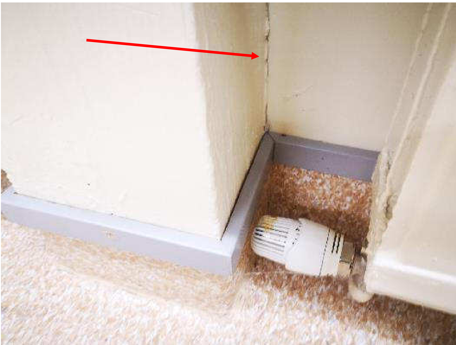
Kuva 123. Levyseinien ja pilarien liitoksissa havaittiin halkeilua.
