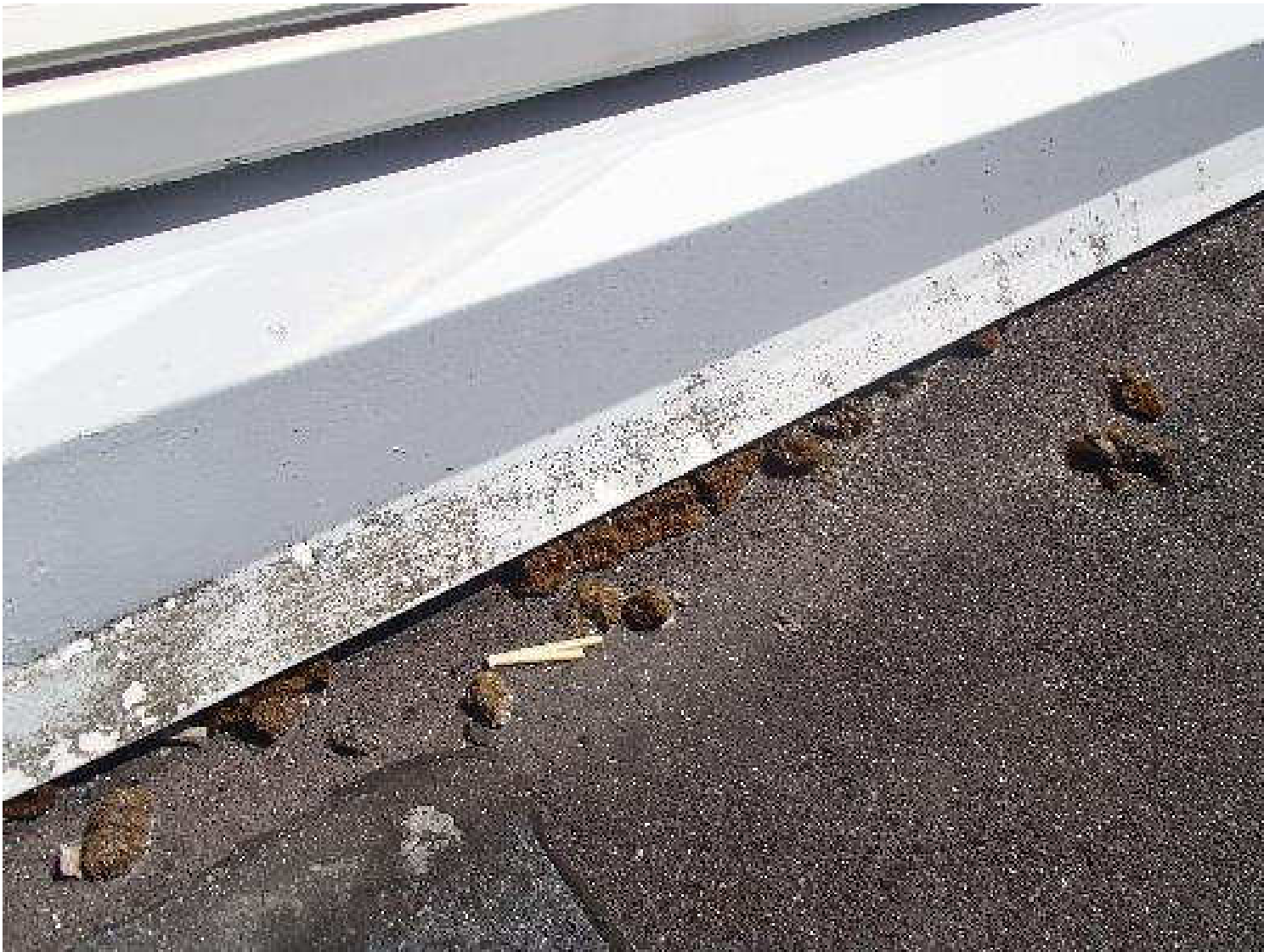
Kuva 149. Paikoin vesikatolla kasvaa sammalta ja jäkälää.
