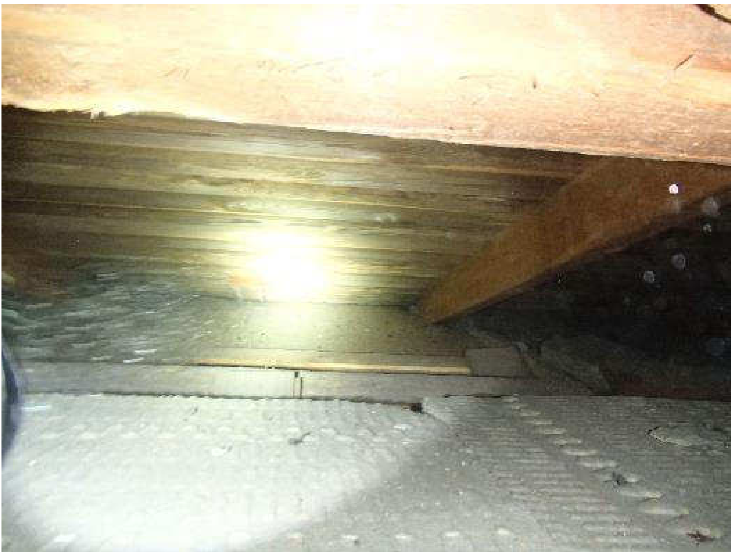
Kuva 155. Liikuntasalin yläpohjan tuuletus on tukittu räystäältä lämmöneristeellä.
