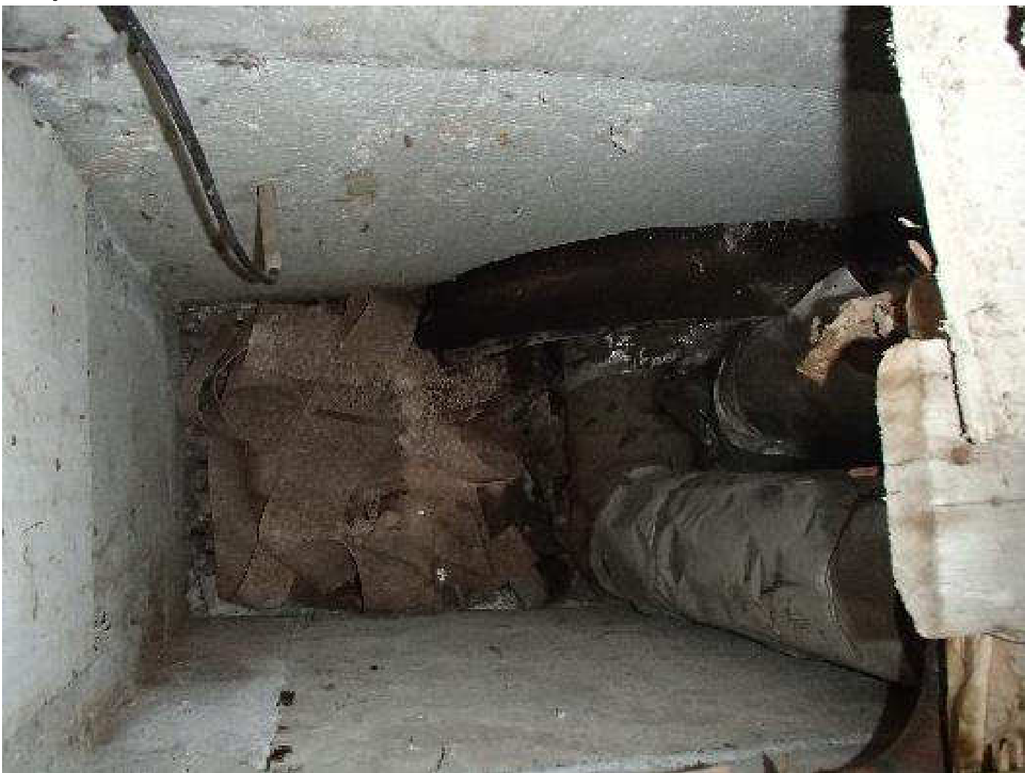
Kuva 166. Kotitalousluokan kUILUissa havaittiin vanhoja vaurioituneita rakennusmateriaaleja.
