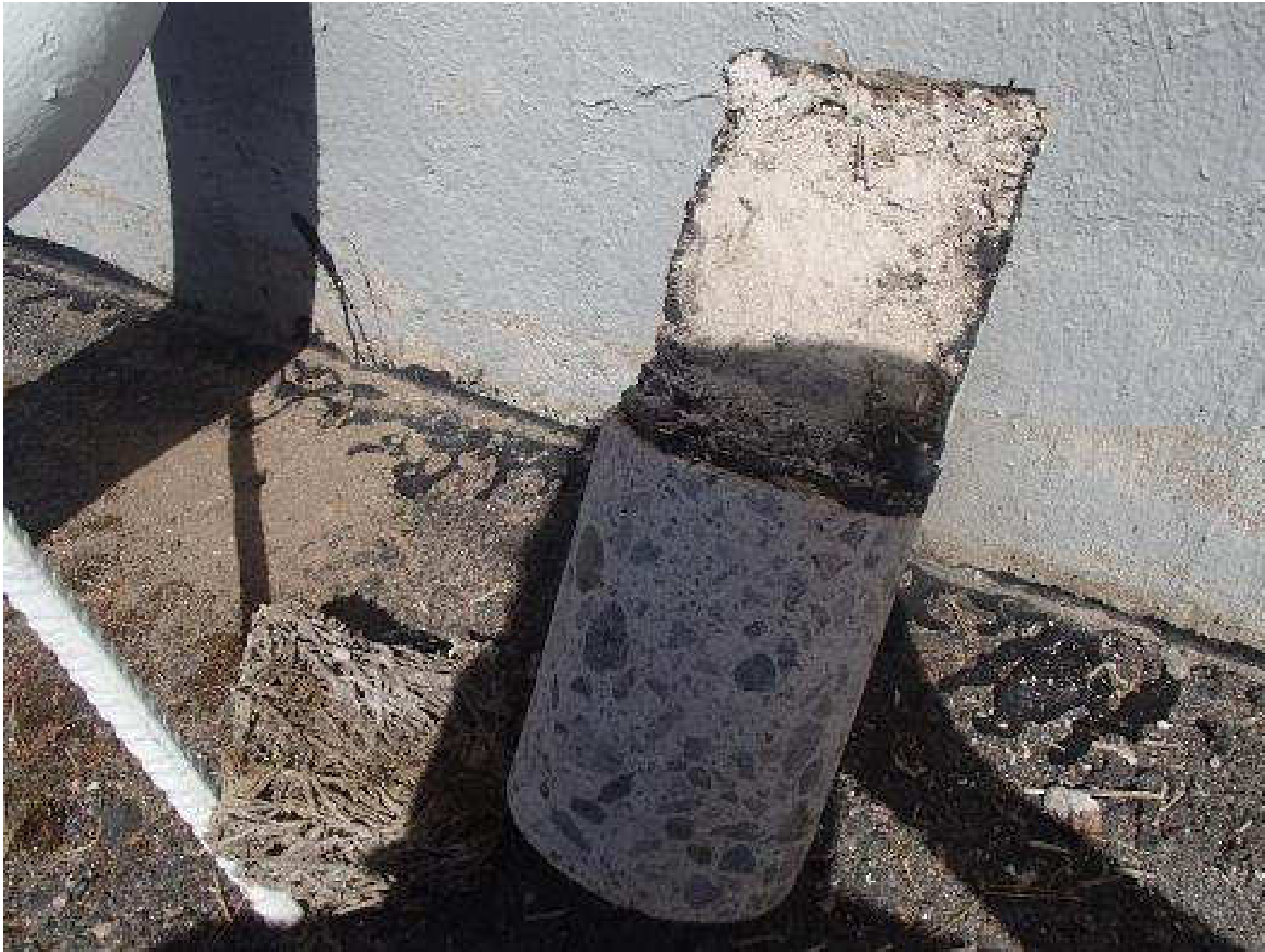
Kuva 56. Rakenneavaus, JS16, betonisokkeliin. Eristehalkaisun alaosaan havaittiin bitumisivelyä.
