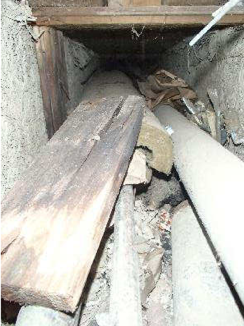
Kuva 163. Putkikanaaleissa havaittiin vanhoja rakennusmateriaaleja, jotka ovat osin vaurioituneet.
