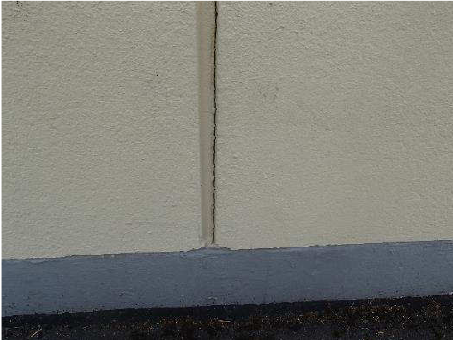
Kuva 120. Julkisivujen kiinteissä elementtisaumoissa havaittiin halkeilua.
