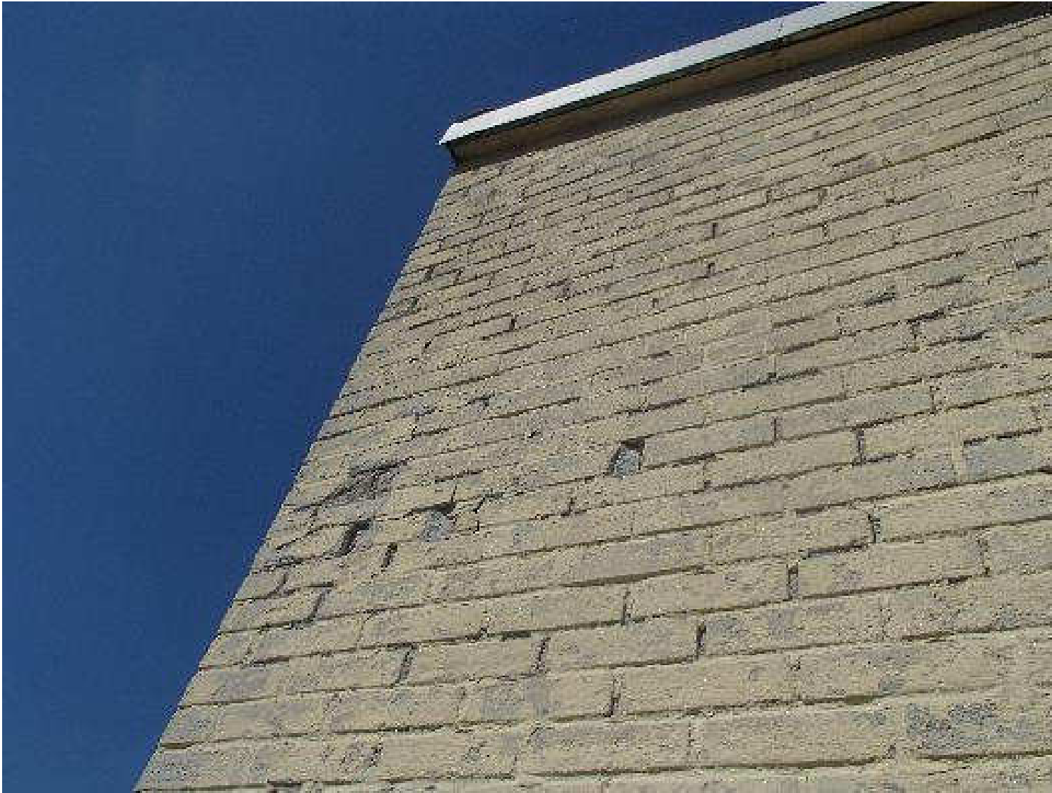
Kuva 100. Tiilimuurauksen pinnassa havaittiin rikkoutuneita tiiliä ja vaurioita erityisesti korkean rasituksen alueilla.
