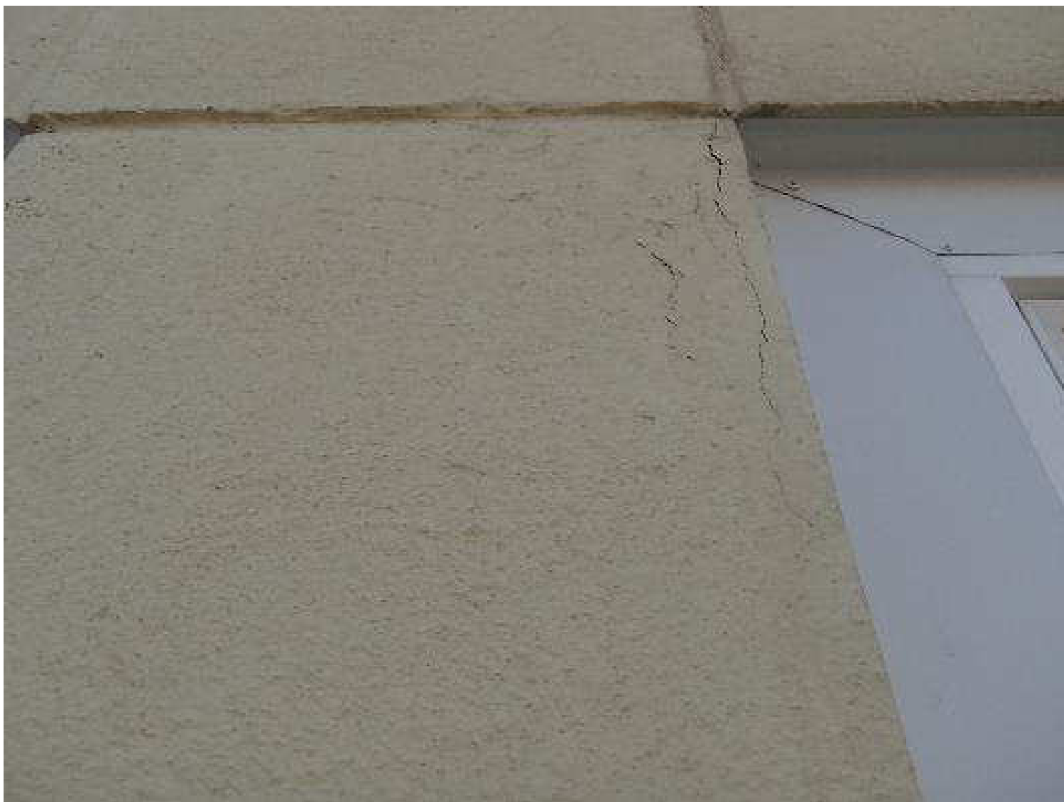
Kuva 105. Betonielementtien pinnassa havaittiin halkeilua erityisesti pielissä.
