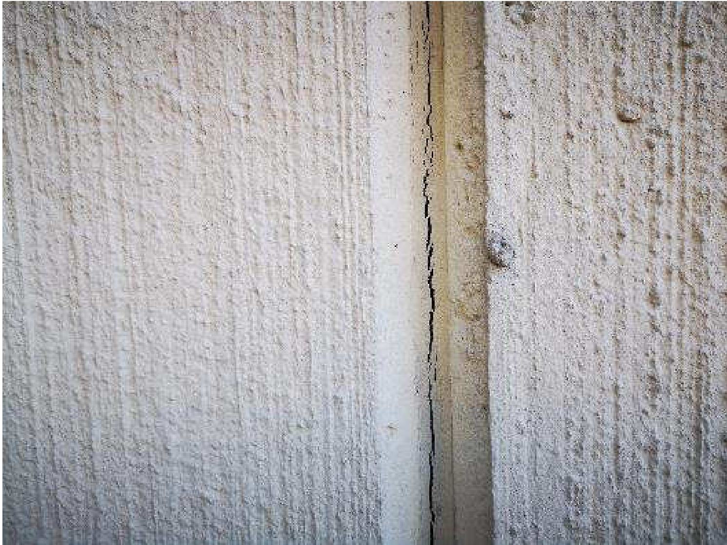
Kuva 118. Julkisivujen elementtisaumoissa havaittiin halkeilua ja ikääntymistä.
