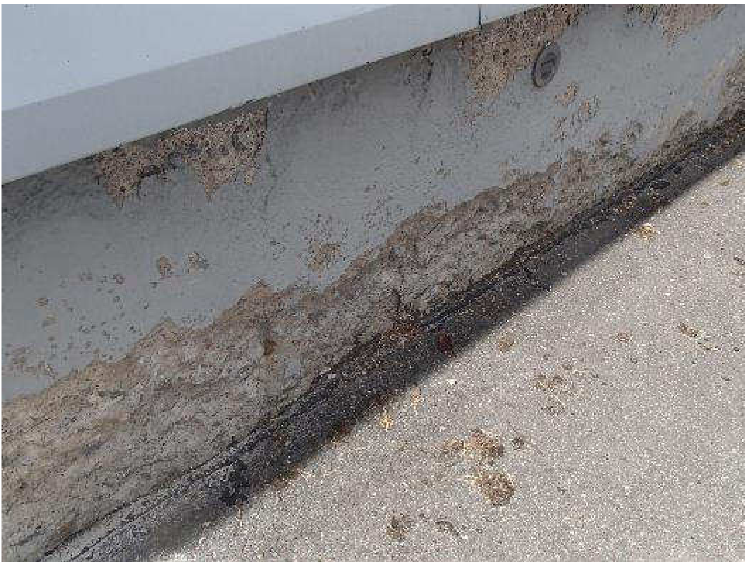
Kuva 133. Sokkelin ulkopinnassa havaittiin paikoin pitkälle edennyttä rapautumista.
