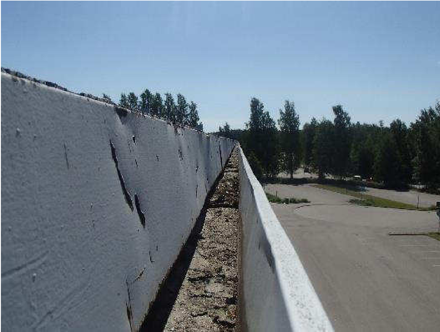
Kuva 150. Sadevesikouruissa havaittiin maatonutta lehtijätettä.
