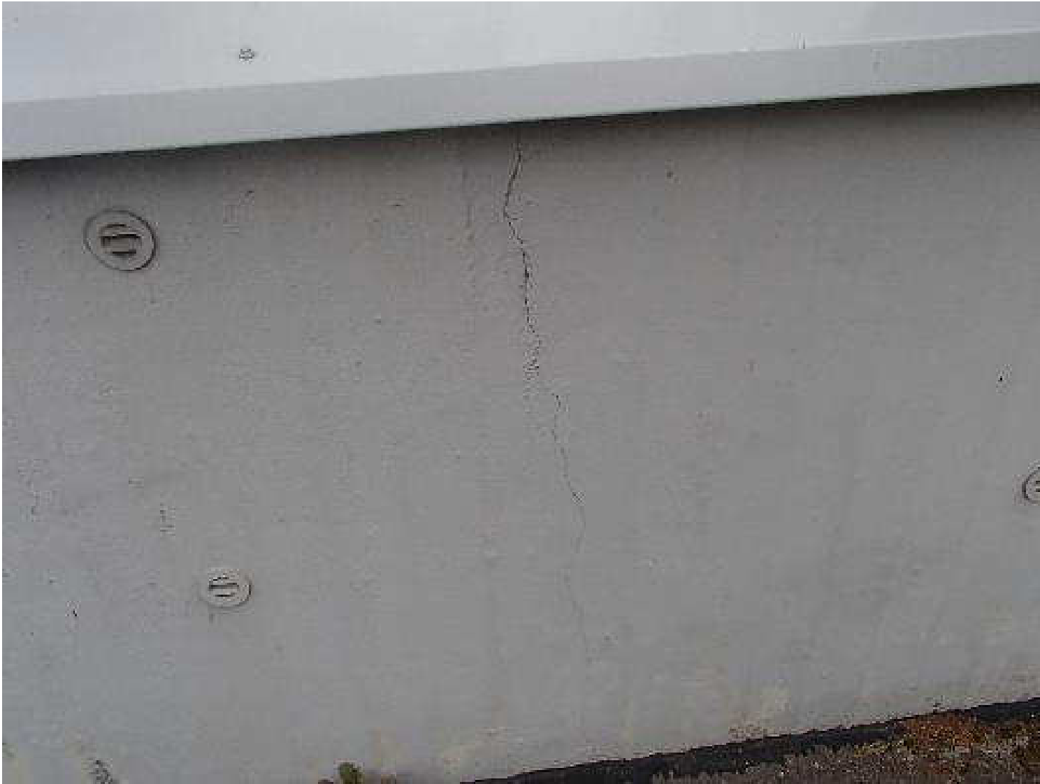
Kuva 132. Sokkelissa havaittiin halkeilua.
