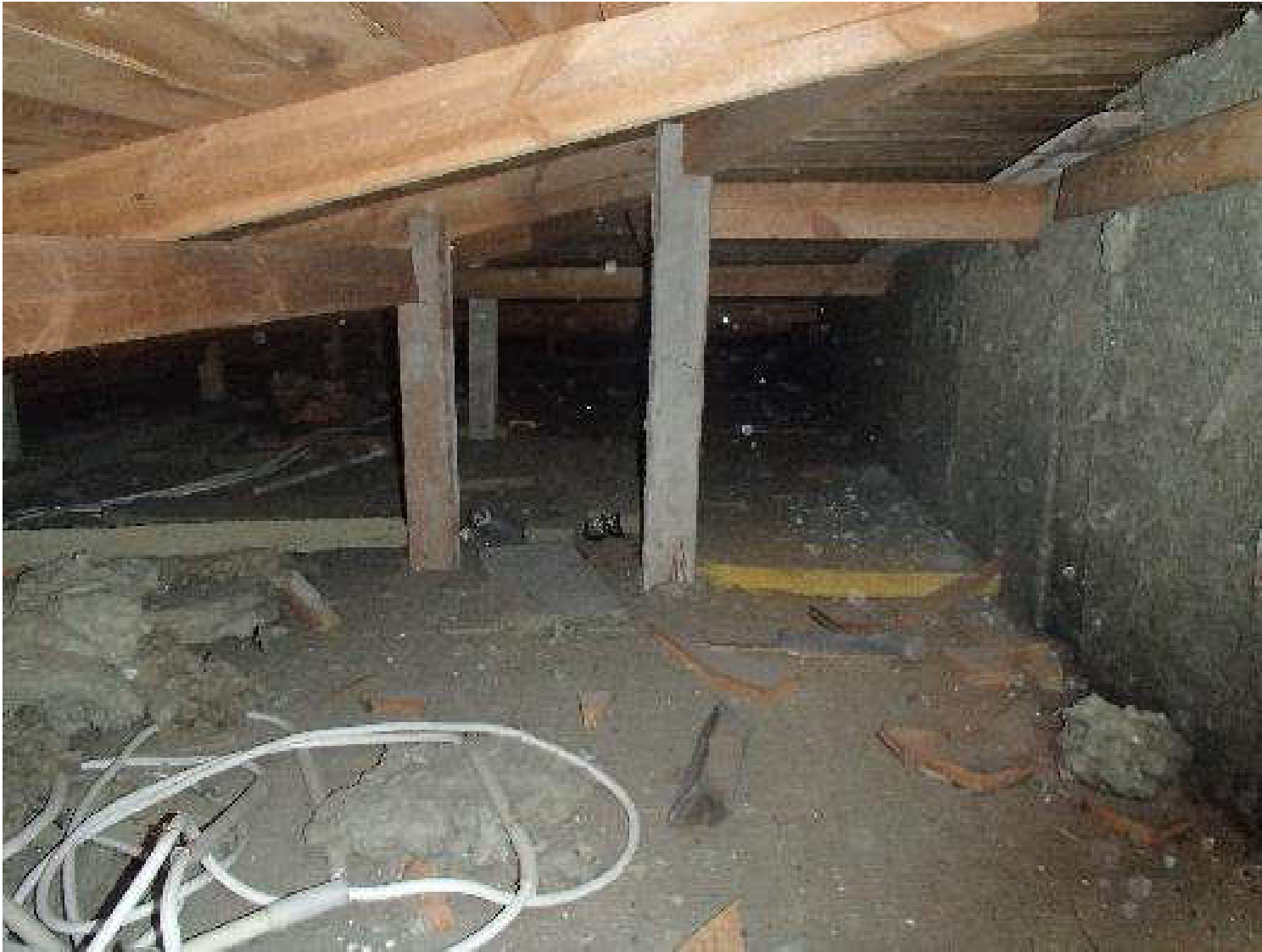
Kuva 154. Liikuntasalin yläpohjassa havaittiin ylimääräistä jätekuormaa.
