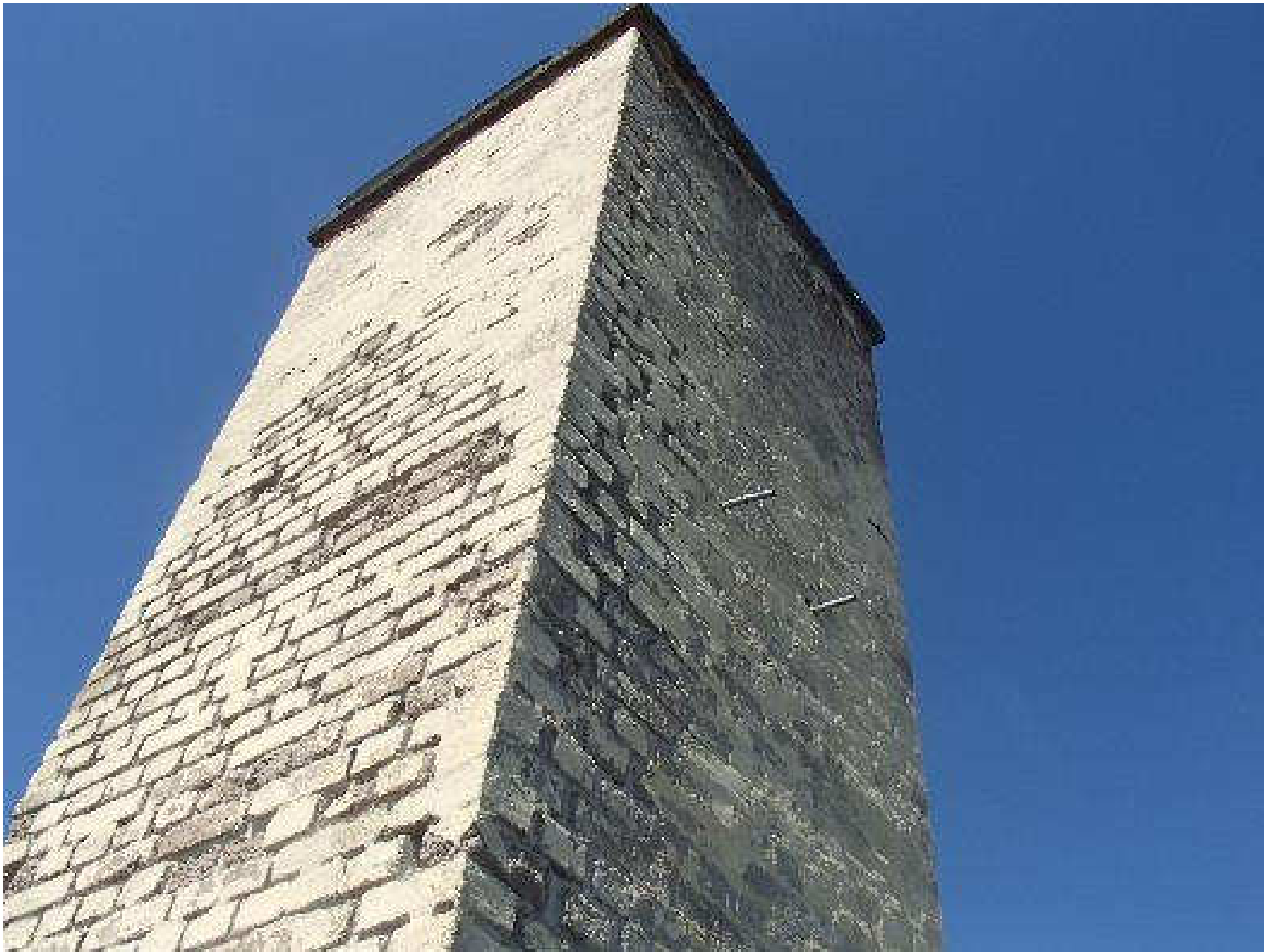
Kuva 101. Piipun tiilimuurauksen pinnassa havaittiin vaurioituneita tiiliä ja rapautumista saumalaastissa.
