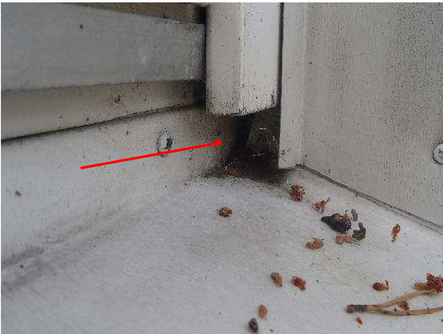
Kuva 113. Vesipeltien kulmissa havaittiin rakoja rakenteisiin.
