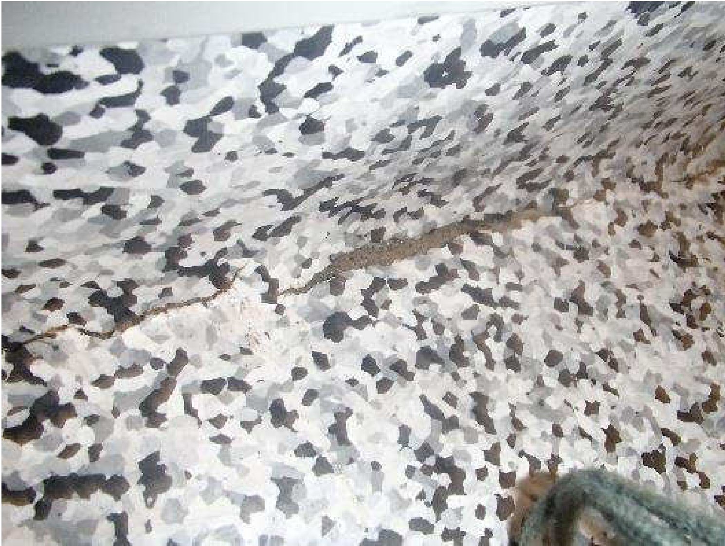
Kuva 167. Muutamassa luokassa havaittiin vaurioituneita lattiamattoja.
