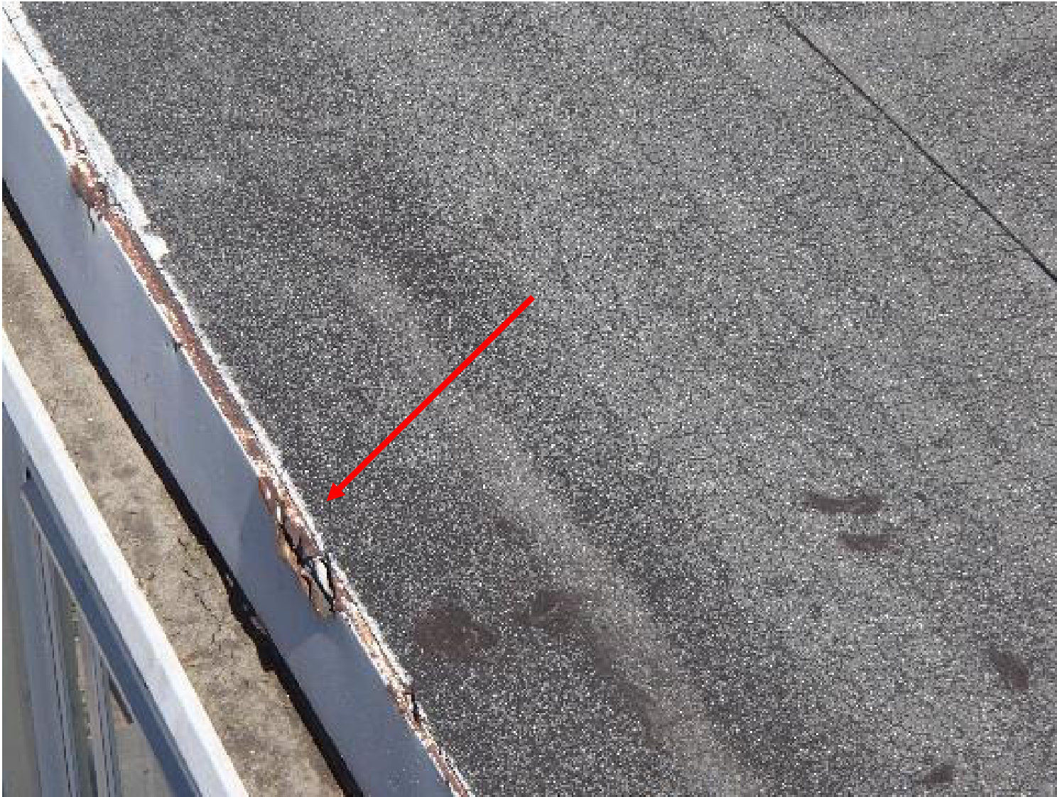
Kuva 152. Liikuntasalin reunapellityksissä havaittiin vaurioita.
