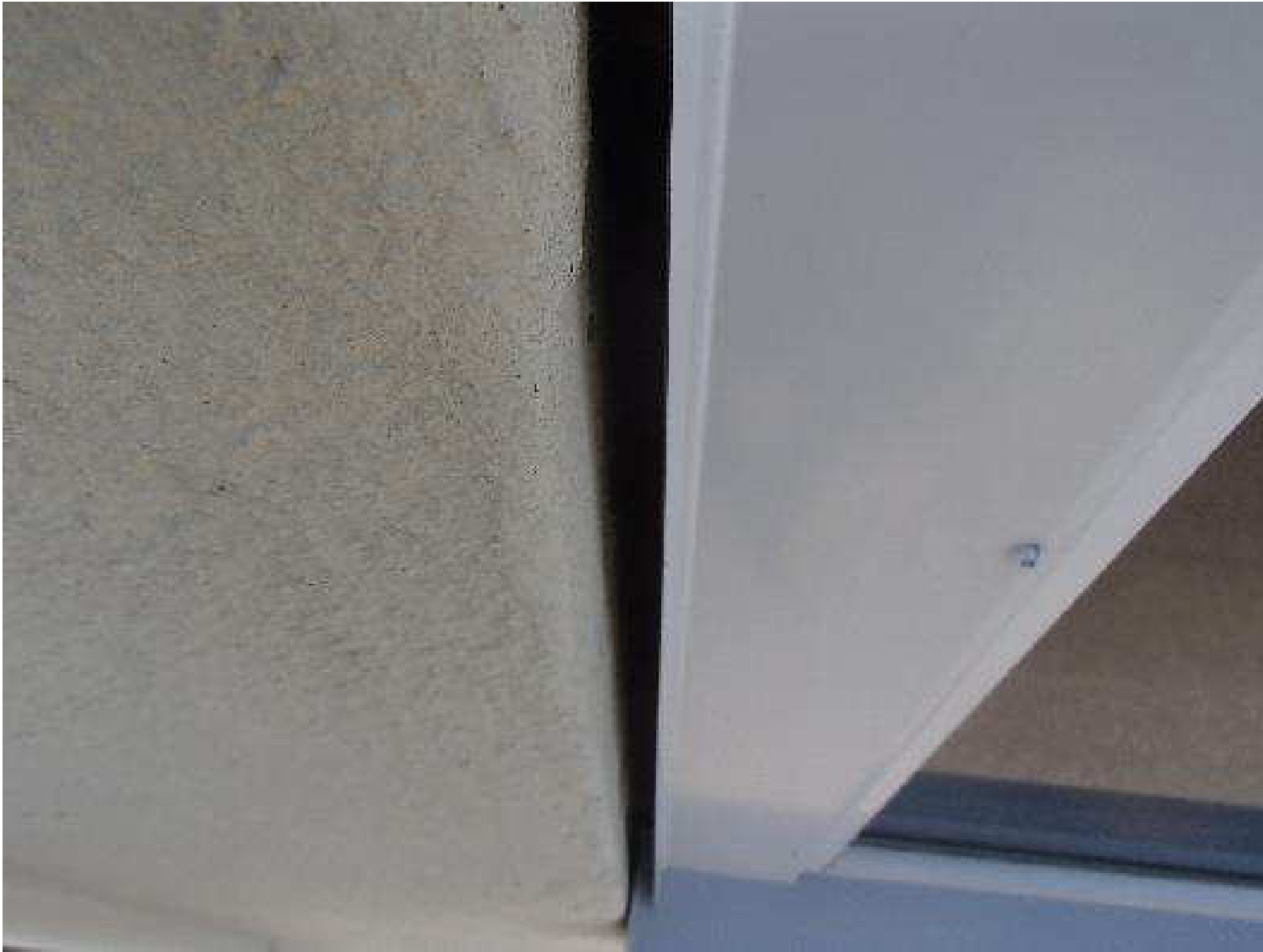
Kuva 116. Ikkunapellityksien ja julkisivujen välissä havaittiin rakoja rakenteisiin.
