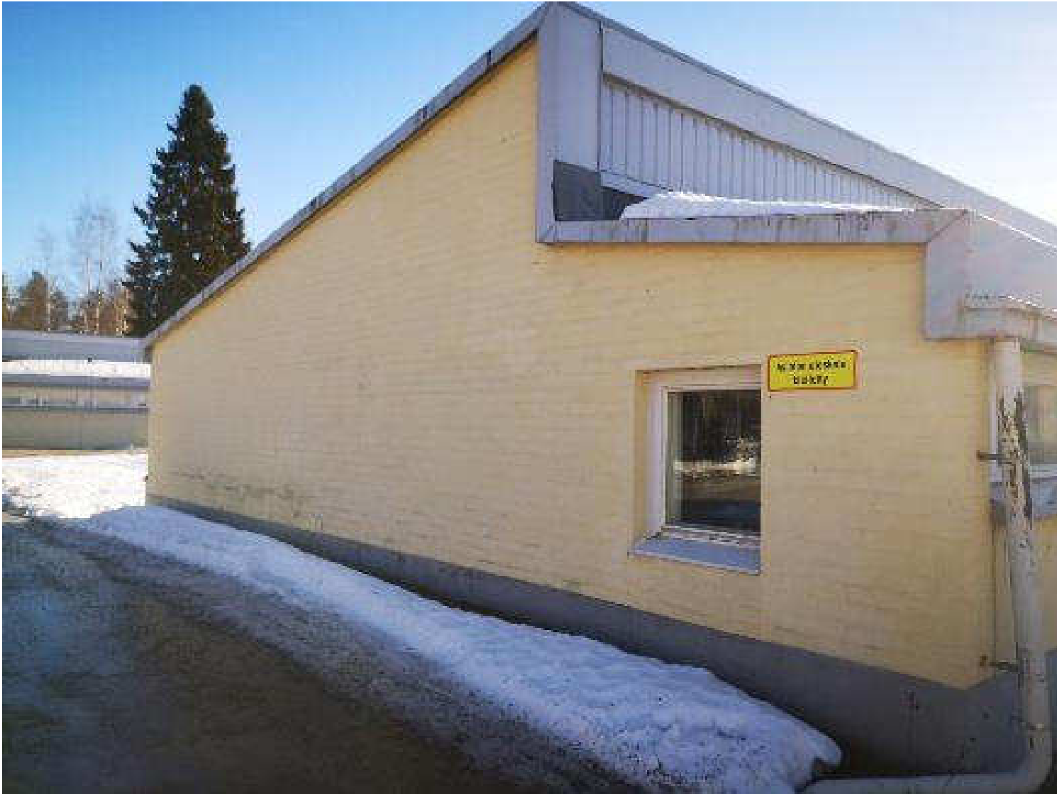
Kuva 136. Julkisivujen viereen on kulkuväylien vieressä kasattu lumikasoja, jotka nostavat julkisivujen alaosien kosteusrasitusta.
