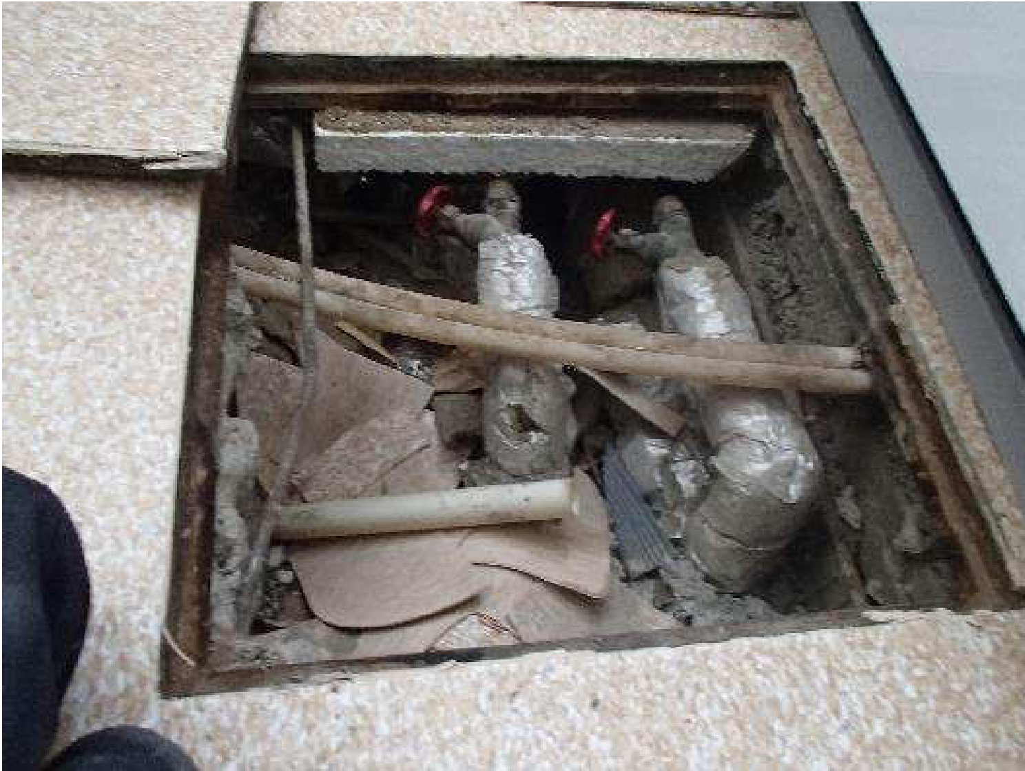
Kuva 165. Putkikanaalien tarkastusluukkujen alapuolella havaittiin vanhoja rakennusmateriaaleja.
