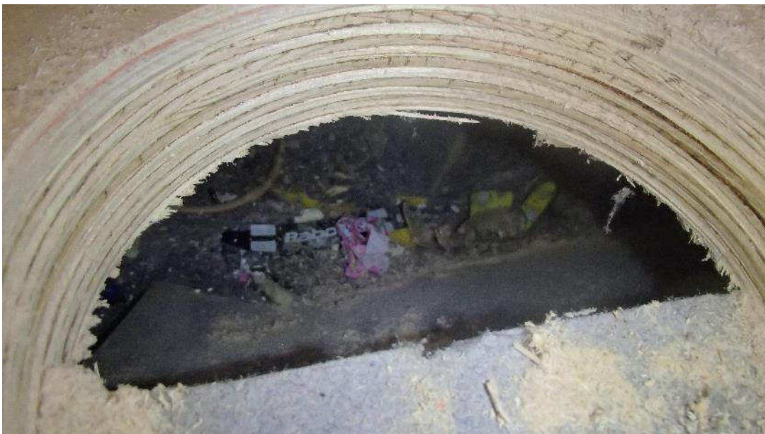
Kuva 16. Lattian pintamateriaalin alapuolella havaittiin runsaasti pölyä ja roskaa.
