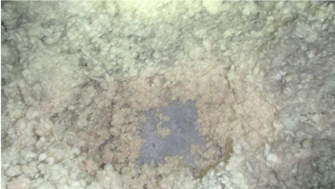
Kuva 13. Lämmöneristeenä yläpohjassa on puhallusvilla ja eristeen alapuolella ei havaittu muovikalvoa pitokoeluontoisen tarkastuksen perusteella.
