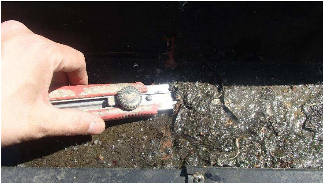
Kuva 10. Sadevesikourujen liitokset eivät ole kaikkialta tiiviitä.
