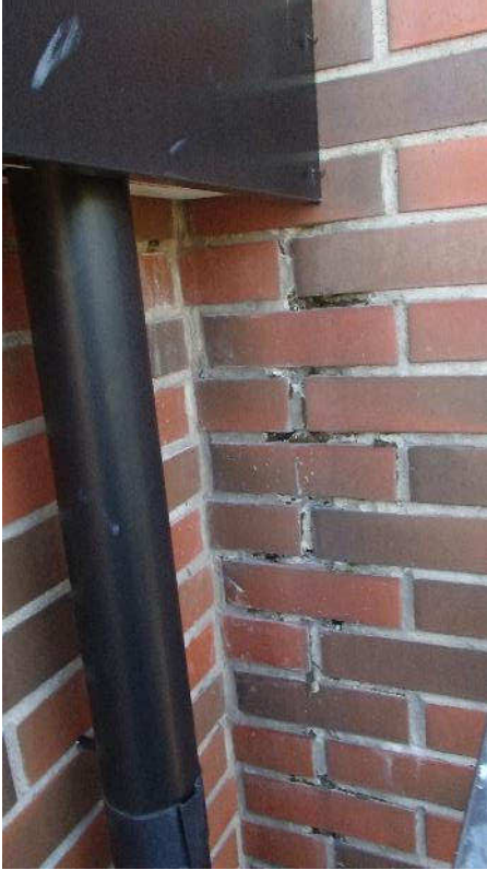
Kuva 8. Tiilimuurauksessa on viitteitä sadeveden kulkeutumisesta rakenteisiin.
