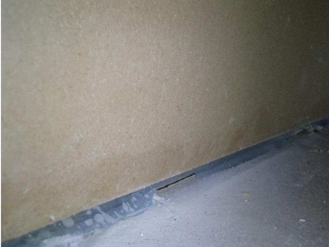
Kuva 17. Näyttämön alapuolella höyrynsulkumuovia ei ole asennettu tiivistä alapohjarakenteisiin.
