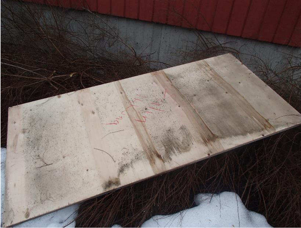
Kuva 9. Julkisivujen vanerilevyjen sisäpinnalla havaittiin mustaa kasvustoa.
