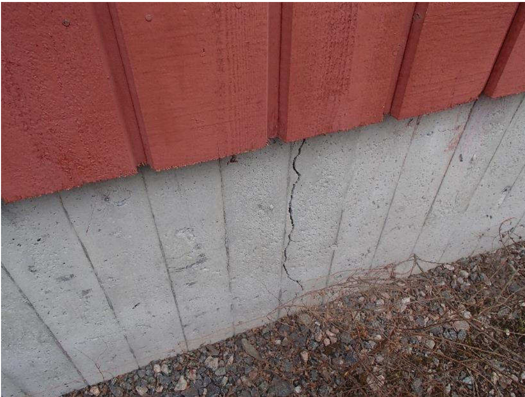
Kuva 10. Sokkelissa havaittiin paikoin halkeilua.
