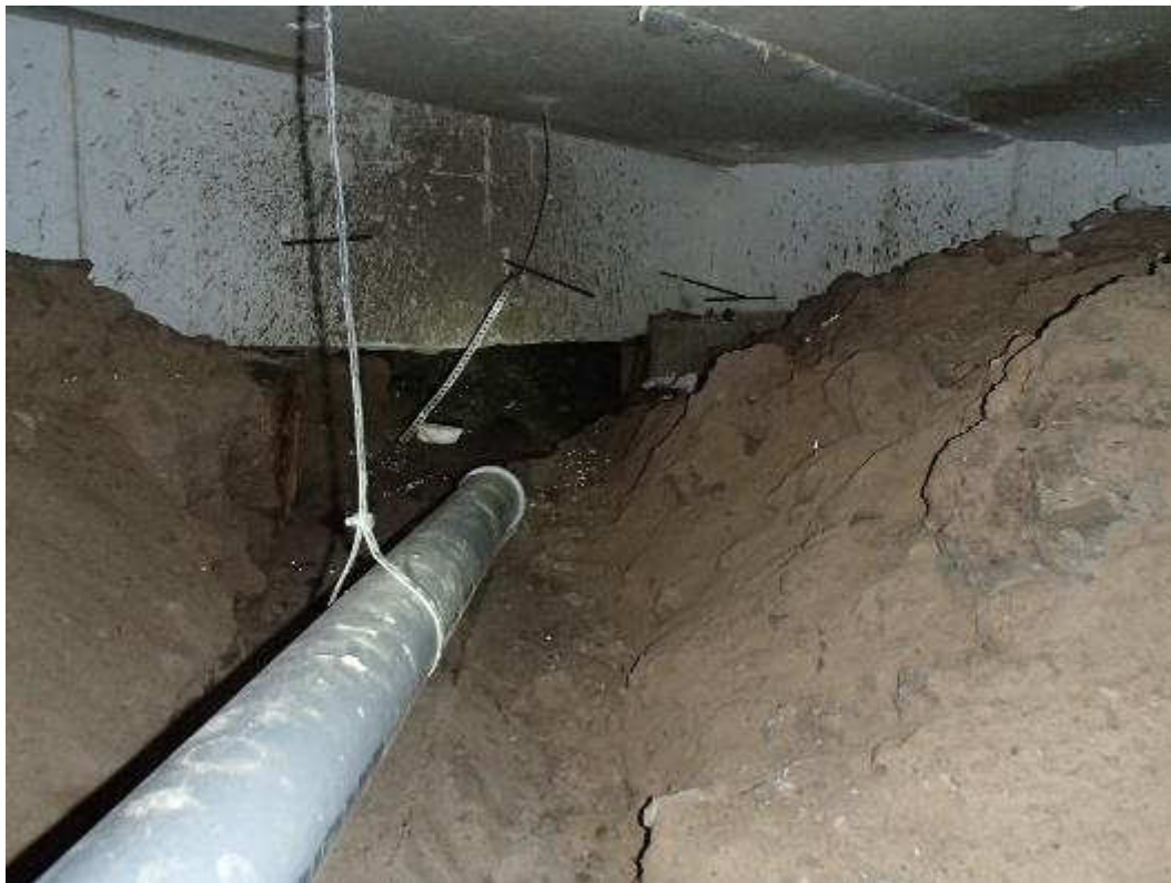
Kuva 119. Sade- ja sulamisvedet valuvat ryömintätilaan sokkelin edestä.
