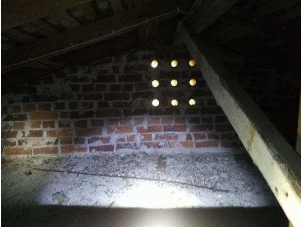
Kuva 32. Tuulettuvassa vinttitilassa on rakennusaikaista jätettä ja likaa.
