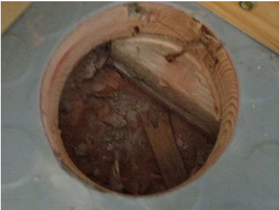
Kuva 54. Puukäsityöluokan lankkulattian alapuolella oli täyttönä paperia, puuta, rivettä ja kaikkea muuta rakennusaikaista roskaa.
