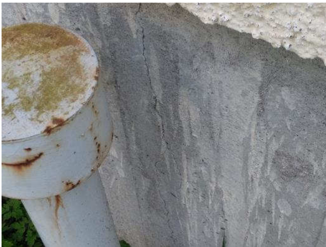
Kuva 89. Sokkelissa havaittiin pystysuuntaista halkeilua.
