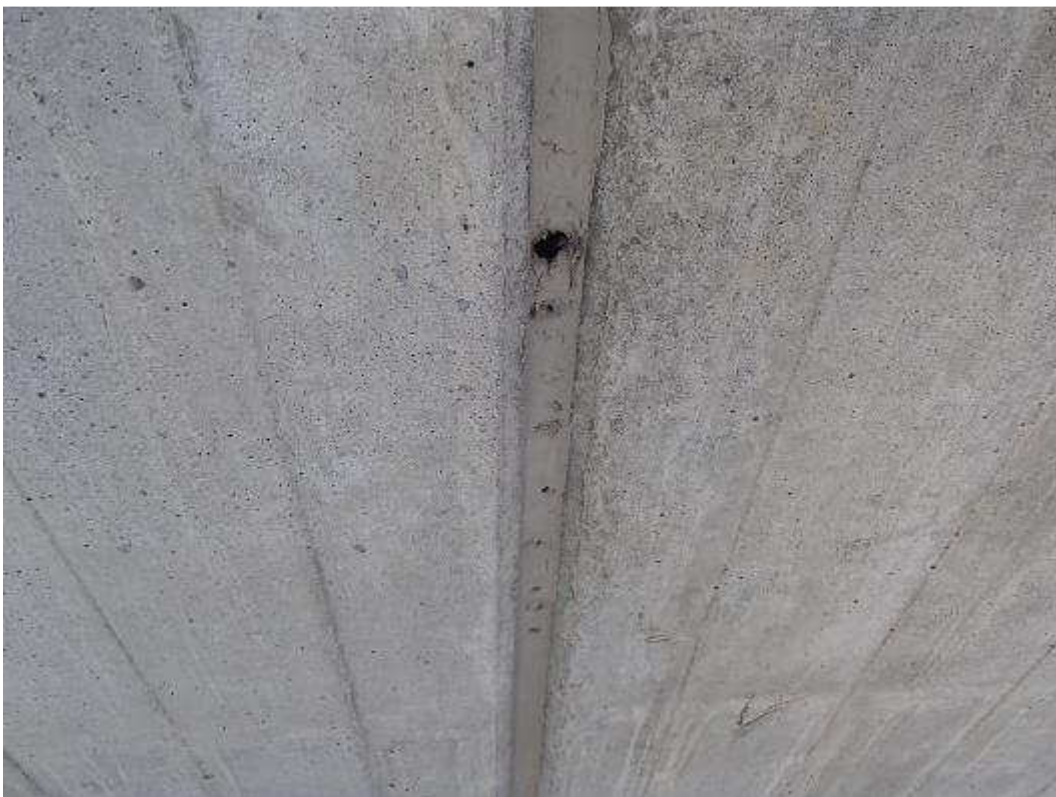
Kuva 125. Sokkelielementtien väliset elastiset saumamassat ovat vaurioituneet ulkopuolisten tekijöiden seurauksena.
