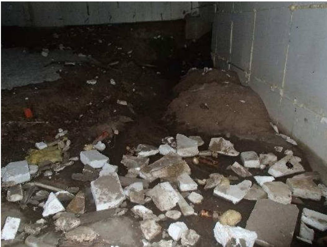
Kuva 116. Ryömintätilassa havaittiin paikoin runsaasti rakennusaikaista jätettä ja sade- ja sulamisvedet valuvat ryömintätilaan sokkelin edestä.
