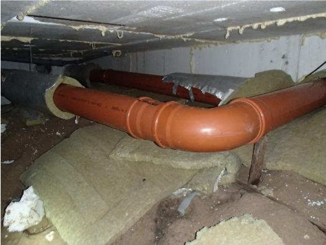
Kuva 121. Viemäriputkistojen lämmöneristeet ovat irtoilleet.
