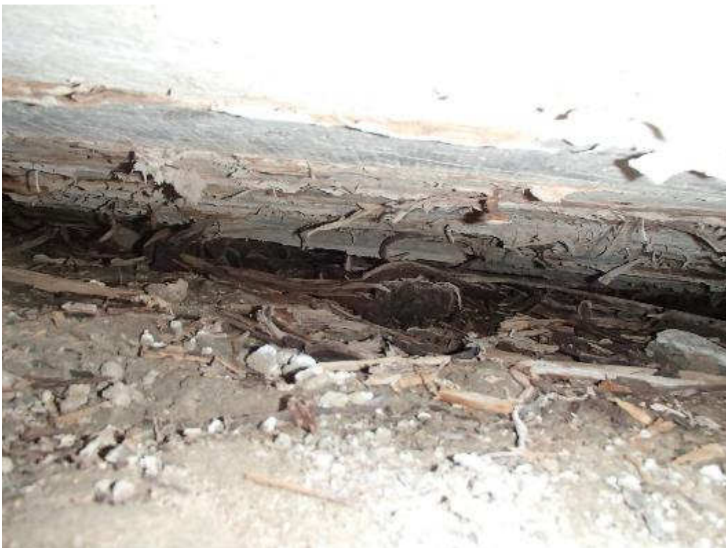
Kuva 69. Opettajienhuoneen alapuoleisessa ryömintätilassa on vielä vanhat muottilaudoitukset savikerrosten ja ylälaattapalkiston välissä.
