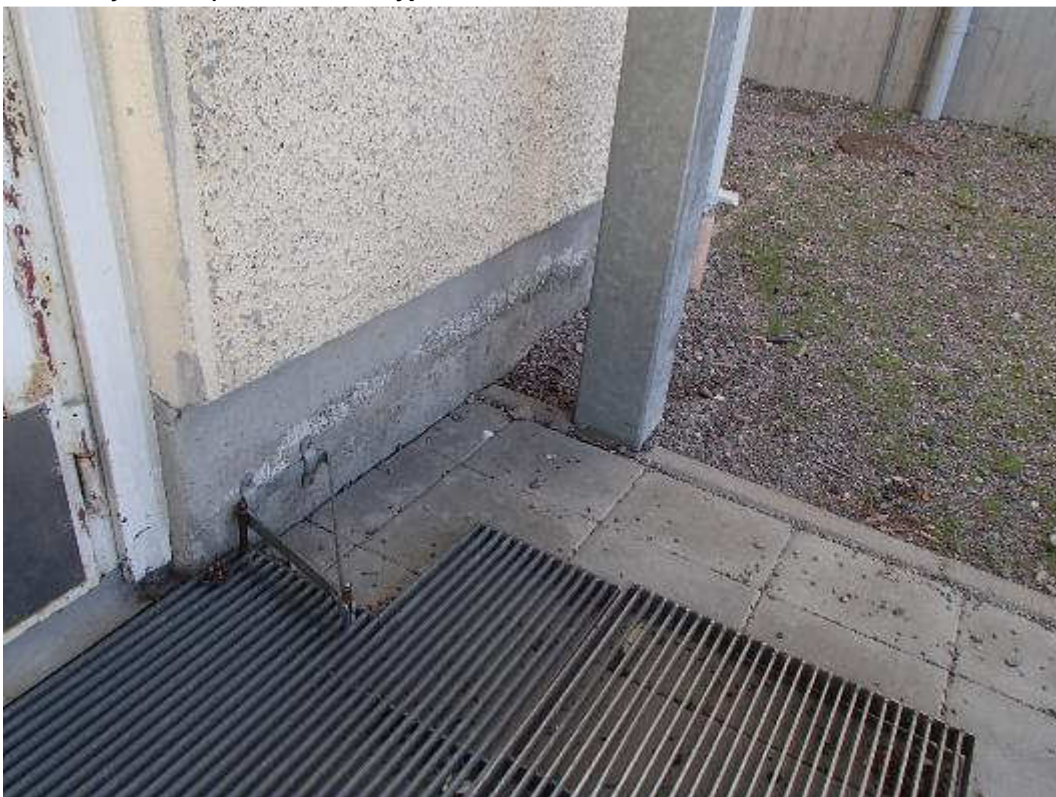
Kuva 91. Sokkelipinnoissa havaittiin kalkkihärmekertymiä.
