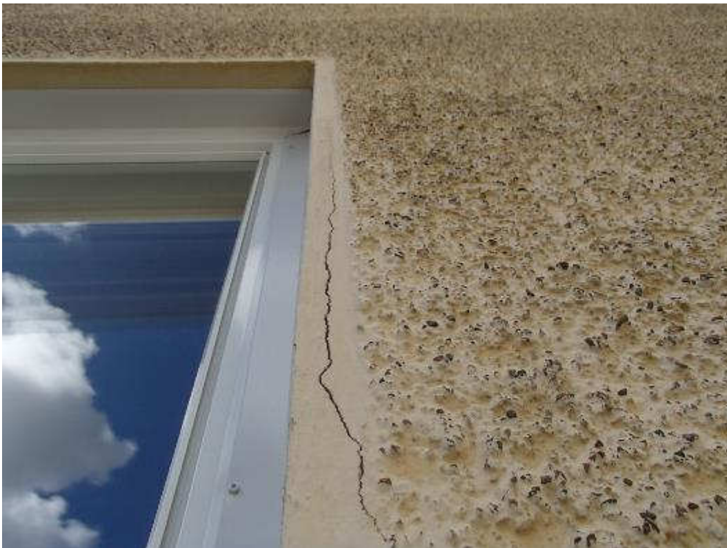
Kuva 7. Rakennuksen rappauspinnoissa havaittiin paikoin halkeilua.
