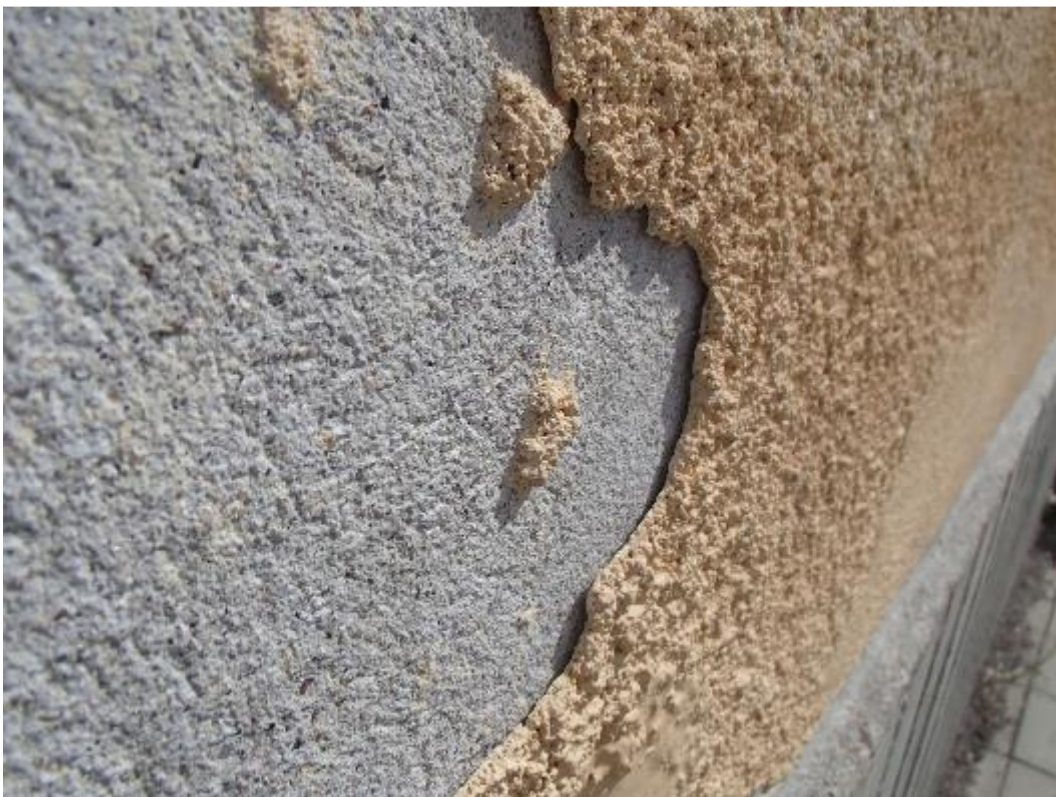
Kuva 129. Julkisivupintojen pintarappaus on paikoin irronnut alustastaan.
