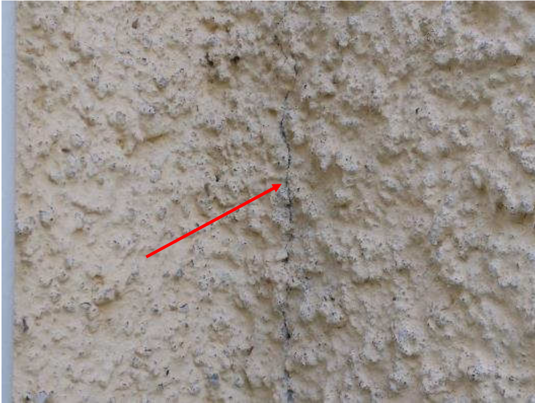
Kuva 80. Julkisivupinnoilla havaittiin paikoin halkeilua.
