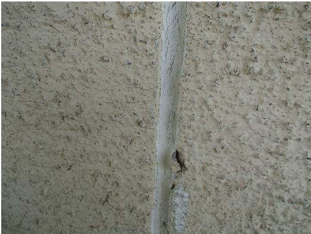
Kuva 88. Julkisivujen elastiset saumamassat ovat ikääntyneet.
