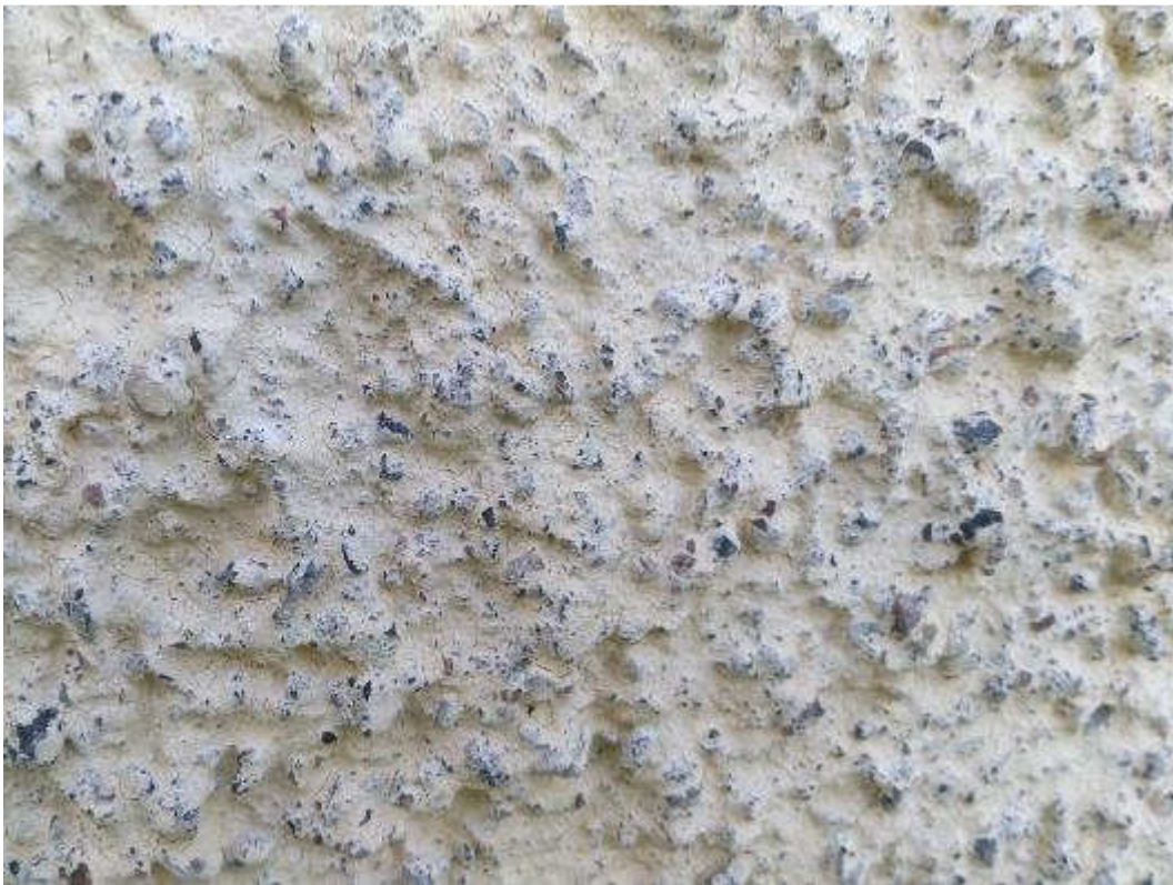
Kuva 81. Paikoin julkisivujen maalipinnat ovat kuluneet.
