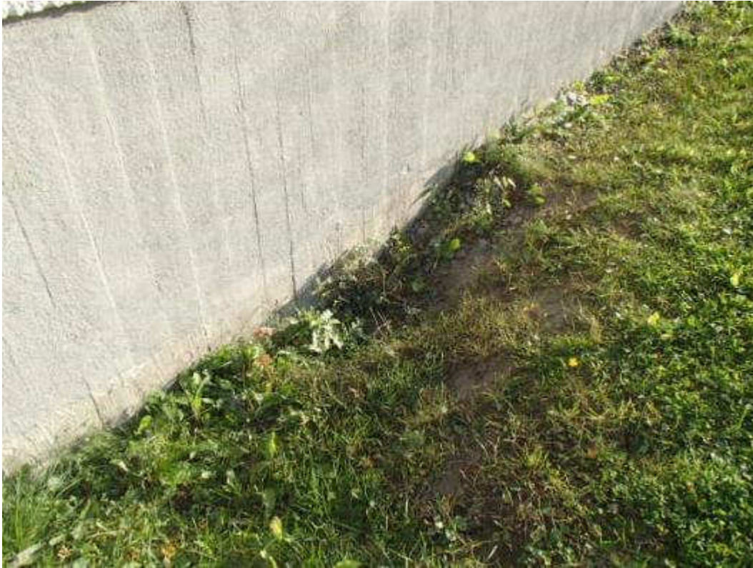
Kuva 94. Paikoin sokkelin edessä on sadeveden eroosiosta aiheutuneita kuoppia.
