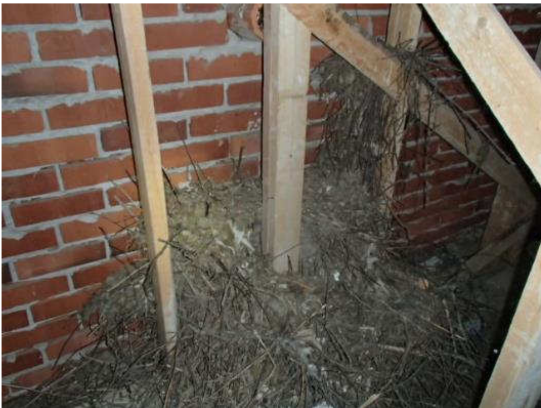
Kuva 102. Tuulettuvassa vintttilassa havaittiin massiivisia linnunpesiä.
