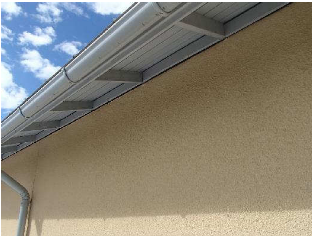
Kuva 134. Julkisivujen ja yläpohjan rajapinnalla ei havaittu myrskypellitystä.
