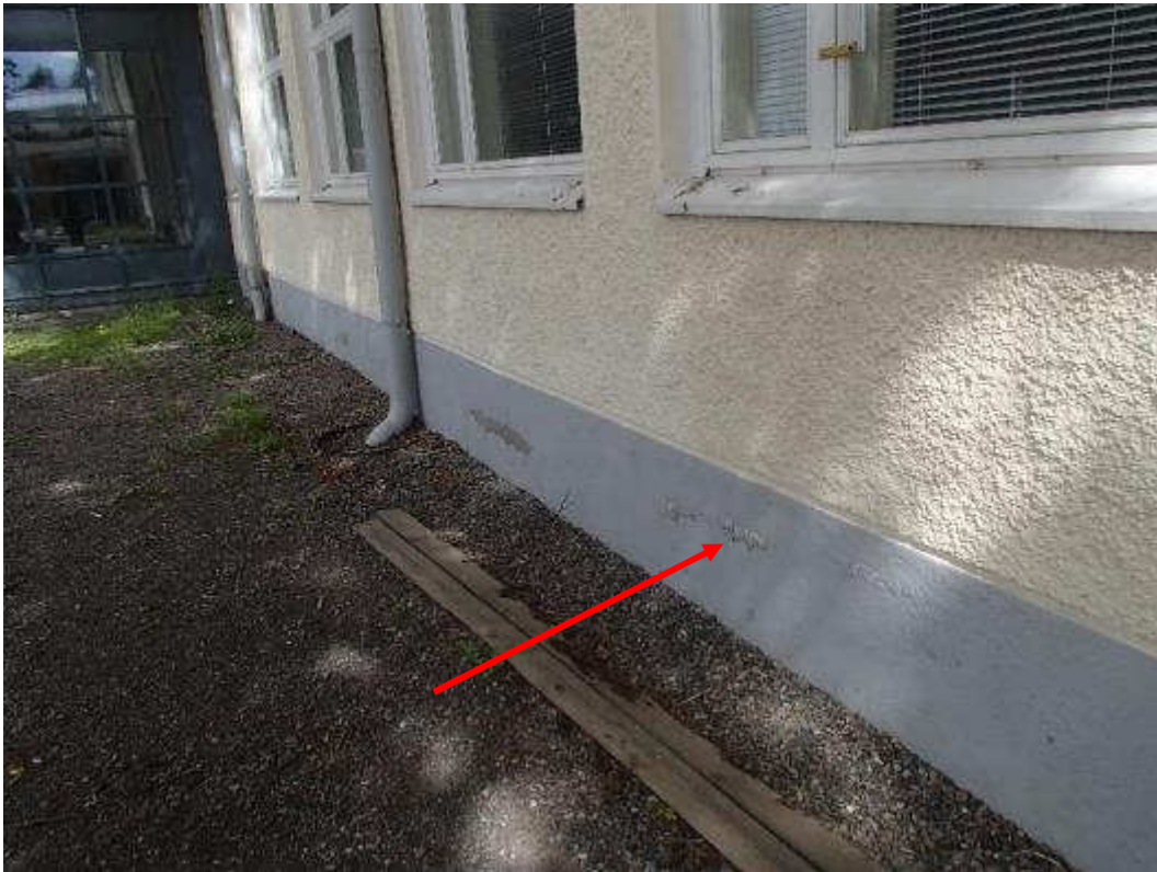
Kuva 17. Sokkelissa on havaittavissa kalkkihärmekertymiä.
