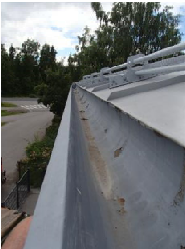
Kuva 27. Sadevesikouruissa havaittiin paikallista korroosiota.
