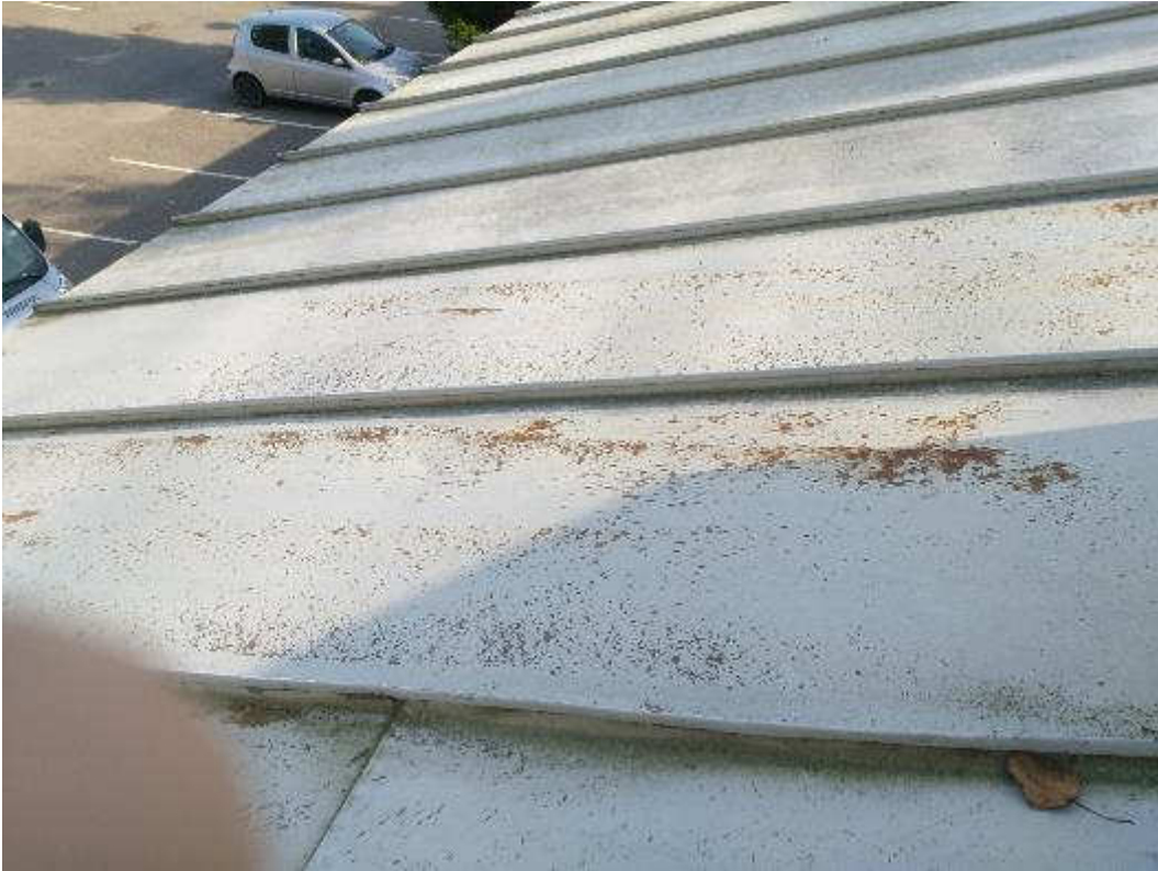
Kuva 26. Vesikatteessa havaittiin paikallista korroosiota.
