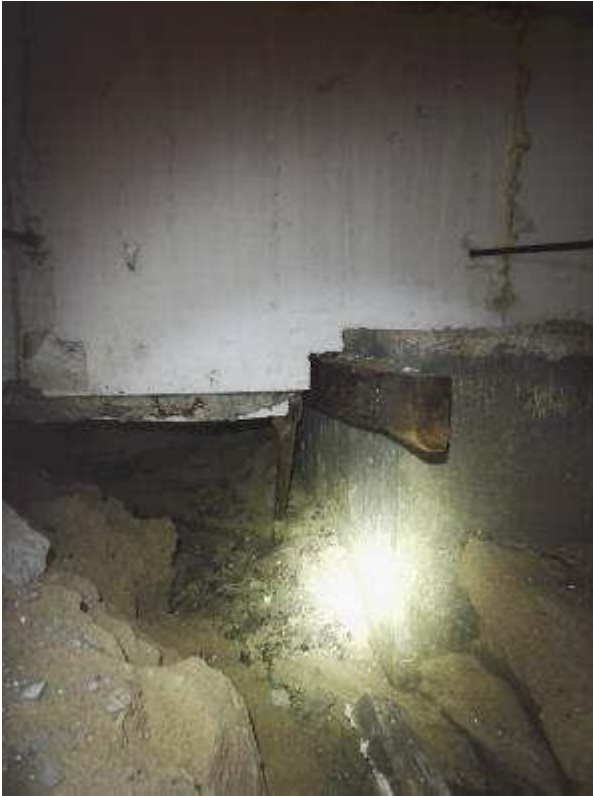
Kuva 113. Ryömintätilassa havaittiin rakennusaikaisia lahonneita puumateriaaleja.
