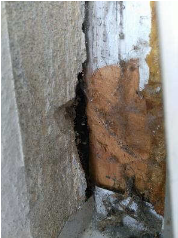
Kuva 13. Ikkunaremontin yhteydessä vanhat karmit on jätetty rakenteisiin.
