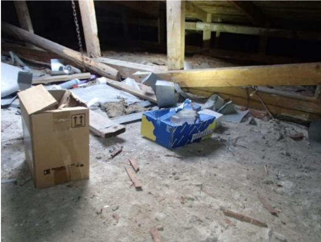
Kuva 30. Tuulettuvassa vinttitilassa on ylimääräistä rakennusaikaista jätettä ja likaa.
