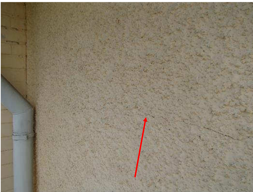
Kuva 8. Rakennuksen rappauspinnoissa havaittiin paikoin halkeilua.
