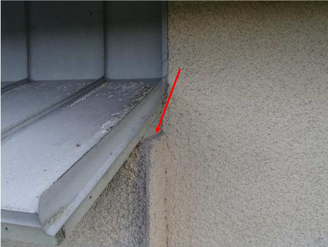
Kuva 86. Paikoin julkisivujen pellitykset ovat riittämättömät.
