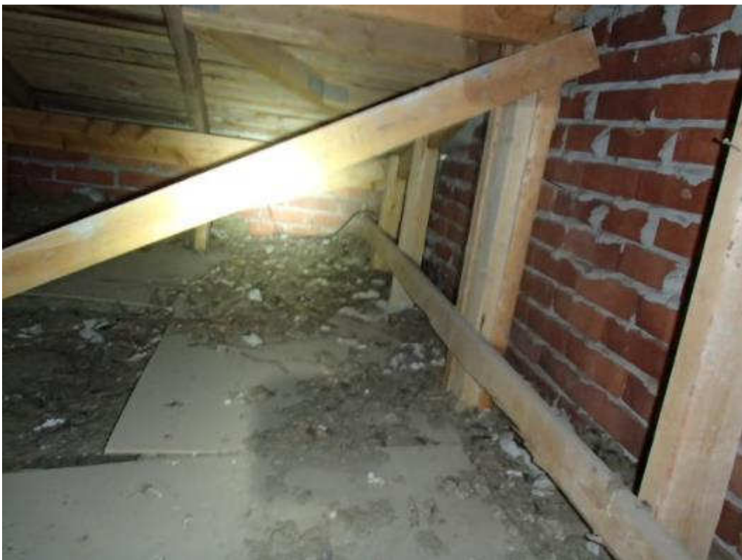
Kuva 104. Tuulettuvassa vinttillassa havaittiin paikoin runsaasti orgaanista jätettä.
