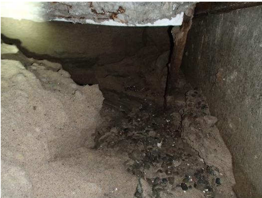
Kuva 118. Sade- ja sulamisvedet valuvat ryömintätilaan sokkelin edestä.
