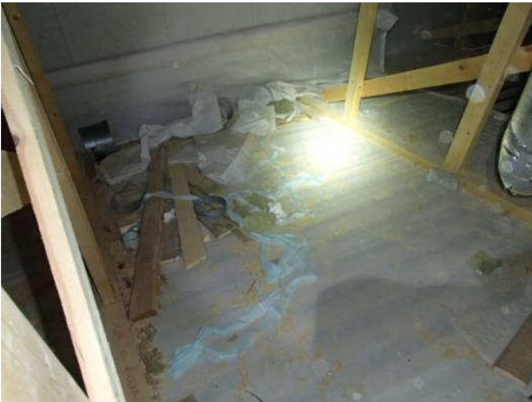
Kuva 106. Tuulettuvassa vintttilassa havaittiin rakennusaikaista roskaa.
