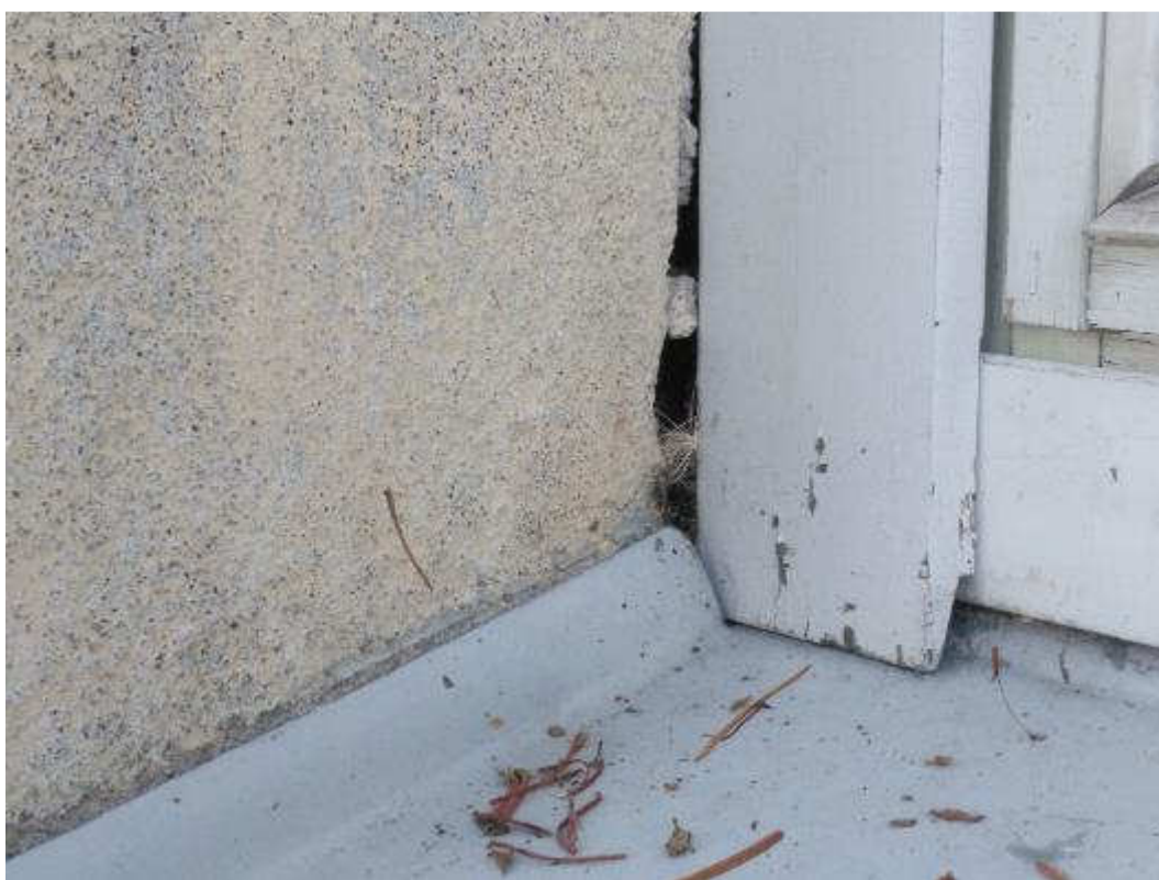
Kuva 83. Ikkunoiden ja pielirakenteiden rajapinnoilla havaittiin rakoja rakenteisiin.
