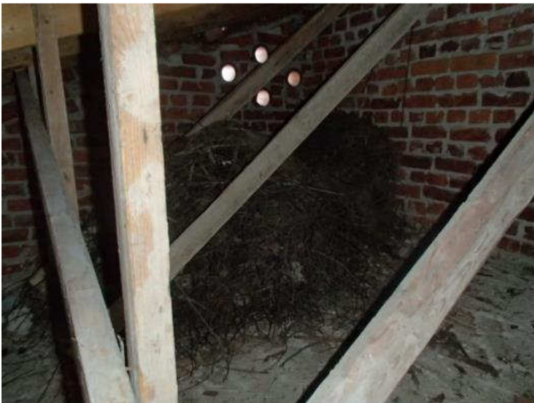
Kuva 31. Tuulettuvassa vinttitilassa on massiivinen linnunpesä.
