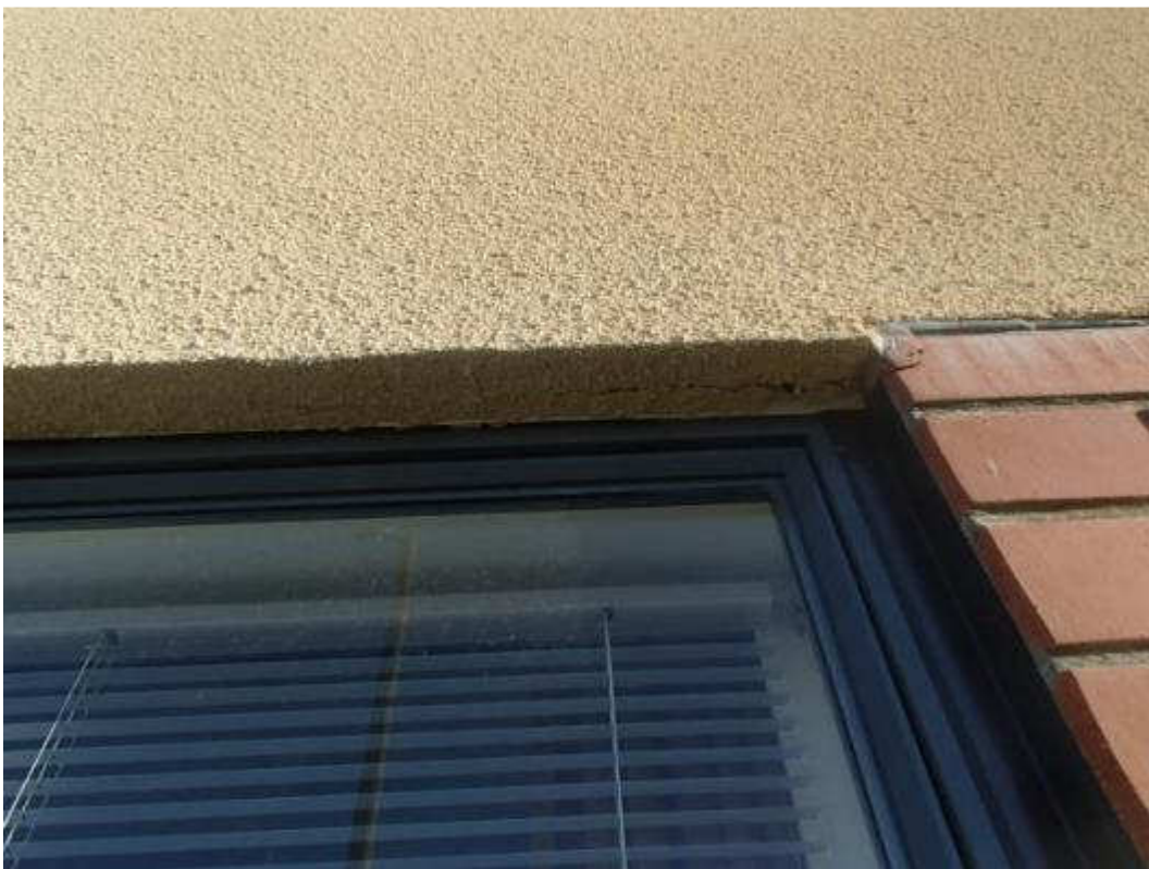
Kuva 131. Ikkunoiden pielissä havaittiin halkeilua.
