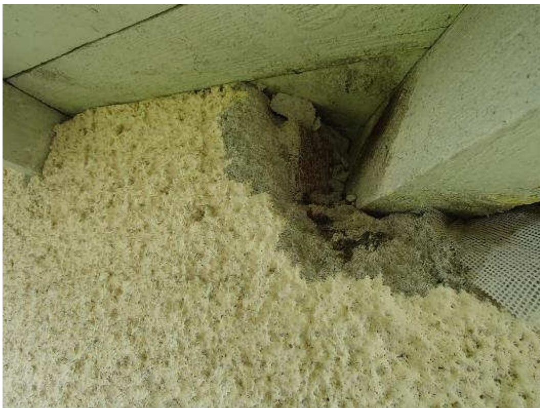
Kuva 78. Julkisivuista on paikoin irronnut palasia.
