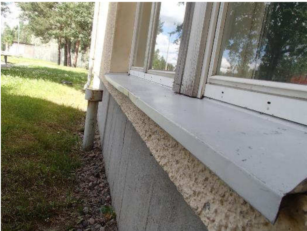
Kuva 93. Rakennuksen ympärillä olevat maapinnat kaatavat rakennusta kohden.
