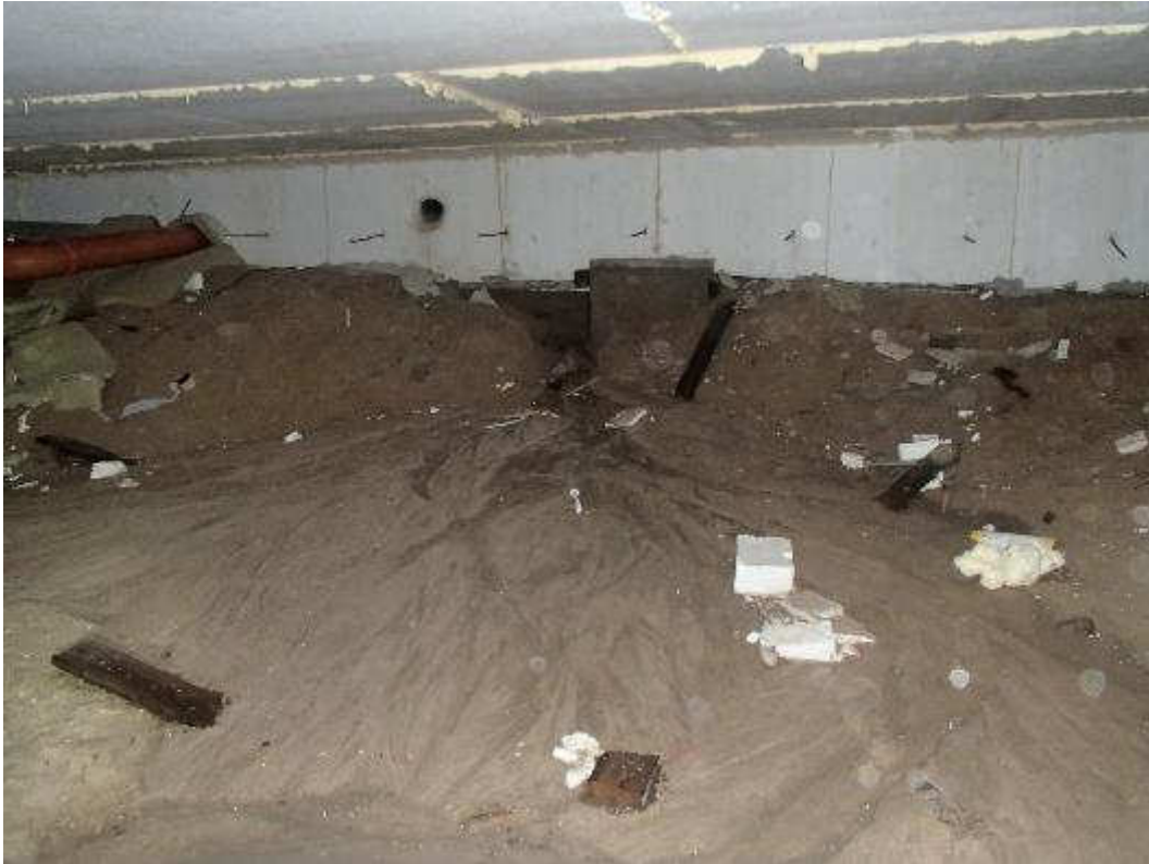
Kuva 117. Sade- ja sulamisvedet valuvat ryömintätilaan sokkelin edestä.
