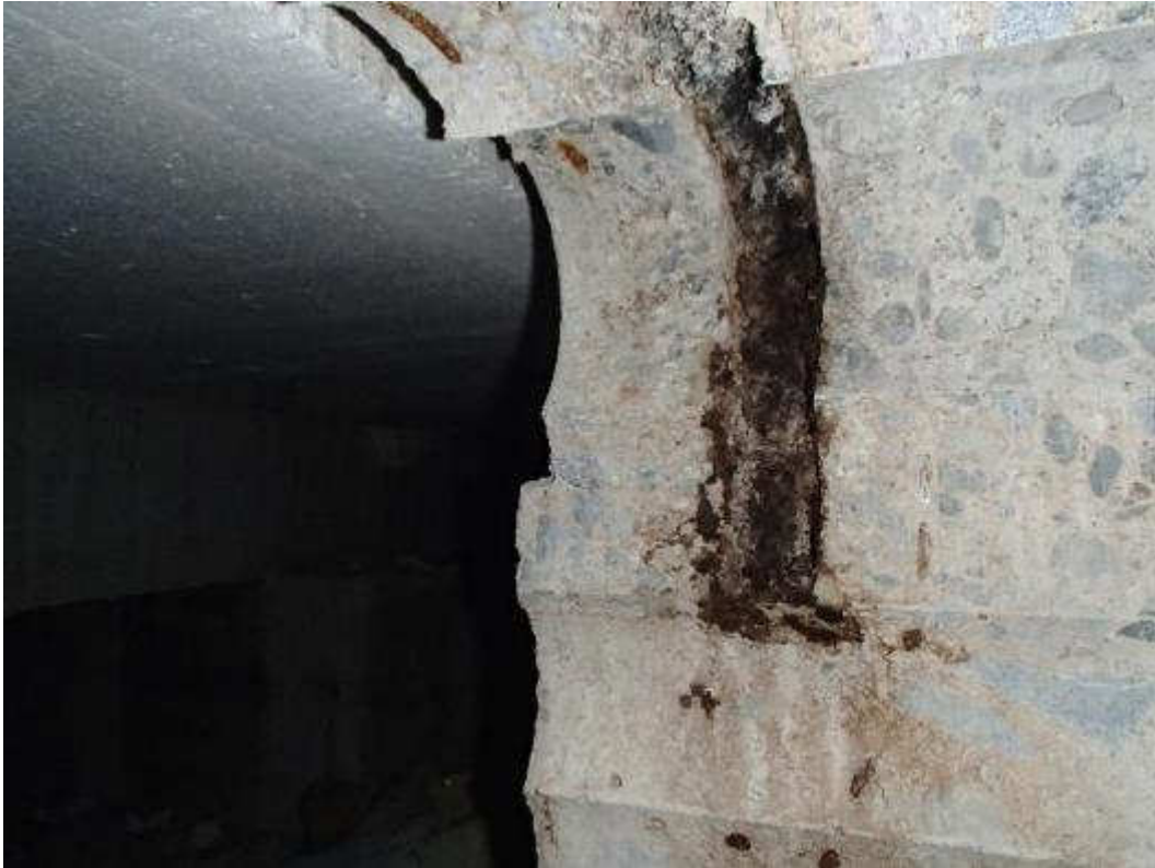
Kuva 19. Rakennuksen sokkelihalkaisussa havaittiin vaurioituneet korkkieristeet.
