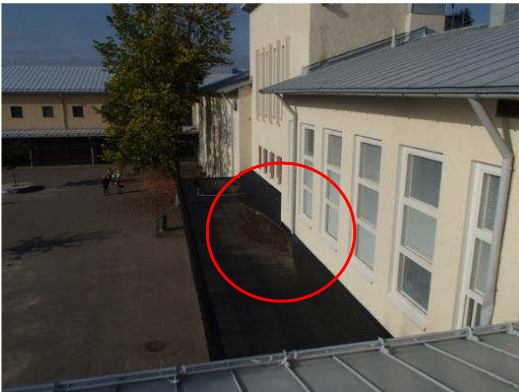
Kuva 37. Sadevesi lammikoituu sisäpihan katoksen päälle.
