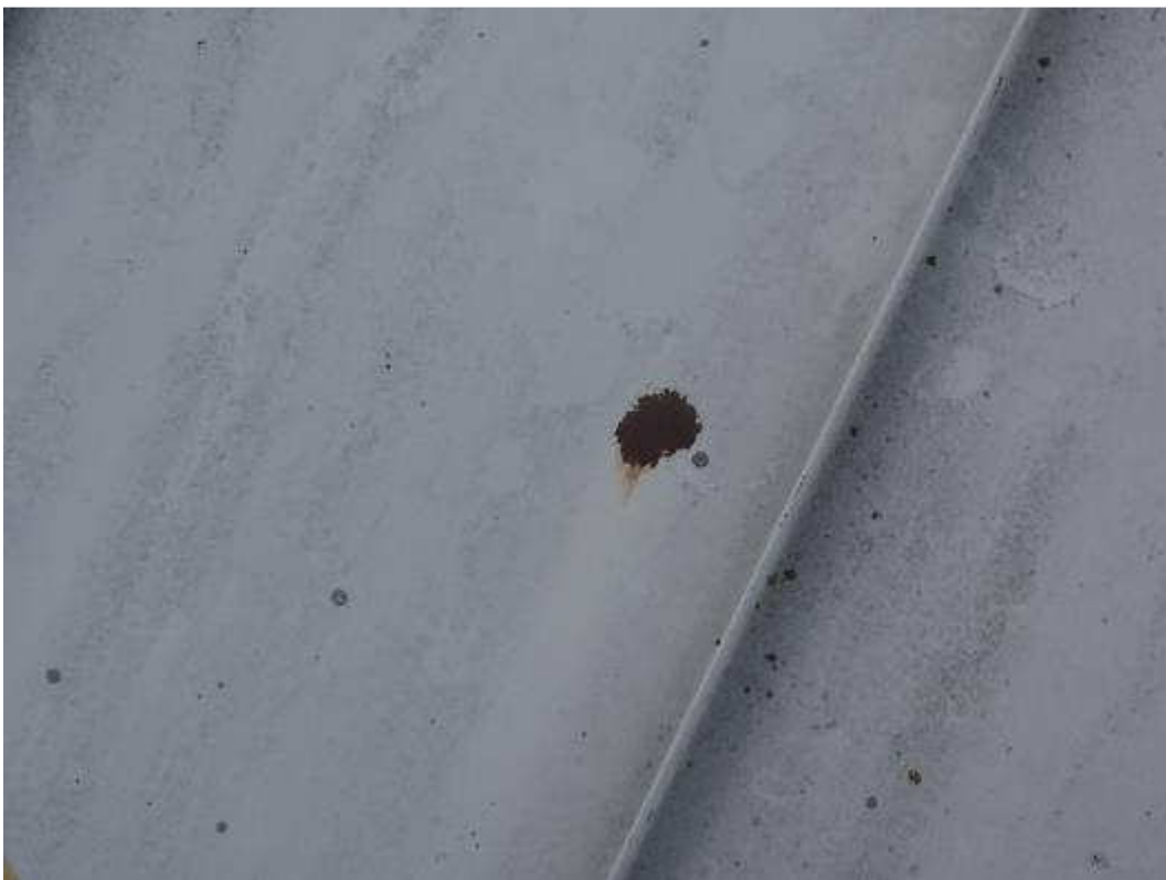
Kuva 100. Vesikatteessa havaittiin lievää paikallista korroosiota.
