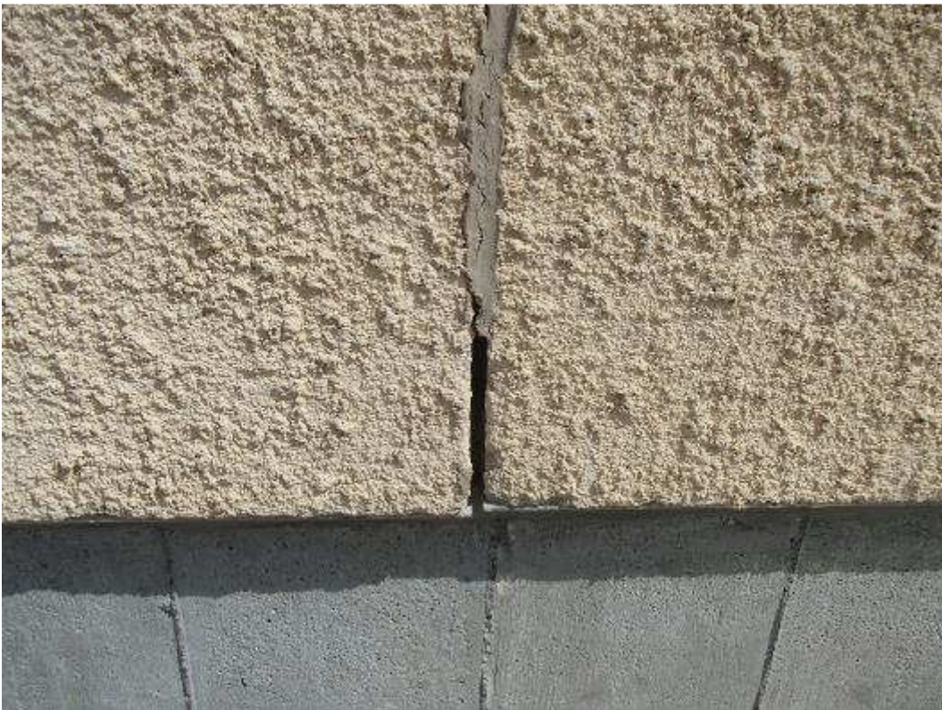
Kuva 127. Julkisivujen elastiset saumamassat ovat ikääntyneet.
