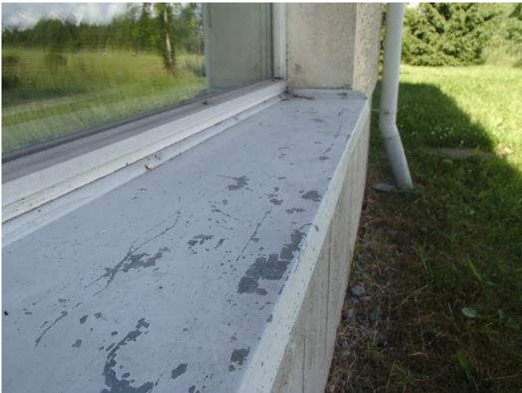
Kuva 85. Ikkunoiden vesipellit kaatavat kohden rakennusta.
