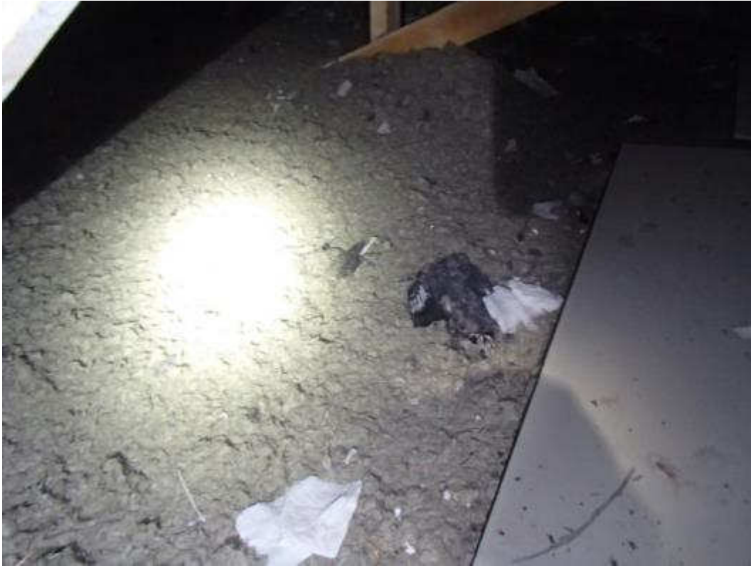
Kuva 103. Tuulettuvassa vinttillassa havaittiin linnun raatoja.
