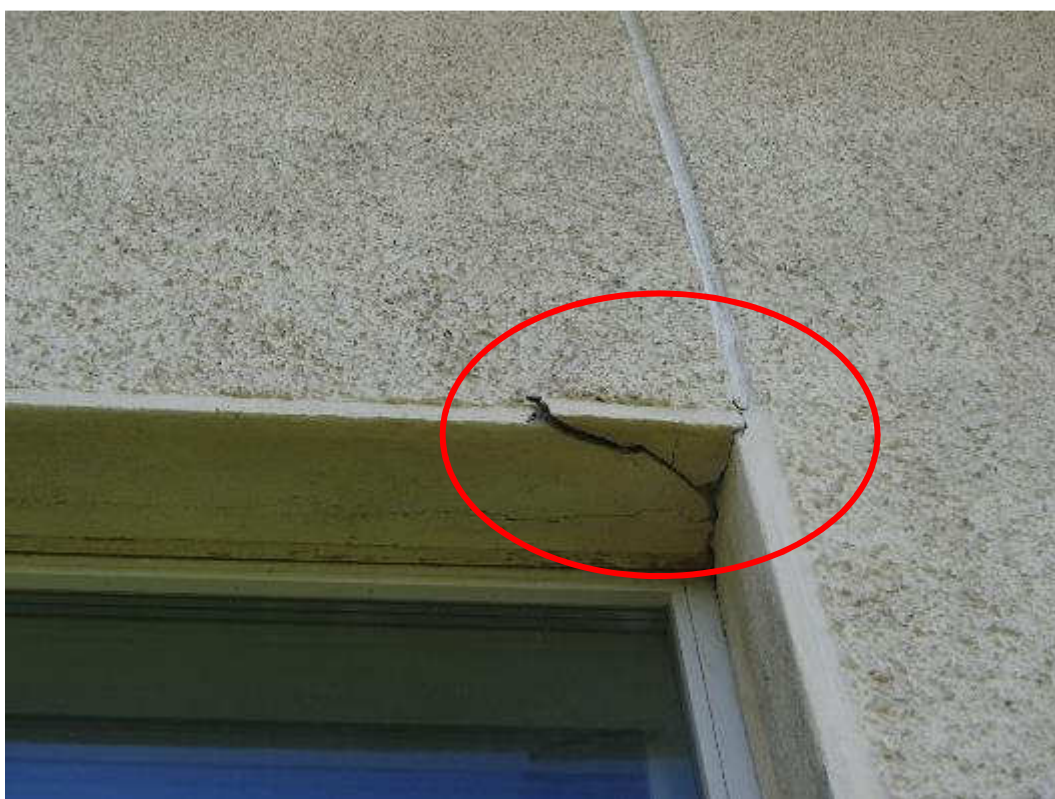
Kuva 79. Paikoin julkisivuista on irtoamassa palasia.
