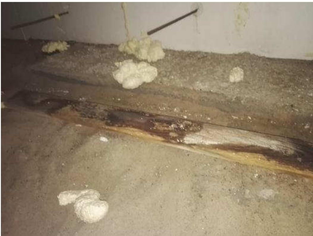
Kuva 112. Ryömintätilassa havaittiin rakennusaikaisia lahonneita puumateriaaleja.
