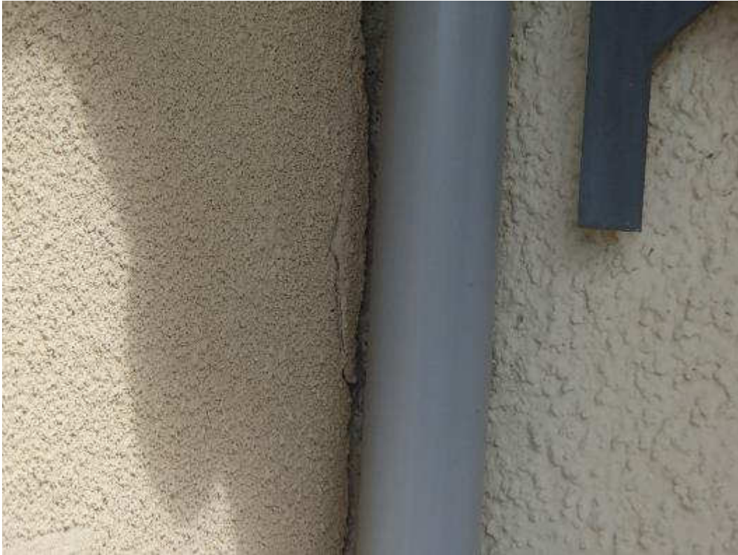
Kuva 128. Julkisivujen ohutrappaukset on paikoin irronnut tai irtoamassa palasia.
