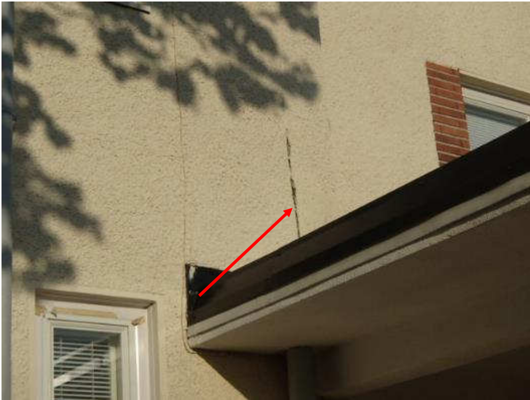
Kuva 15. Julkisivuilla havaittiin avoimia liikuntasauvoja.
