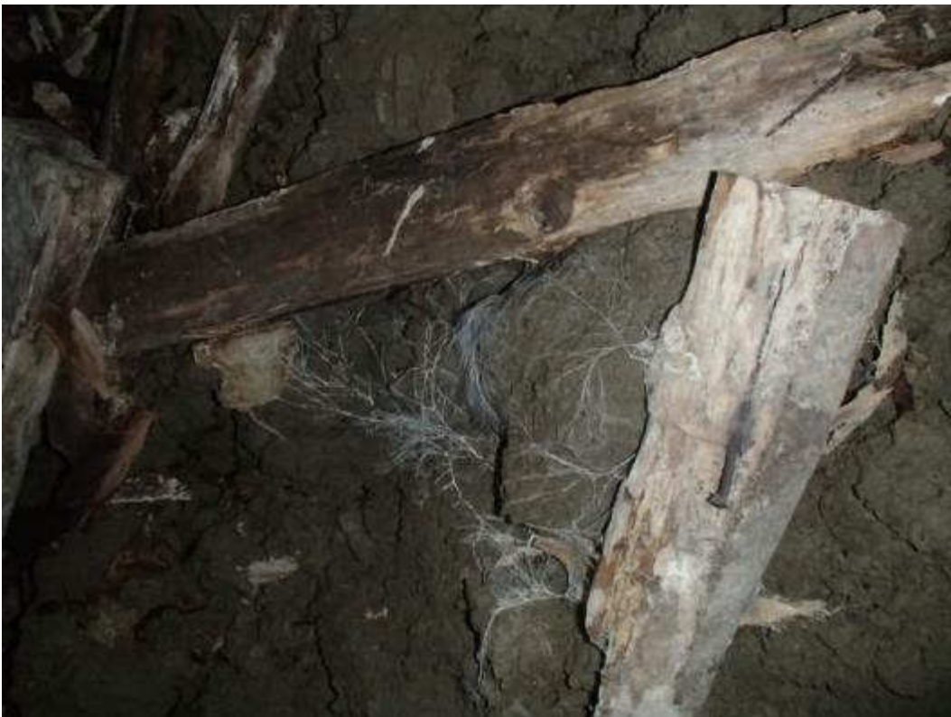
Kuva 71. Esikoulun alapuoleisessa ryömintätilassa on kaikki rakennusaikaiset muottilaudoitukset lahonneet sekä laudoissa kasvaa sienirihmasto.
