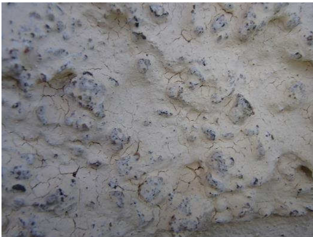
Kuva 82. Julkisivujen maalipinnoissa havaittiin mikrohalkeilua.
