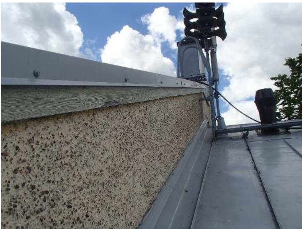
Kuva 29. Paikoin otsalautoitusten maalipinnat ovat ikääntyneet.
