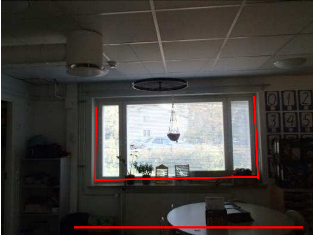
Kuva 137. Vuonna 1958 rakennetun koulurakennuksen tyypillisimmät epätiiveyskohdat.
