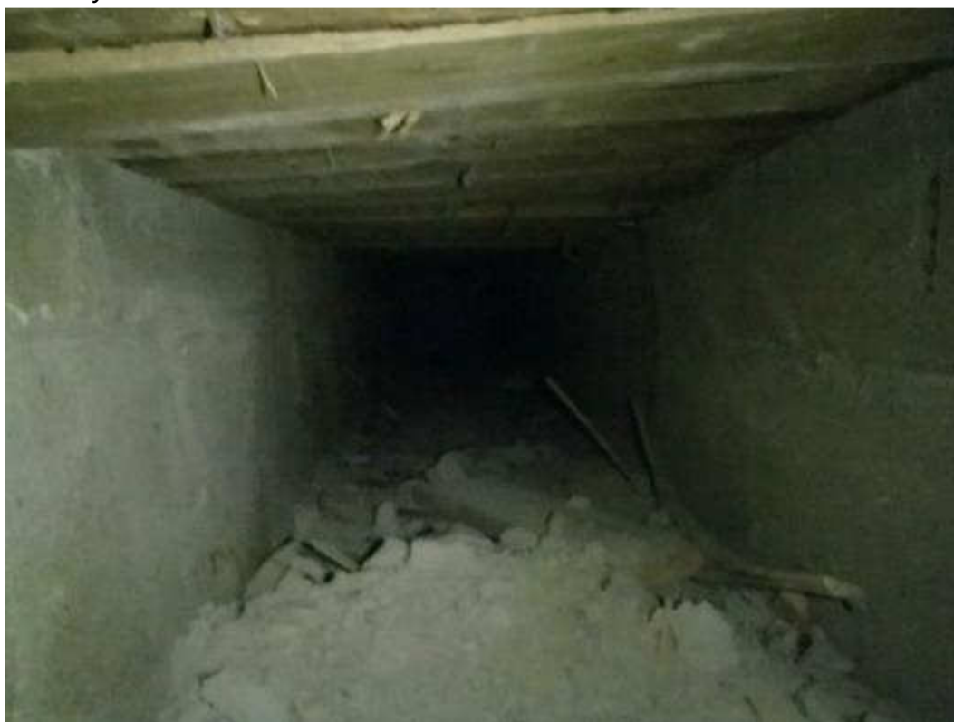
Kuva 35. Luokahuoneiden yläpuoleisessa yläpohjassa kulkee rakenteellisia IV-kanavistoja, joissa on roskaa, likaa ja muottilauoituksia.
