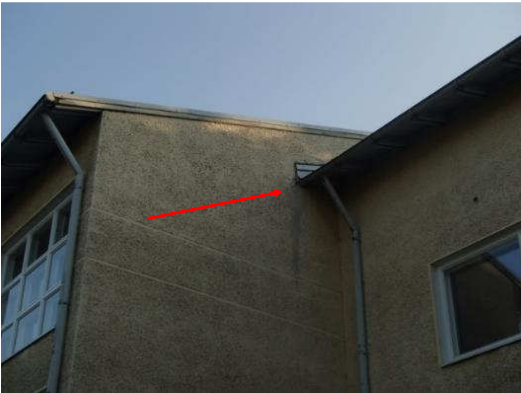
Kuva 10. Sadevesi on paikoin kuluttanut julkisivupintoja.
