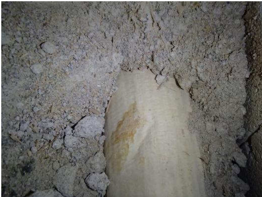
Kuva 65. Alapohjan putkikanaalien täytteenä oli hiekkaa, betonimursketta ja puun palasia.
