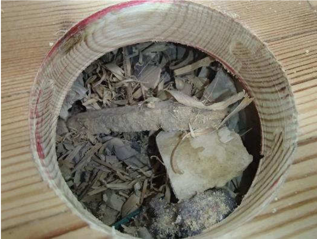
Kuva 53. Vanhan liikuntasalin lankkulattian alapuolella oli täyttönä paperia, puuta, rivettä ja kaikkea muuta rakennusaikaista roskaa.
