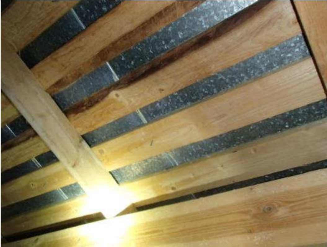
Kuva 105. Vesikatteen alapuolella ei ole aluskatetta.
