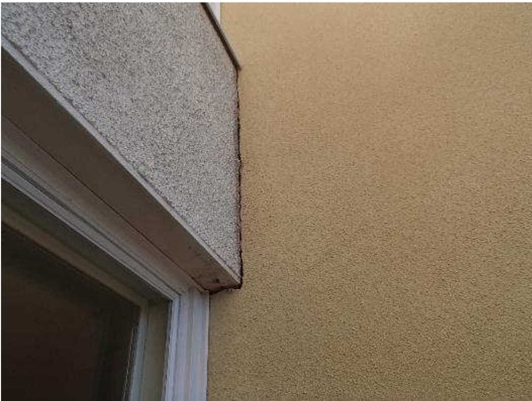
Kuva 87. Rakennuksien rajapinnoilla on avoimia rakoja rakenteisiin.
