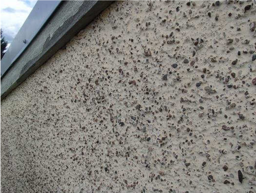
Kuva 9. Rakennuksen voimakkaan säärasituksen alueilla on maali- ja rappauspinnat kuluneet.
