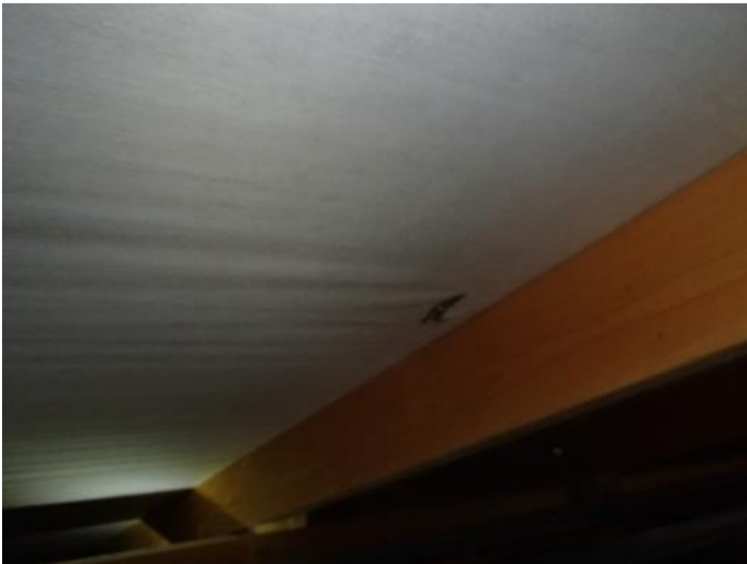
Kuva 133. Vesikatteen alapuoleisessa aluskatteessa havaittiin paikoin reikiä.
