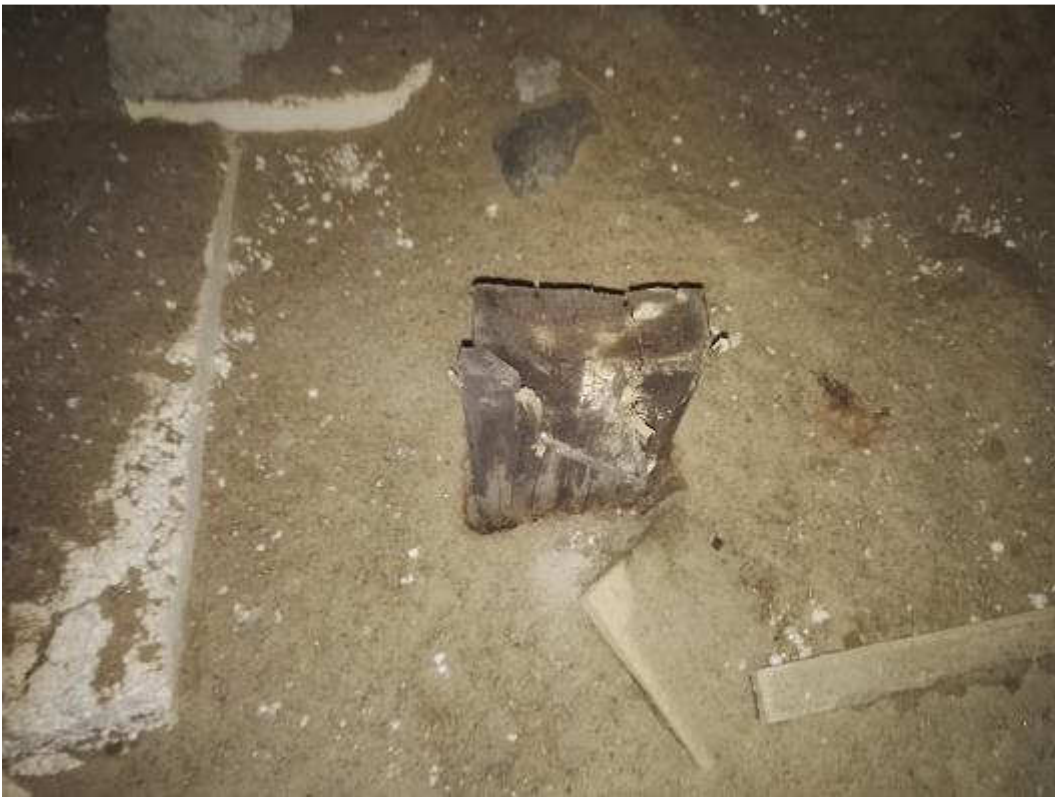
Kuva 114. Ryömintätilassa havaittiin rakennusaikaisia lahonneita puumateriaaleja.
