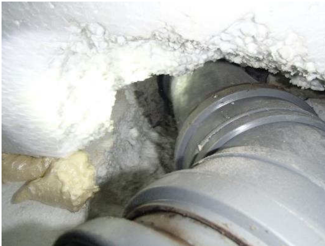
Kuva 123. Alapohjan läpiviennit eivät ole tiiviitä.
