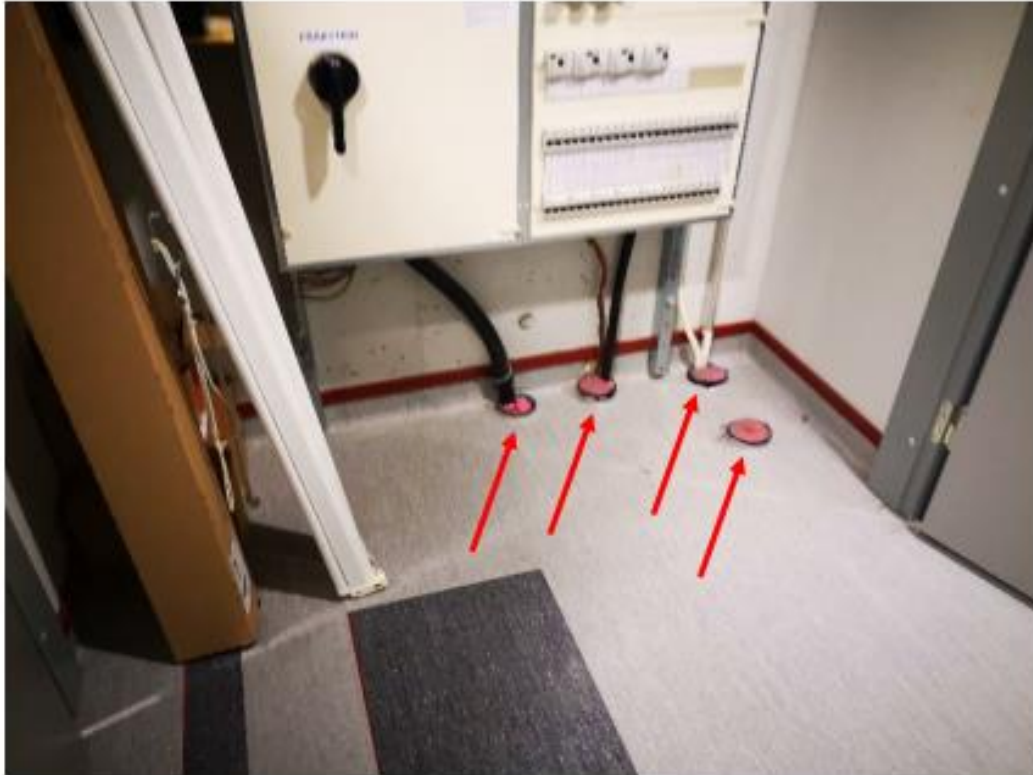
Kuva 18. Ilmavuotoja havaittiin alapohjan läpivientien kautta.
