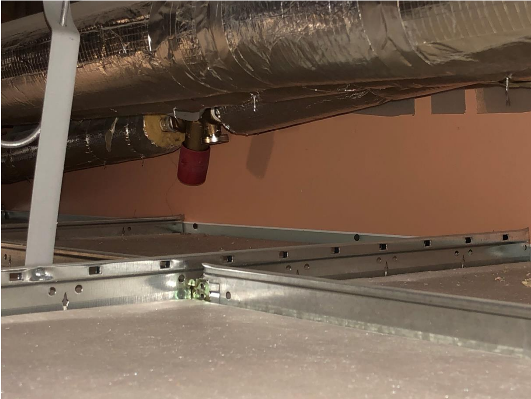
Kuva 22. Alakattolevyjen yläpuolella liikuntasalin kohdalla ei havaittu vesijälkiä ja tulppaukset todettiin pitäviksi.
