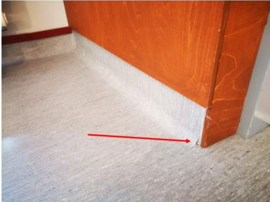
Kuva 14. Ilmavuotoja havaittiin avautuneiden mattosaumojen kautta.
