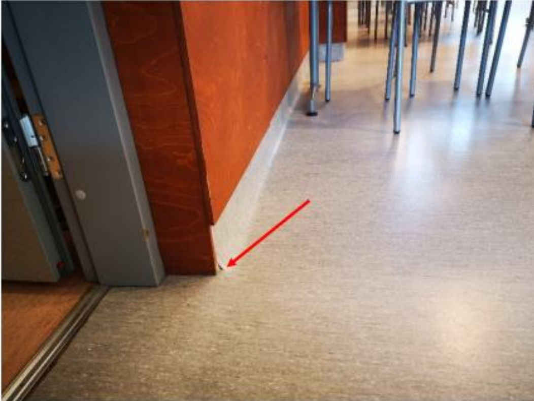
Kuva 16. Ilmavuotoja havaittiin avautuneiden mattosaumojen kautta.
