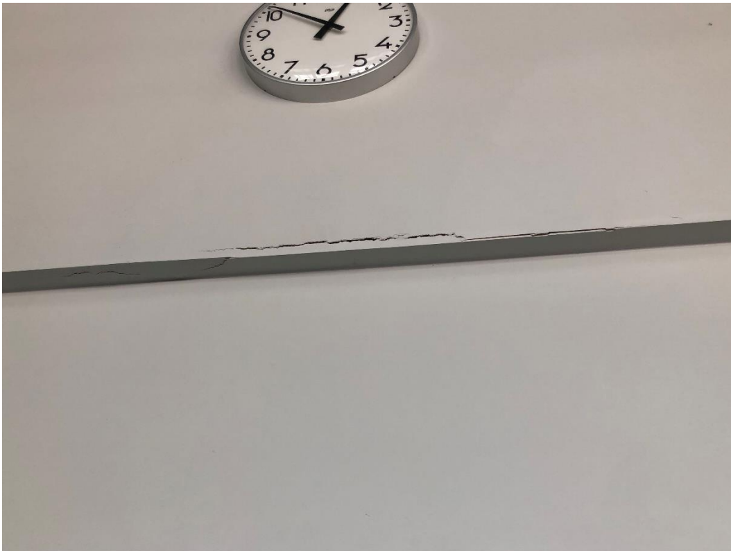
Kuva 19. Teknisen työn luokan seinässä havaittiin halkeama.
